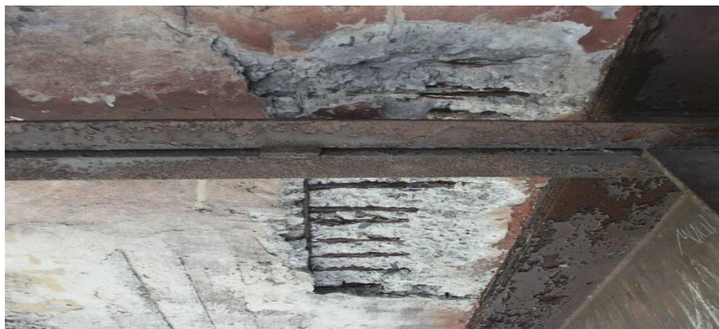
Рисунок 1.4 – Повреждение сталежелезобетонного пролетного строения моста в условиях эксплуатации
