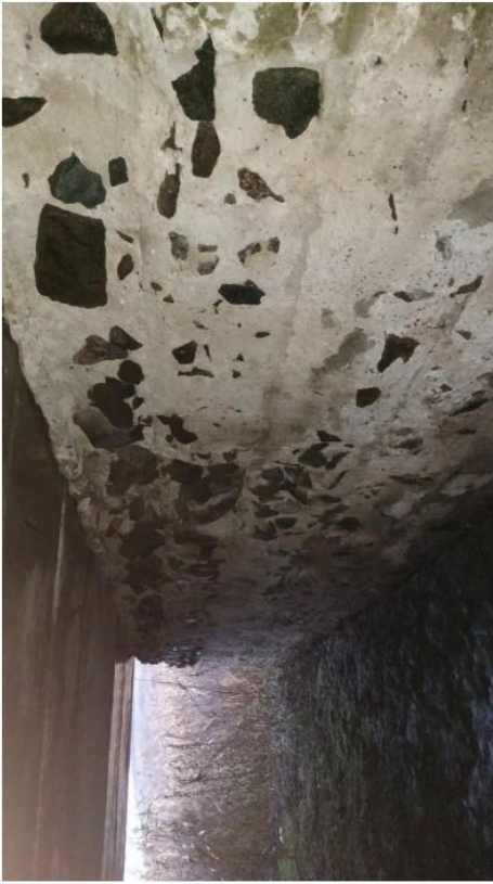
Фото И.23 – Виколи окремих бутових каменів опорних конструкцій моста, систематичне замокання плит
