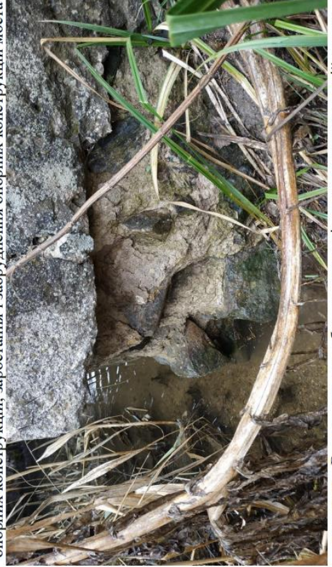
Фото И.13 – Викколи окремих буттових каменів опорних конструкцій моста
