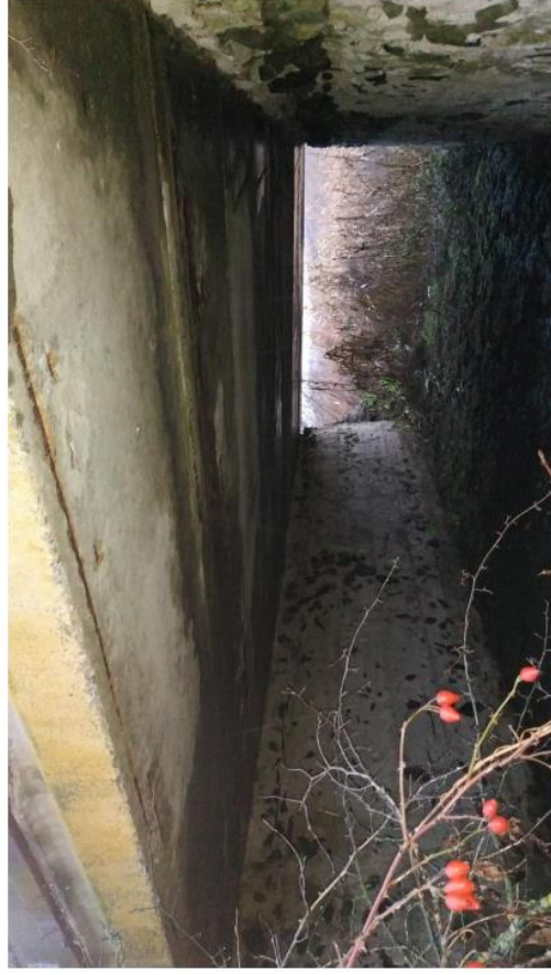
Фото И.21 – Виколи окремих бутових каменів опорних конструкцій моста, вимивання розчину буттового мурування опорних конструкцій моста, систематичне замокання плит
