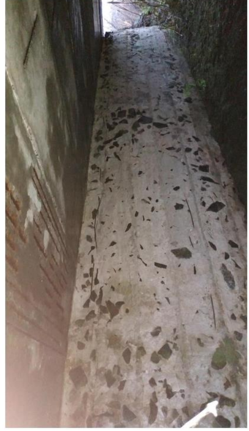
Фото И.22 – Виколи окремих бутових каменів опорних конструкцій моста, вимивання розчину буттового мурування опорних конструкцій моста, оголення і корозія арматурних стержнів з виколами бетону
