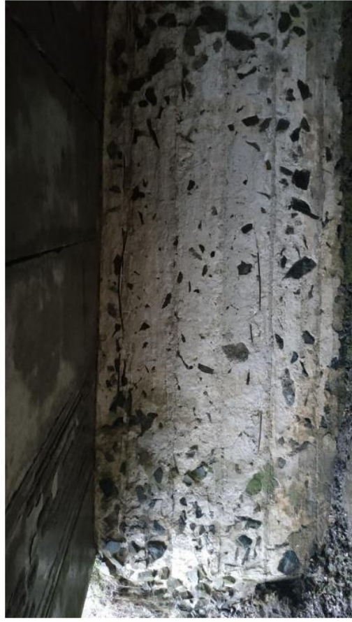
Фото И.26 – Виколи окремих бутових каменів опорних конструкцій моста, вимивання розчину бутового мурування опорних конструкцій моста, оголення і корозія арматурних стержнів з виколами бетону
