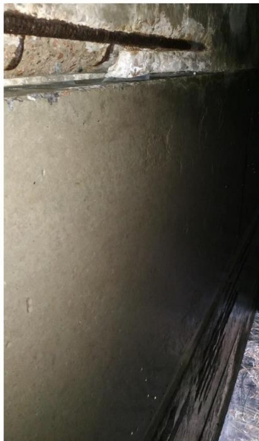
Фото И.31 – Систематичне замокання плит, оголення і корозія арматурних стержнів з виколами бетону і виключенням з роботи окремих стрижнів нижнього армування
