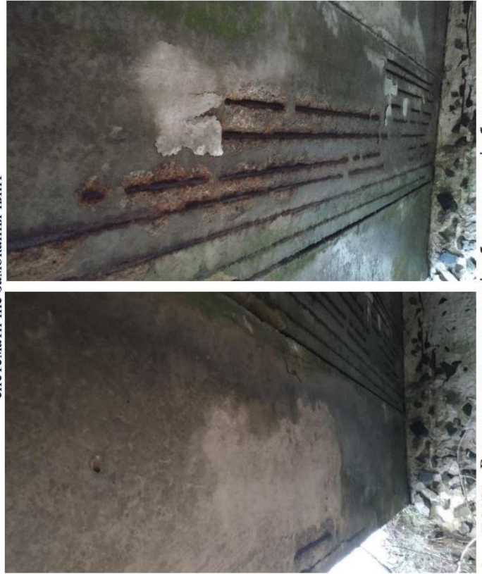
Фото И.24/25 – Вимивання розчину вузлів обпирання залізобетонних плит на опорні конструкції моста, систематичне замокання плит, оголення і корозія арматурних стержнів з виколами бетону
