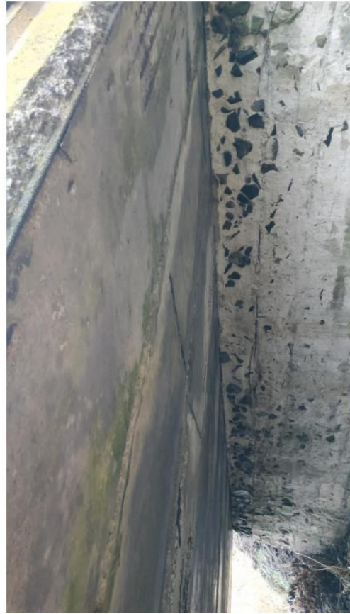
Фото И.15 – виколи бетону відбійних плит та окремих буттових каменів опорних конструкцій, вимивання розчину вузлів обпірання залізобетонних плит на опорні конструкції моста, прогини окремих залізобетонних плит
