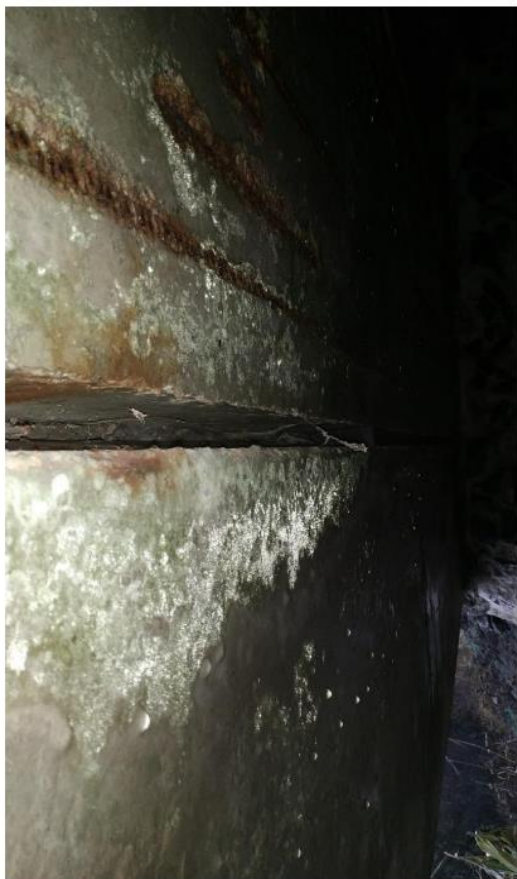
Фото И.30 – Систематичне замокання плит, оголення і корозія арматурних стержнів з виколами бетону
