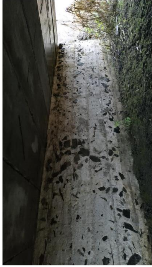
Фото И.27 – Виколи окремих бутових каменів опорних конструкцій моста, вимивання розчину бутового мурування опорних конструкцій моста, систематичне замокання плит
