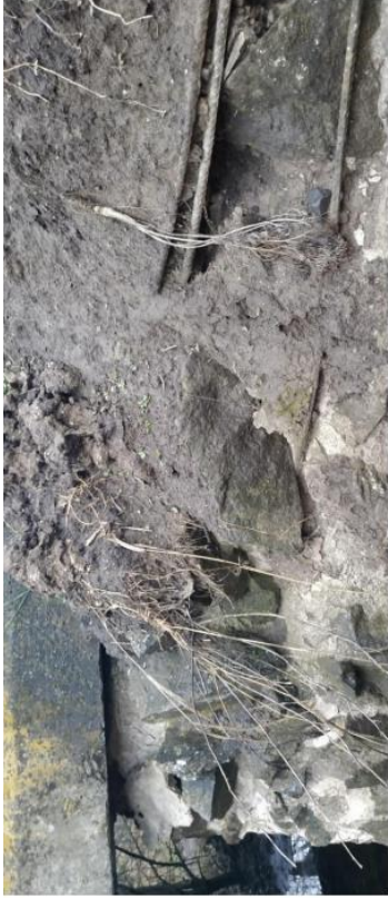
Фото И.6 – Виколи окремих бугових каменів опорних конструкцій, вимивання розчину бугового мурування опорних конструкцій моста, відсутність спільної роботи арматурних стержнів які стягають бугову кладку
