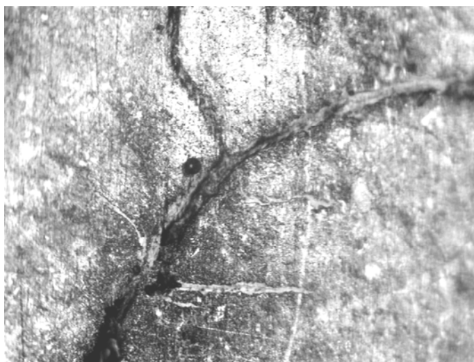
Рисунок 5.3 – Тріщина з виходом на поверхню кочення колеса повністю заповнена окислами металу. Збільшення 200.
