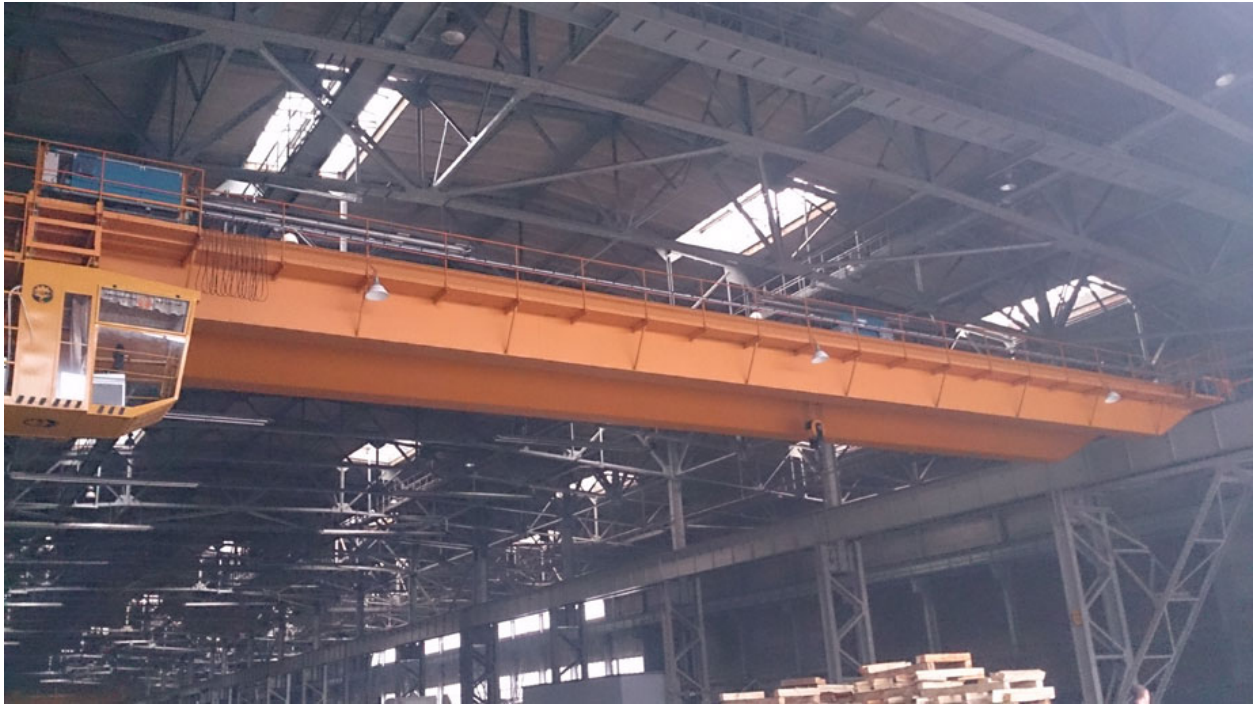
Рис. 3. Загальний вигляд двобалкового мостового крана.
