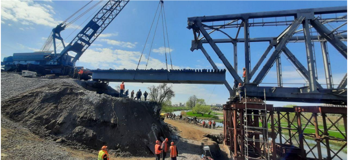
Рисунок 1.7. Використання пошкодженої металевої конструкції (ферми) (із звіту, 2022)
