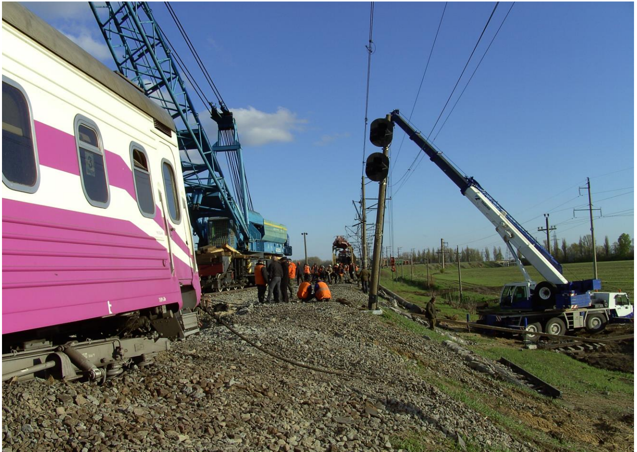
Рисунок 2.1 - Ліквідація наслідків сходження з рейок пасажирського поїзда Дніпропетровськ-Київ на станції Росава ПЗЗ Південно-Західної залізниці відновлювальними поїздами Фастів і Дарниця Південно-Західної залізниці
