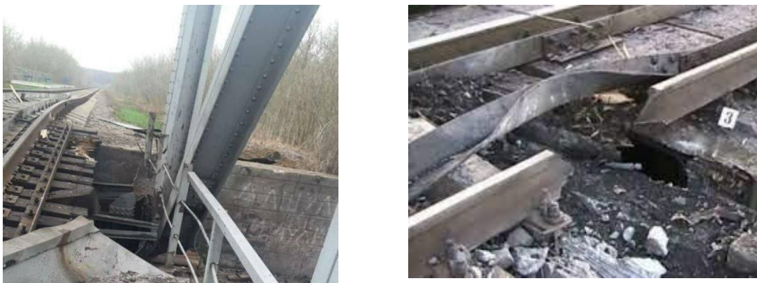
Рисунок 1.2 – Зруйновані ділянки залізниці
