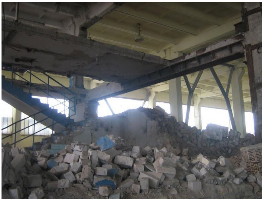
Рис. 1.1. Стан будівлі багажного відділення, корпус «В» Філії «Пасажирська компанія» АТ «Укрзалізниця»
