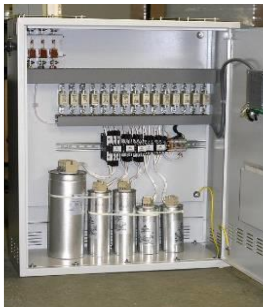
Рисунок 3.8 – Компенсатор реактивної потужності з конденсаторними батареями
