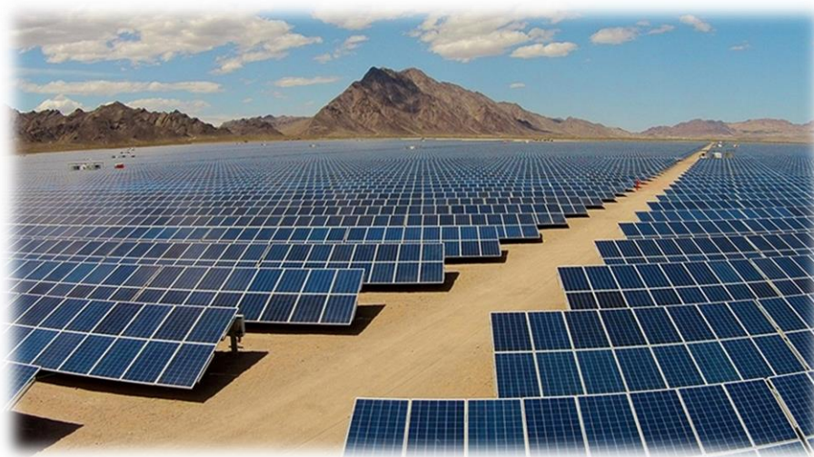
Рисунок 2.8 – Сонячна електростанція на фотоелектричних елементах
