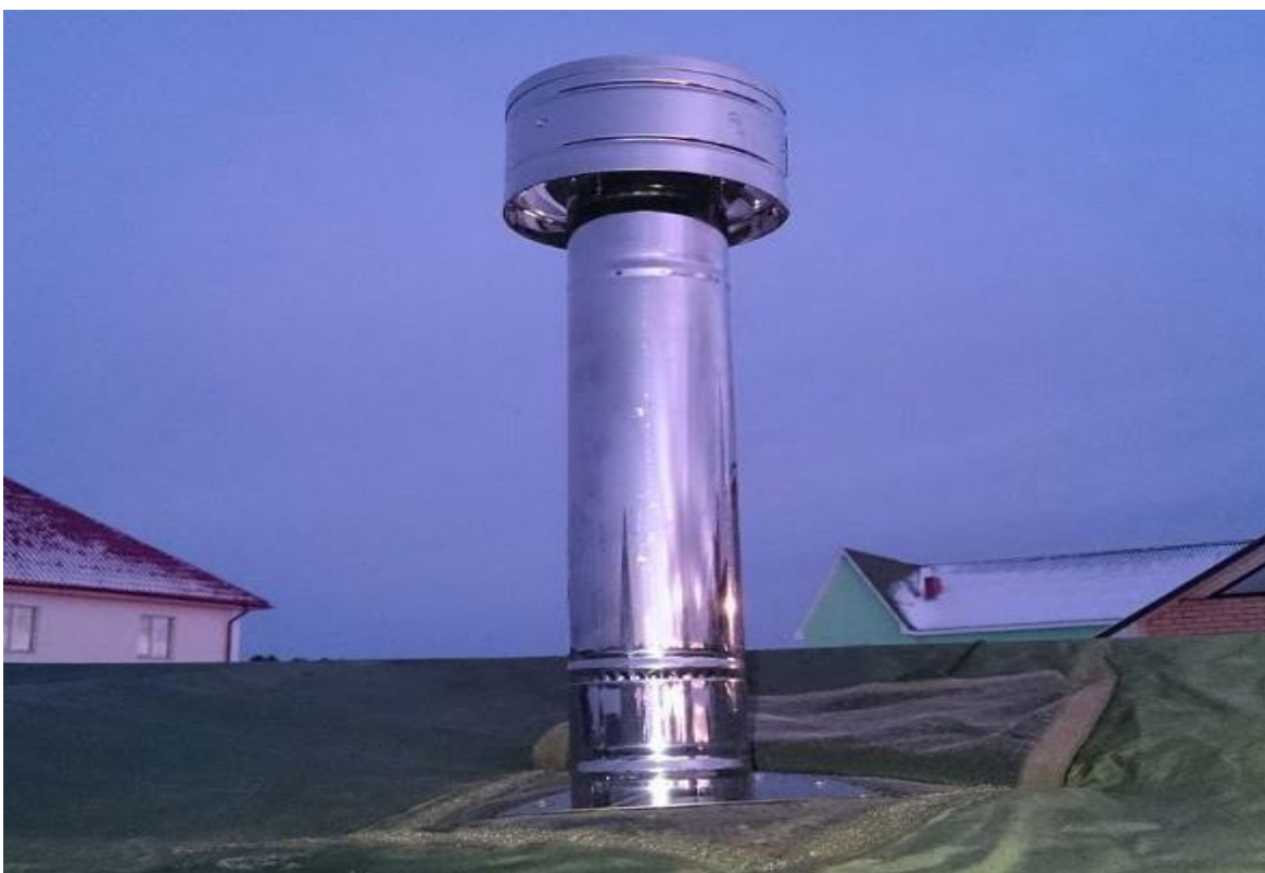
Рис.4. Загальний вигляд витяжного дефлектора.
