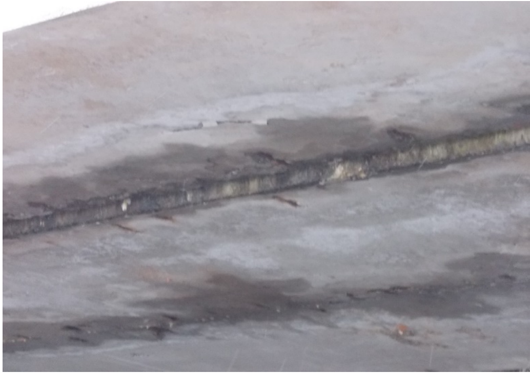
Рисунок 9. Фрагмент прогонової будови 1-2. Вилуговування бетону, висоли, не достатній захисний шар, відшарування захисного шару, оголена арматура, корозія арматури, протікання води на прогонову будову
