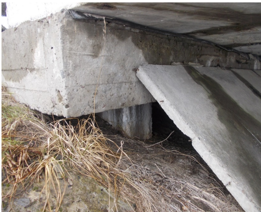
Рисунок 19. Фрагмент опори №3. Просідання конуса, руйнування укріплення конуса, вилуговування бетону, висоли, раковини, відсутні упори, протікання води на опорі
