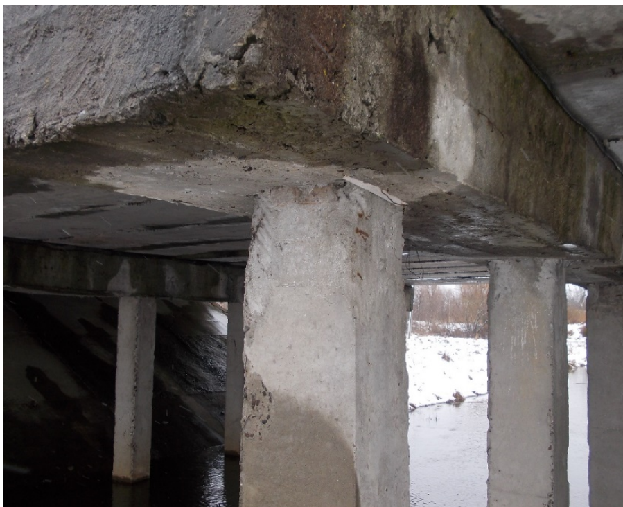
Рисунок 17. Фрагмент опори №2. Вилуговування бетону, висоли, раковини, порушена вертикальність палів, протікання води на опорі
