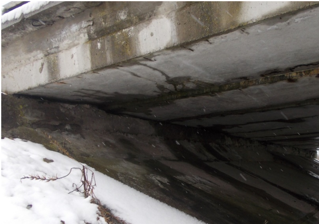
Рисунок 13. Опора №0. Руйнування укріплення конуса, вилуговування бетону, висоли, протікання води на опорі
