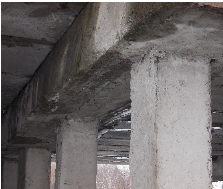
Рисунок 15. Фрагмент опори №1. Вилуговування бетону, висоли, протікання води на конструкції опори
