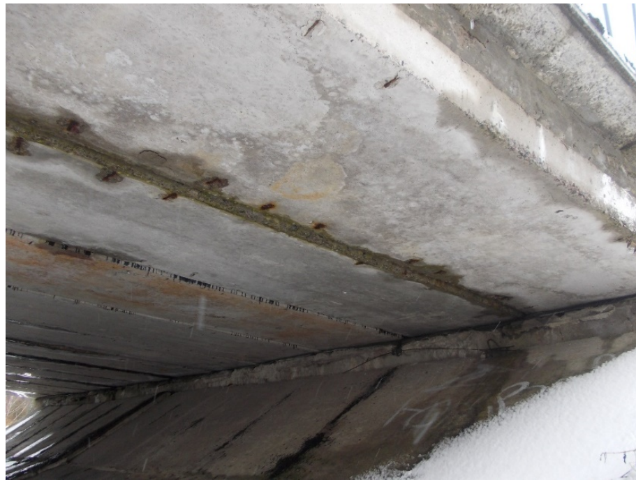
Рисунок 10. Прогонова будова 2-3. Вилуговування бетону, висоли, не достатній захисний шар, відшарування захисного шару, оголена арматура, корозія арматури, протікання бітуму, протікання води на прогонову будову
