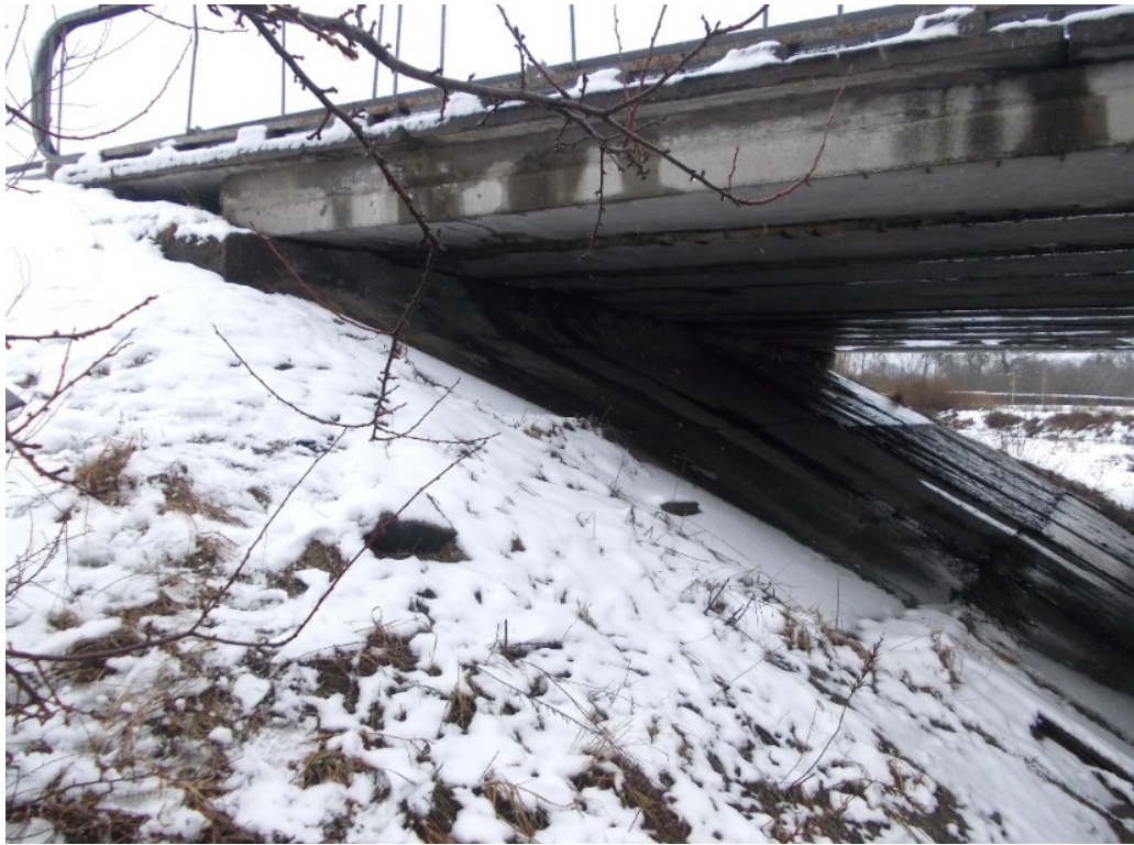
Рисунок 12. Опора №0. Руйнування укріплення конуса , вилуговування бетону, висоли, відсутні упори, протікання води на опорі
