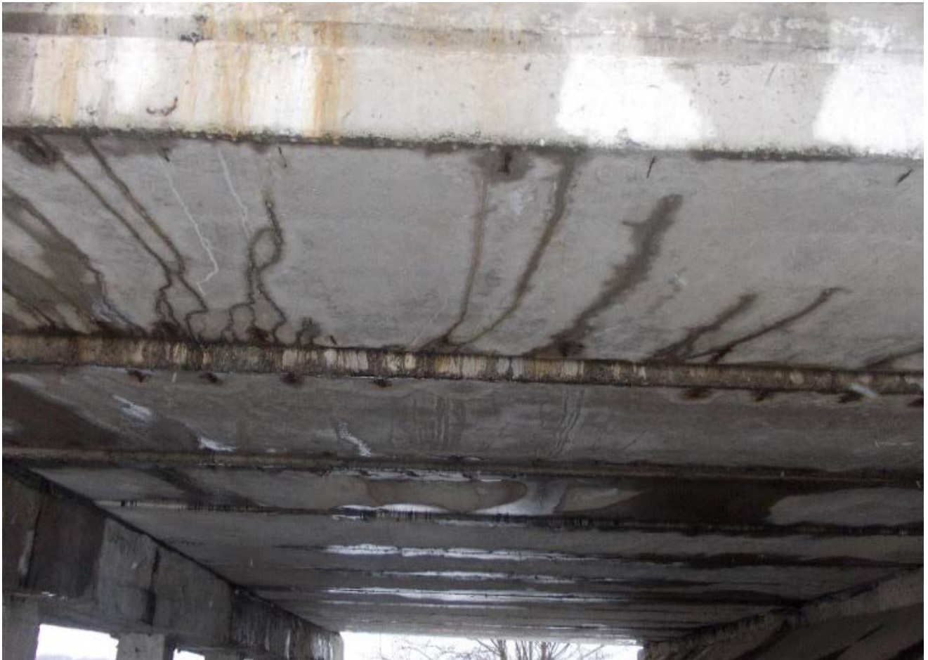
Рисунок 6. Прогонова будова 0-1. Вилуговування бетону, висоли, не достатній захисний шар, відшарування захисного шару, оголена арматура, корозія арматури, протікання води на прогонову будову
