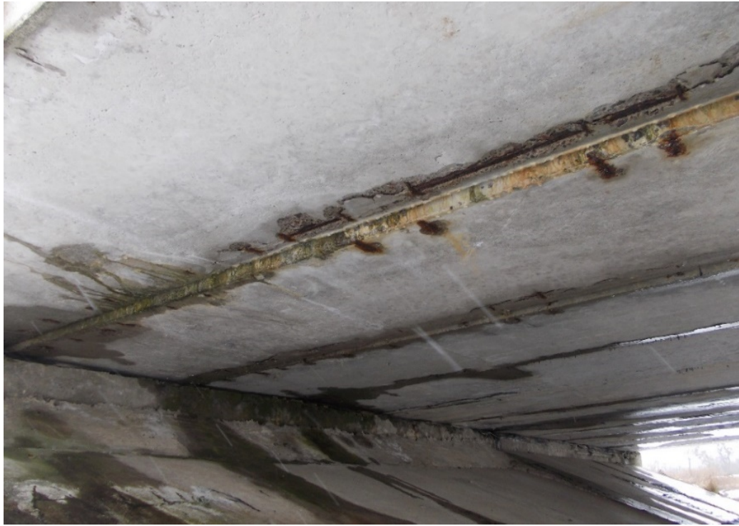
Рисунок 7. Прогонова будова 0-1. Вилуговування бетону, висоли, не достатній захисний шар, відшарування захисного шару, оголена арматура, корозія арматури, протікання води на прогонову будову
