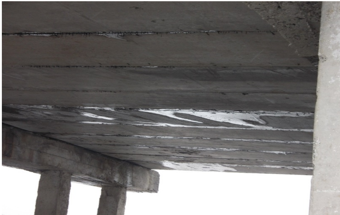
Рисунок 8. Прогонова будова 1-2. Вилуговування бетону, висоли, не достатній захисний шар, відшарування захисного шару, оголена арматура, корозія арматури, протікання води на прогонову будову
