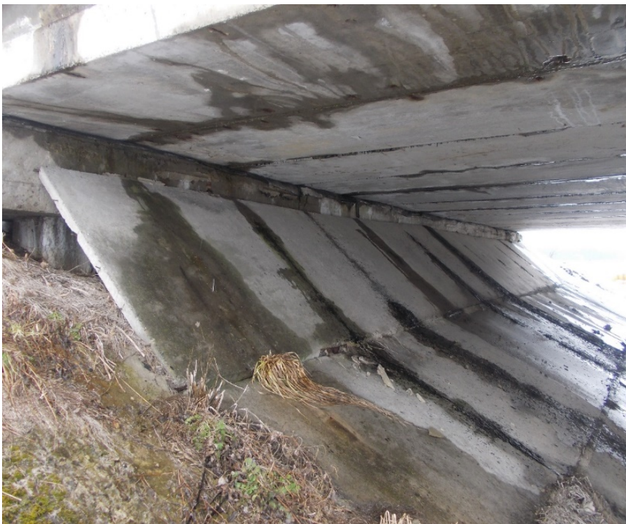
Рисунок 18. Опора №3. Просідання конуса, руйнування укріплення конуса, вилуговування бетону, висоли, відсутні упори, протікання води на опорі
