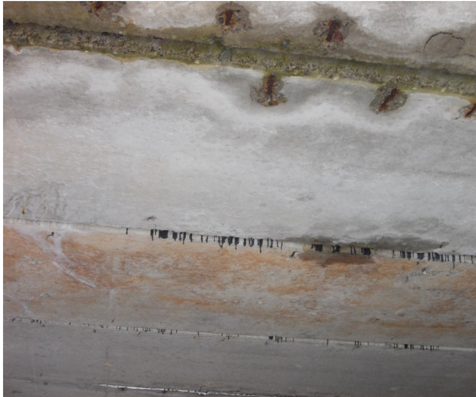
Рисунок 11. Фрагмент прогонової будови 2-3. Вилуговування бетону, висоли, не достатній захисний шар, відшарування захисного шару, оголена арматура, корозія арматури, протікання бітуму, протікання води на прогонову будову
