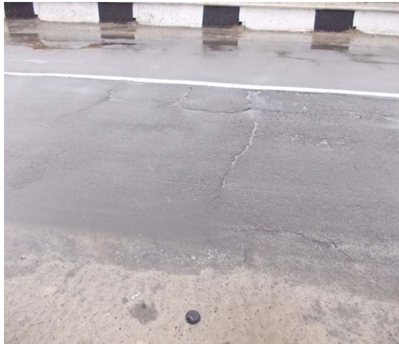
Рисунок 3. Мостове полотно. Тріщини, бруд на мостовому полотні
