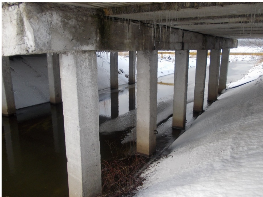
Рисунок 14. Опора №1. Вилуговування бетону, висоли, відсутні упори, порушена вертикальність палів
