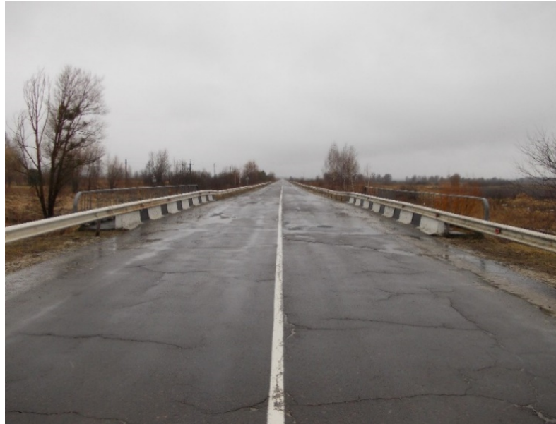
Рисунок 2. Мостове полотно. Деформаційні шви закриті без армування покриття, гідроізоляція зруйнована, тріщини.
