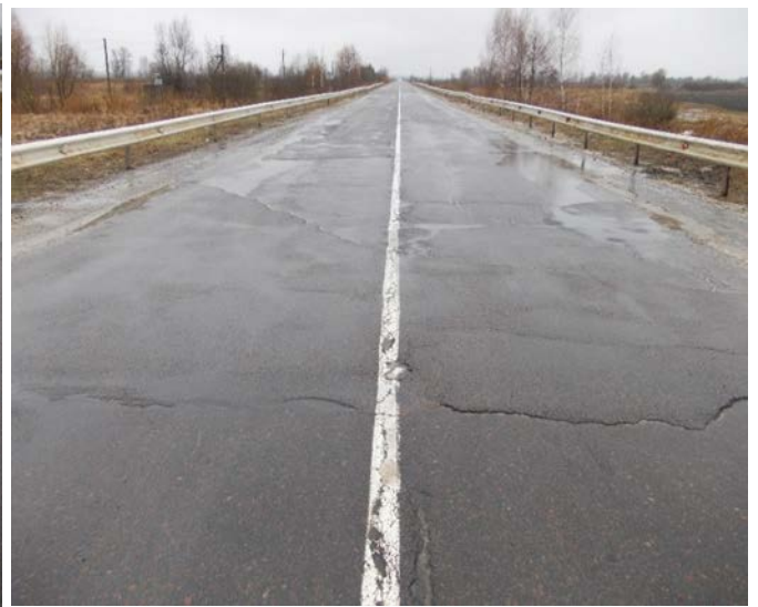
Рисунок 21. З'їзд з моста. Тріщини
