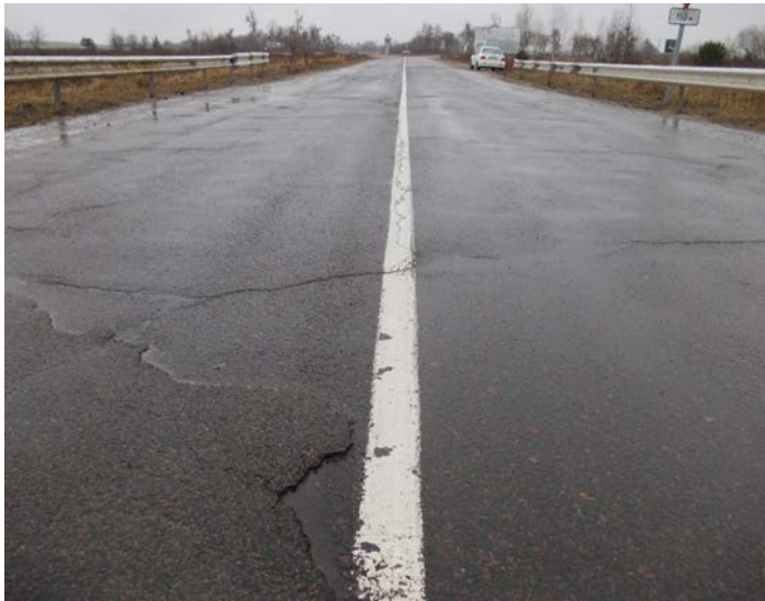
Рисунок 20. В'їзд на міст. Тріщини
