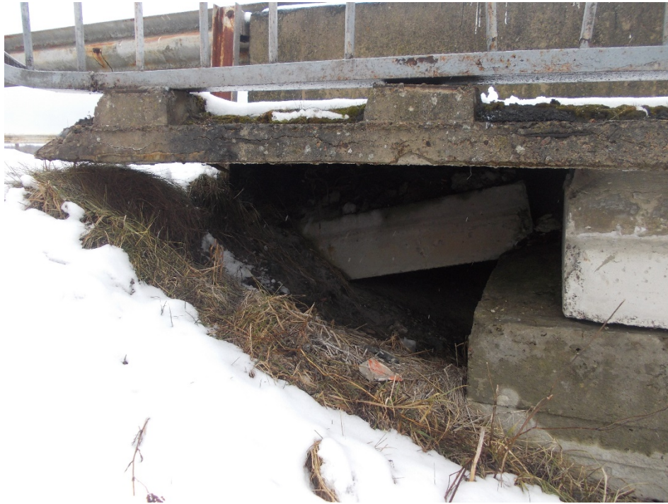
Рисунок 23. Сполучення мосту з насипом. Просідання перехідних плит, вимивання ґрунту під перехідними плитами
