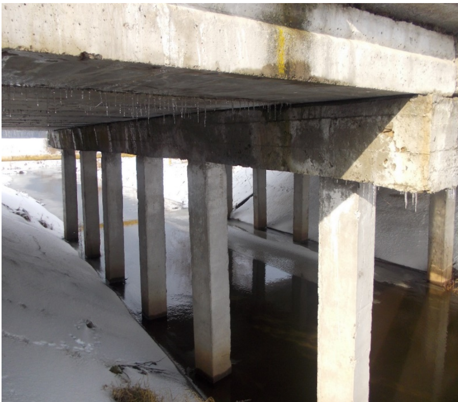
Рисунок 16. Опора №2. Вилуговування бетону, висоли, порушена вертикальність палів, відсутні упори, протікання води на опорі
