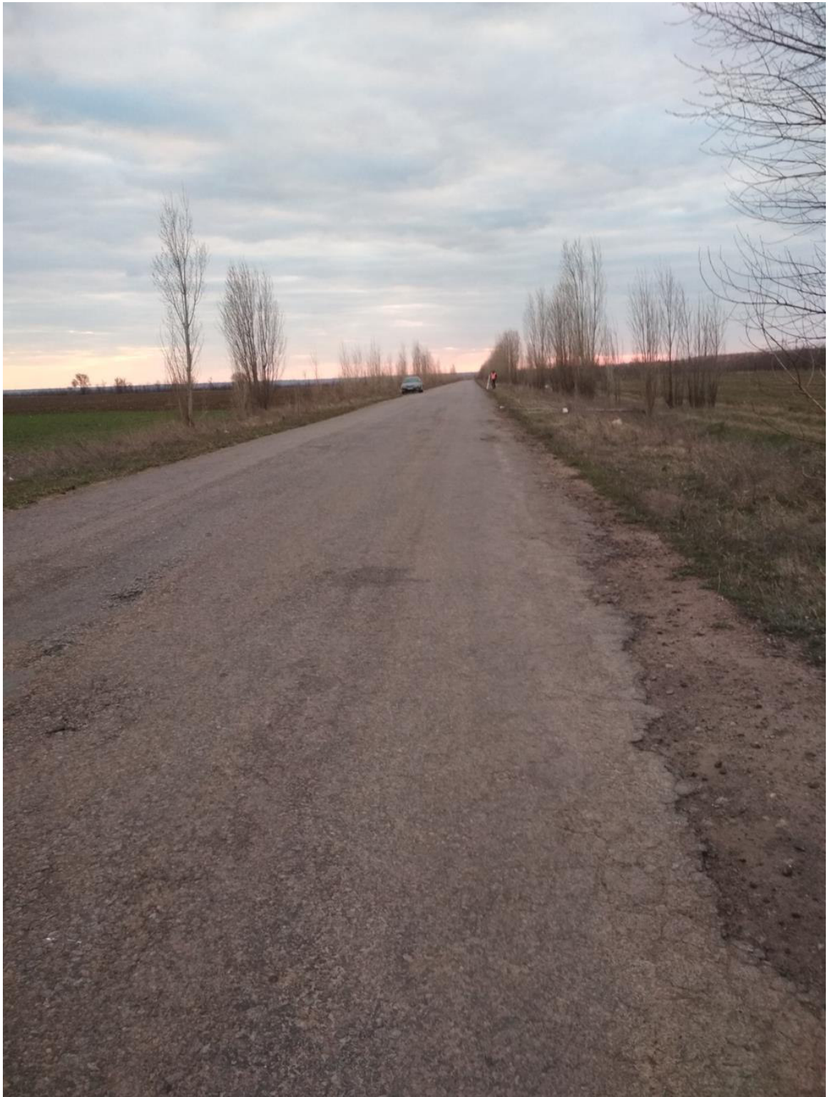
Рисунок. 2.3 – Руйнування краю асфальтобетону через відсутність бокового упору.
