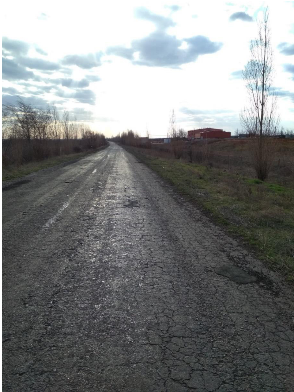
Рисунок 2.2 – Колійність в асфальтобетонному покритті внаслідок високої та інтенсивної інтенсивності руху та недостатнього опору асфальтобетону на зсув. Мережа тріщин та руйнувань на смугах відкату зумовлена недостатнім опором дорожнього одягу.
