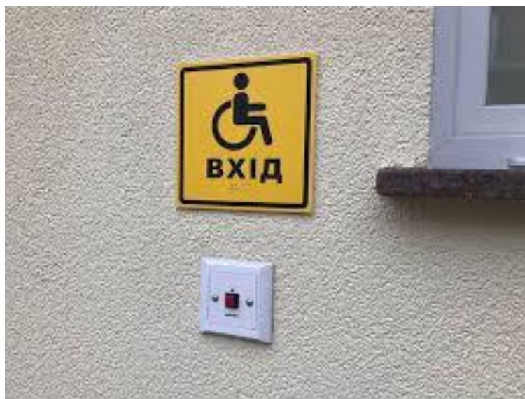
Рисунок 12. Пристрій виклику допомоги на будівлі для ЛЗОП.
