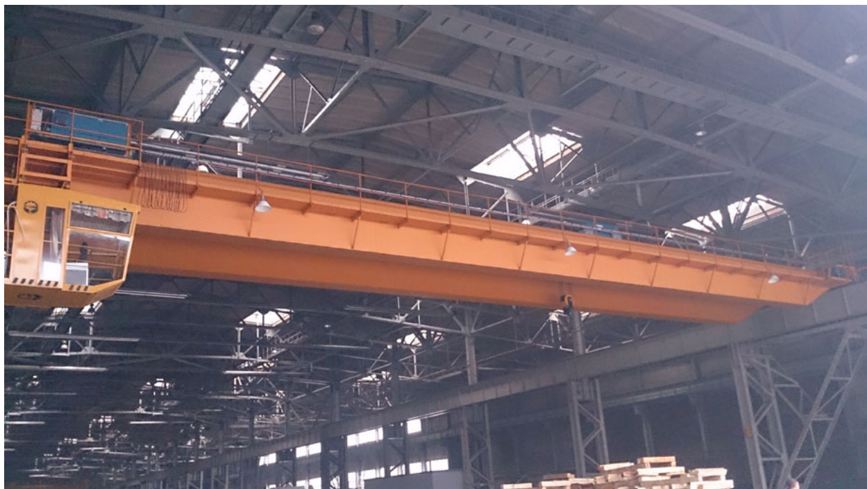
Рис. 1. Загальний вигляд мостового крана.
