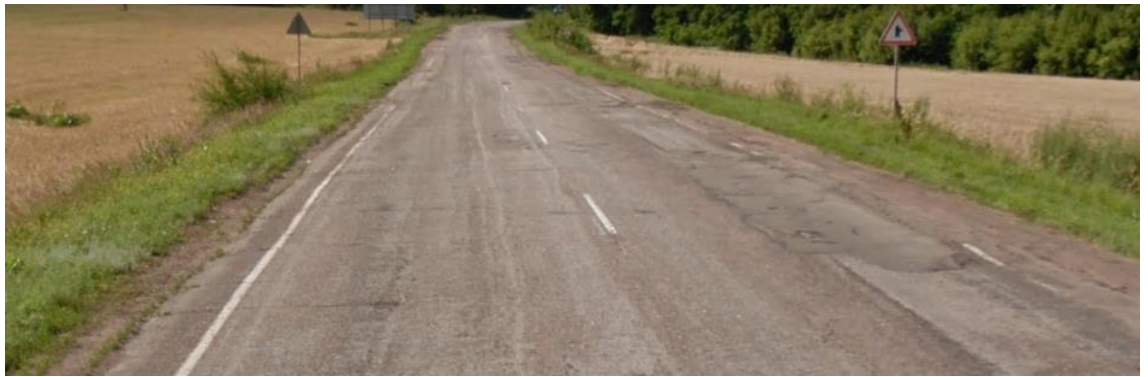
Рисунок 2.2 – Нерівності асфальтобетонного покриття, колійність, поперечні тріщини.
