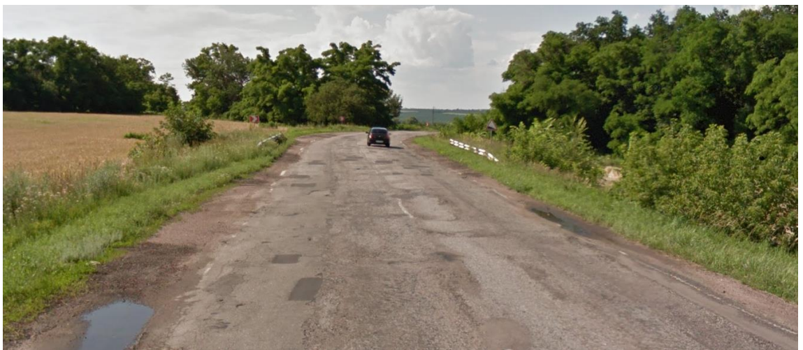
Рисунок 2.3 – Колійність асфальтобетонного покриття, руйнування кромки, вибоїни покриття, несплановані узбіччя.
