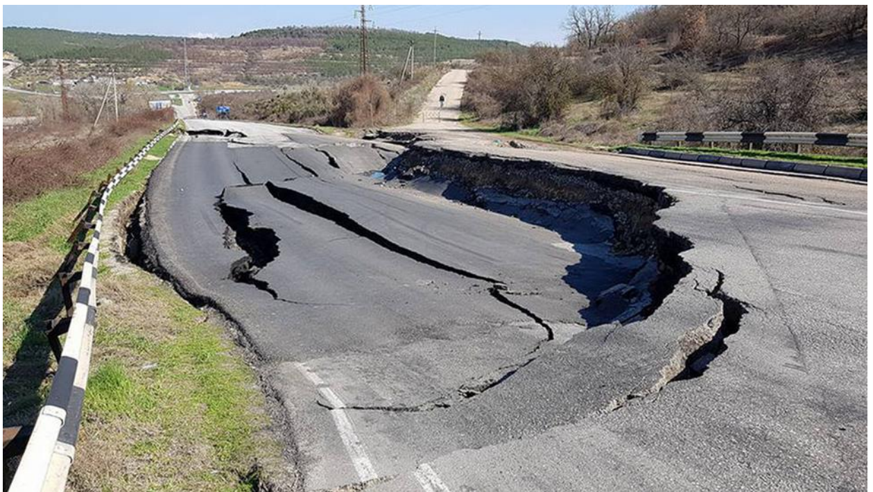
Рисунок 4.2 – Приклад обвалу ґрунту на автомобільній дорозі.
