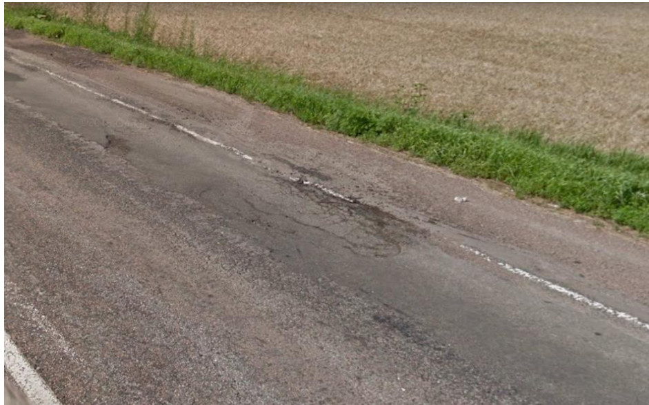
Рисунок 2.1 – Колійність асфальтобетонного покриття. Руйнування кромки асфальтобетонного покриття. Проломи по смузі накату.
