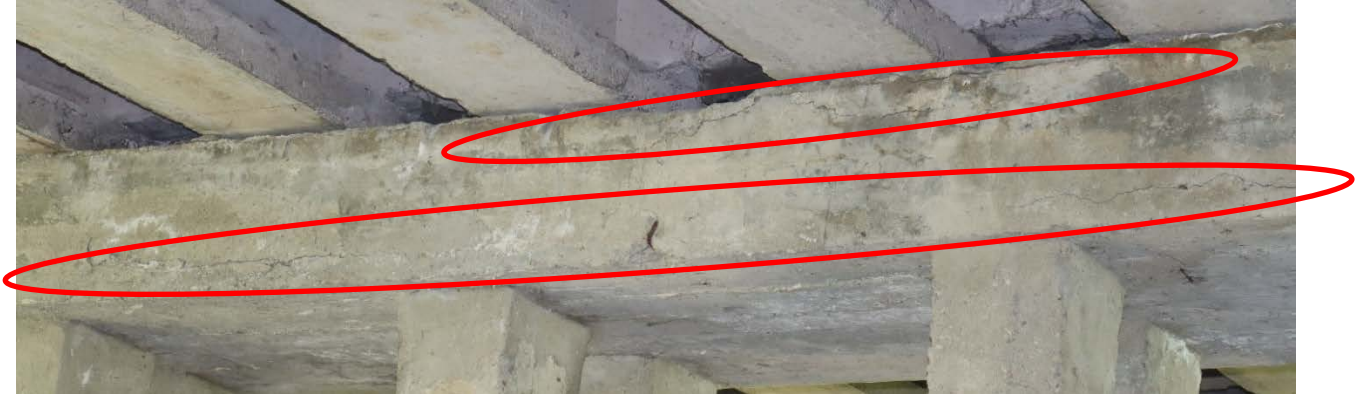
Рис. 2.21. Поздовжні тріщини по боковій поверхні ригеля вздовж робочої арматури зверху та знизу між палями П2-П5 зі сторони опори №2
