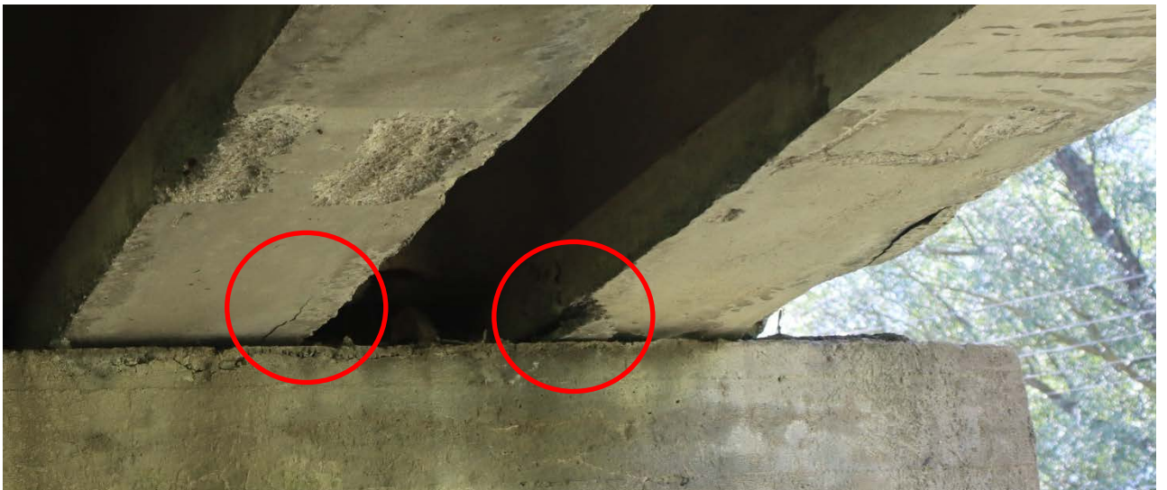
Рис. 2.9. Руйнування захисного шару бетону з оголенням та корозією арматури в місці обпирання балок Б9 та Б10 прогонової будови 0-1 на опорі №1
