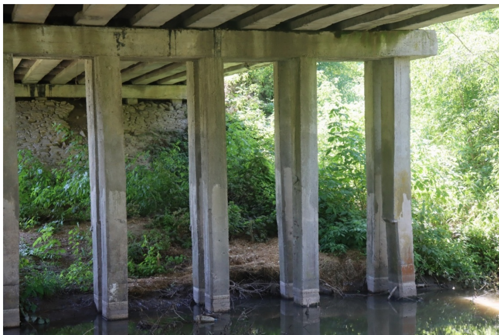
Рис. 2.25. Відхилення палі П6 першого ряду від проєктного положення Опора № 3.
