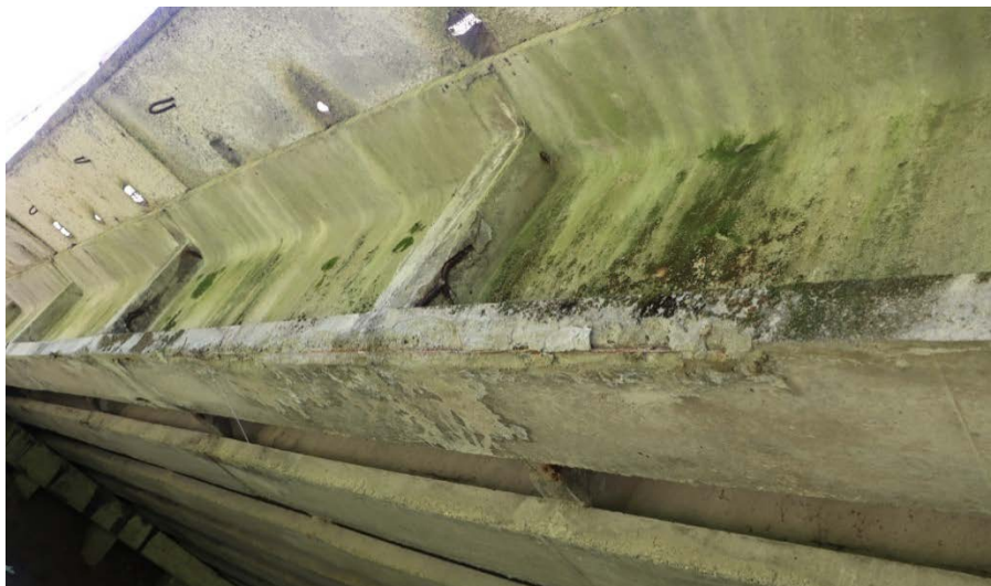
Рис. 2.2. Руйнування захисного шару бетону з оголенням і корозією арматури у діафрагмах з зовнішньої сторони балки Б10 прогонової будови 0-1
