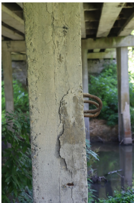
Рис. 2.16. Відшарування захисного шару бетону, вертикальна тріщина вздовж робочої арматури на всю висоту палі П5 на опорі №1 зі сторони опори №0
