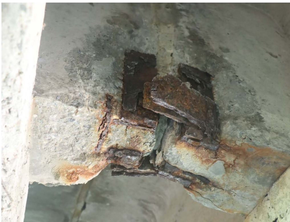
Рис. 2.5. Корозія закладних деталей та розрив накладок в об'єднаннях діафрагм Д4 між балками Б9-Б10 прогонової будови 0-1
