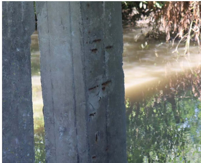
Рис. 2.24. Локальне відшарування захисного шару бетону з оголенням і корозією поперечної арматури по палям П5 першого ряду
