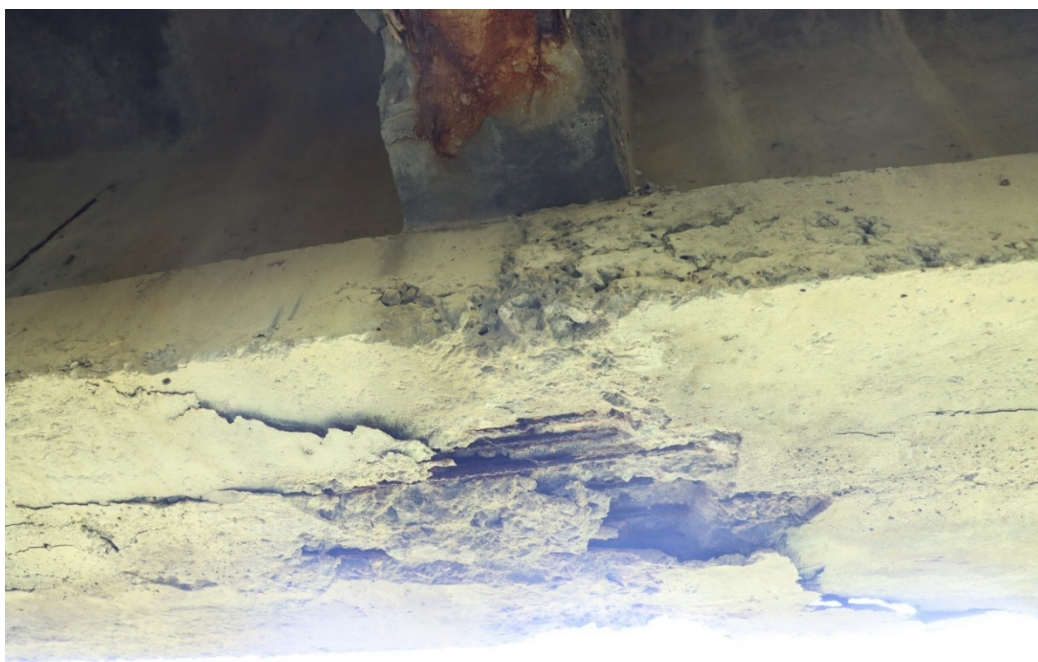
Рис. 2.11. Щербенистість, сколи і каверни в бетоні на нижньому поясі балки Б1 прогонової будови 0-1
