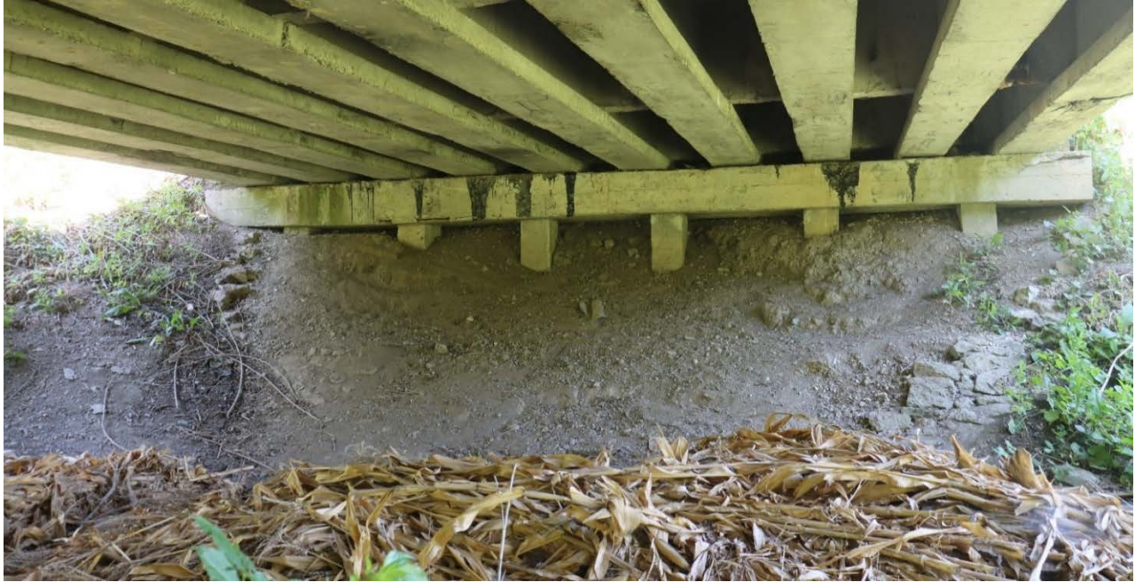
Рис. 2.36. Відсутність укріплення (мостіння) конусу насипу безпосередньо під спорудою на стояні №0
