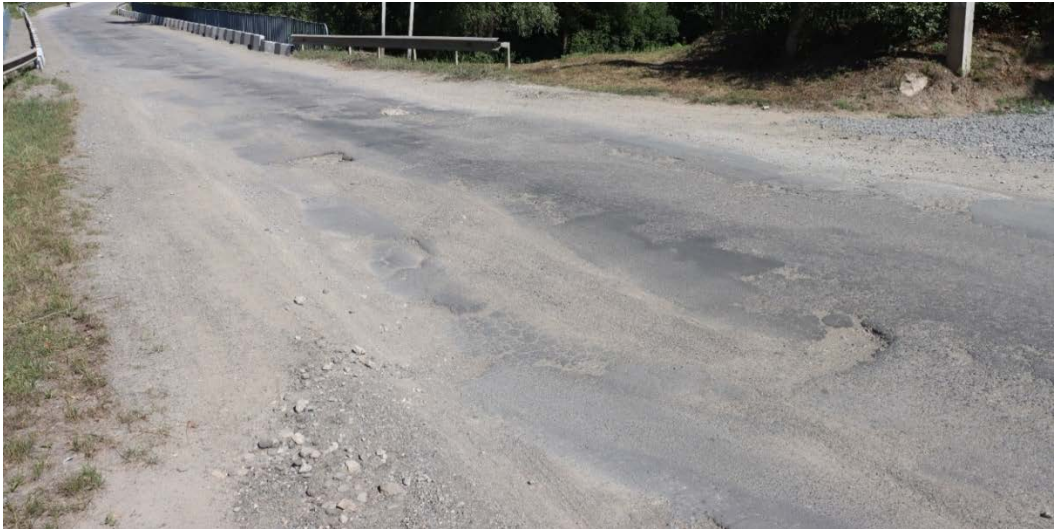
Рис 2.34. Сітка тріщин, вибоїни та ями в асфальтобетонному покритті на підходах до мосту зі сторони м. Могилів-Подільський
