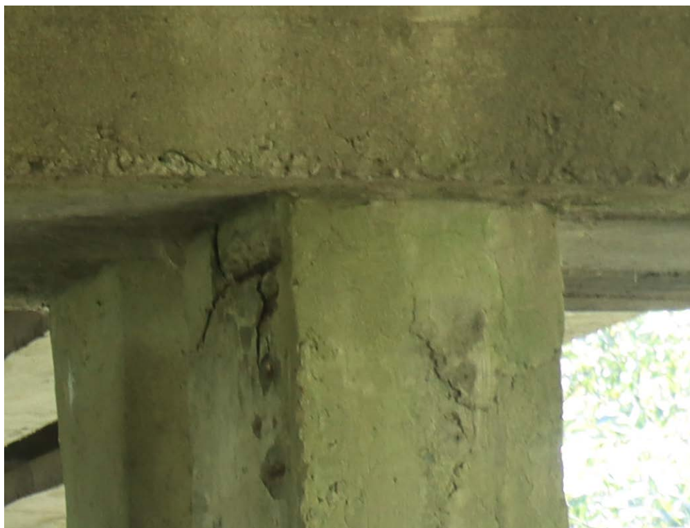
Рис. 2.18. Руйнування захисного шару бетону з оголенням та корозією арматури у палі П5 першого ряду в місці її об'єднання з ригелем
