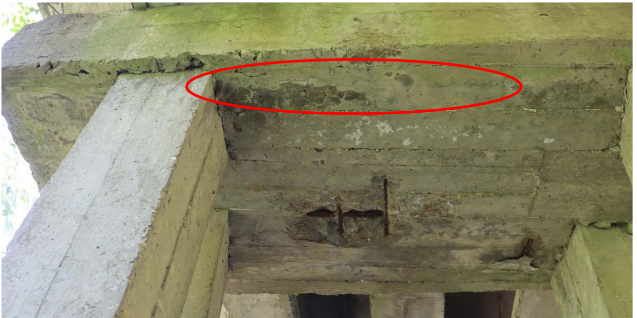
Рис. 2.22. Поздовжня тріщина по низу ригеля вздовж робочої арматури між палями П5-П6 зі сторони опори №3, руйнування захисного шару бетону з оголенням та корозією арматури до 15% перерізу по низу ригеля між палями П5-П6
