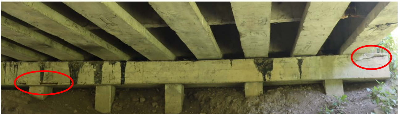
Рис. 2.14. Руйнування захисного шару бетону з оголенням та корозією арматури до 10% перерізу по поверхні ригеля зверху під балкою Б1 та над палею П5 по низу ригеля
