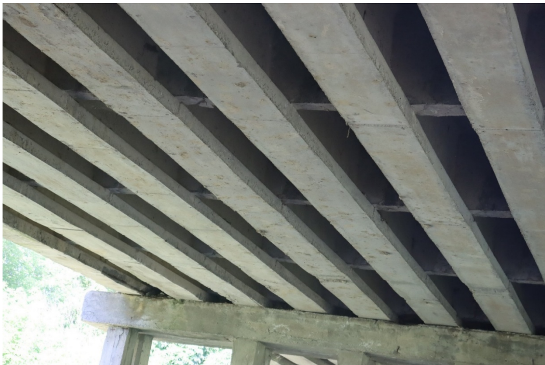
Рис. 2.10. Плями іржі по низу балок Б1-Б10 прогонової будови 1-2
