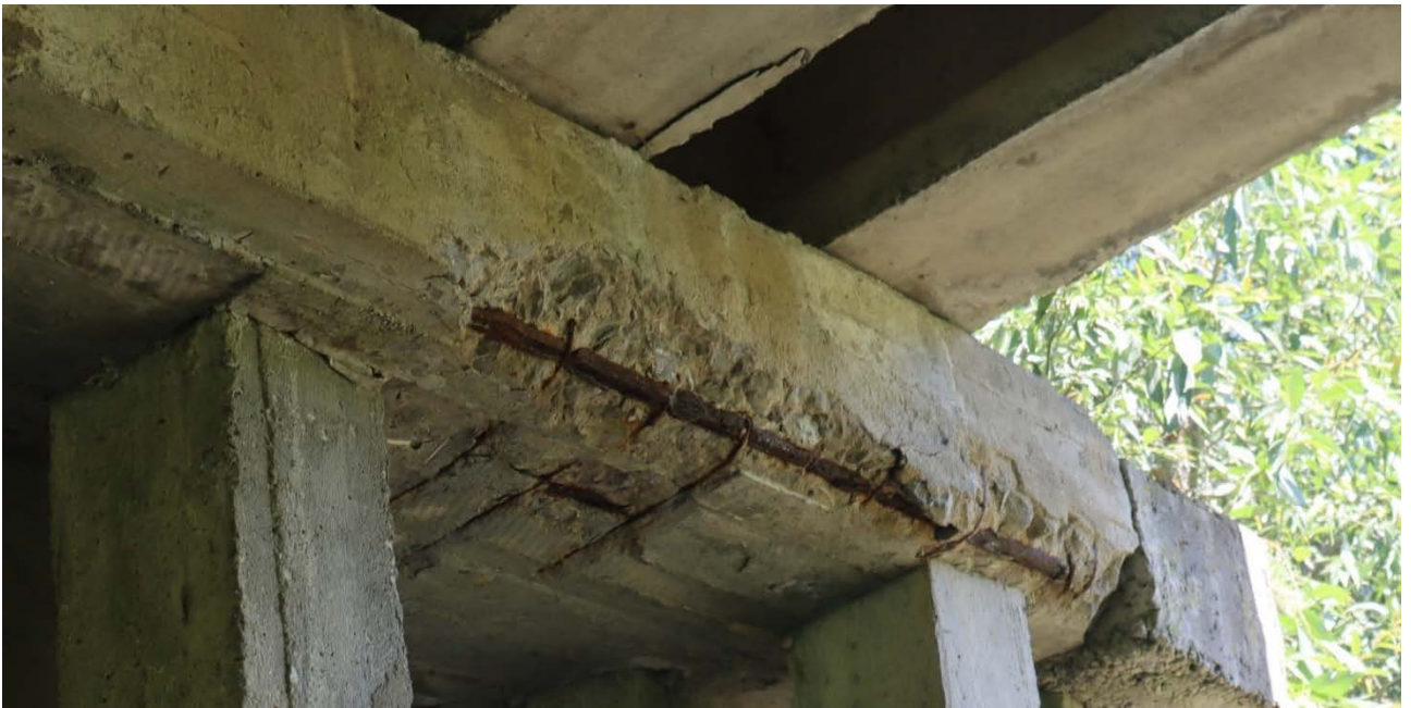
Рис. 2.23. Руйнування захисного шару бетону з оголенням та корозією арматури до 15% перерізу по низу й боковій поверхні ригеля знизу від торця до палі П2 зі сторони опори №3
