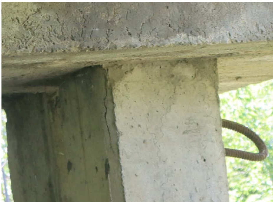
Рис. 2.17. Вертикальна тріщина вздовж робочої арматури у палі П6 першого ряду в місці її об'єднання із ригелем
