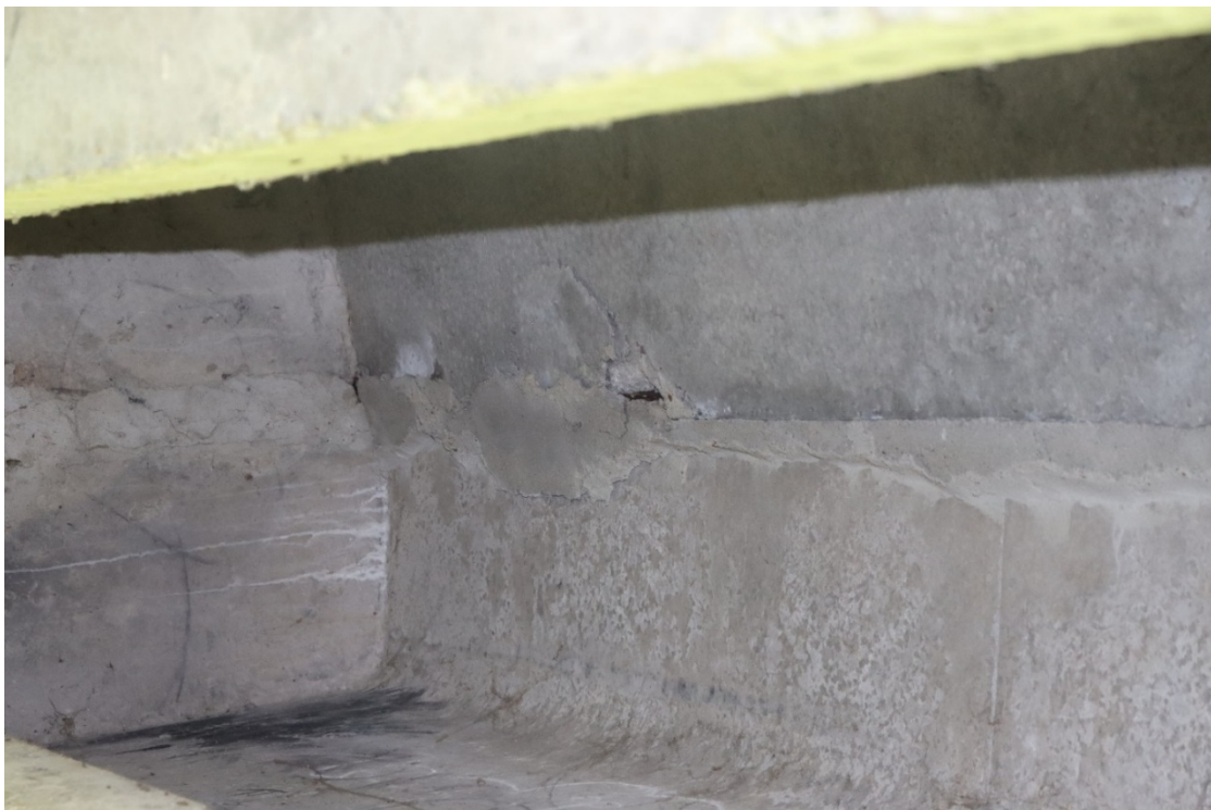
Рис. 2.4. Сліди вилугування цементного каменю між балками Б2-Б3 прогонової будови 0-1
