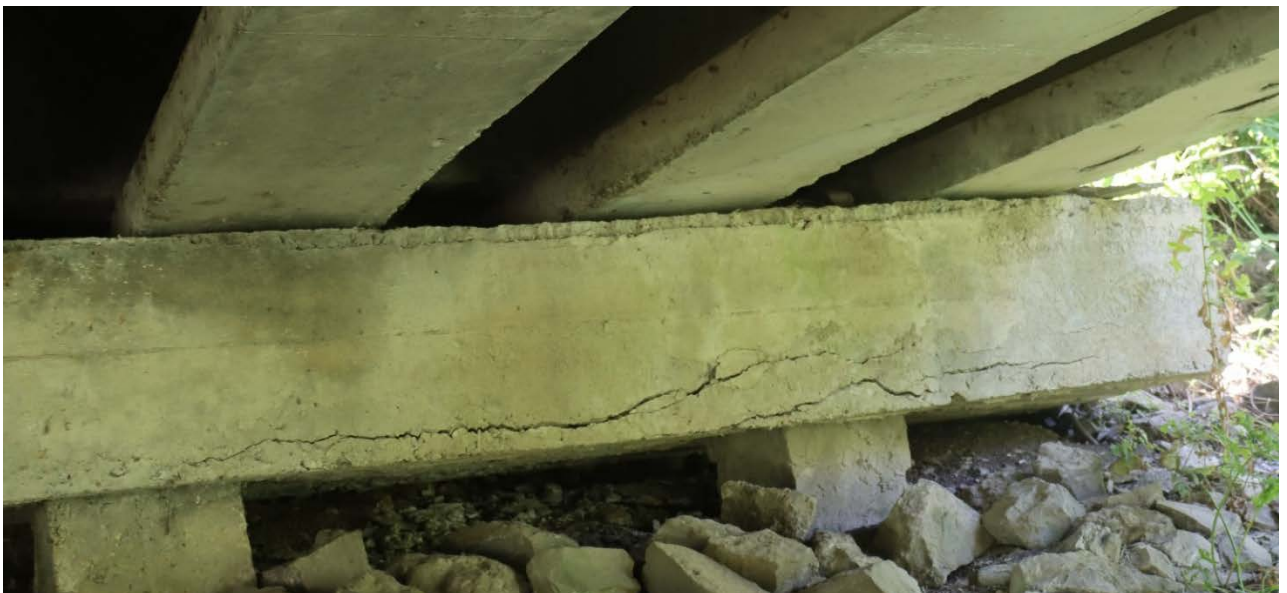
Рис. 2.29. Відшарування захисного шару бетону, поздовжні тріщини по боковій поверхні ригеля вздовж робочої арматури знизу від торця до палі П5
