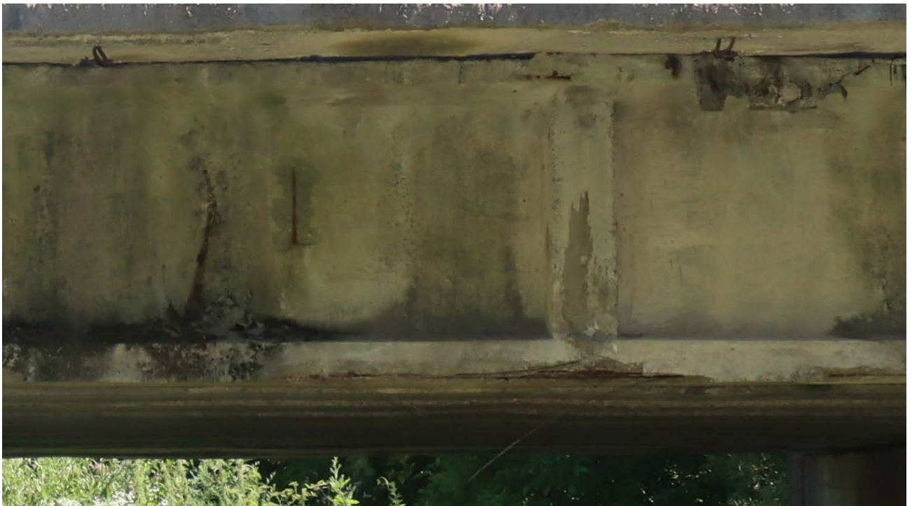
Рис. 2.1. Патьоки брудного та зеленого кольору по нижній та боковій поверхні балки Б10 прогонових будов 0-1 та 1-2, відшарування захисного шару бетону з оголенням і корозією каркасної арматури ребра балки Б10 та корозією поздовжньої арматури по низу плити проїзної частини балки, скол бетону на торцевій частині зовнішньої консолі плити балки Б10
