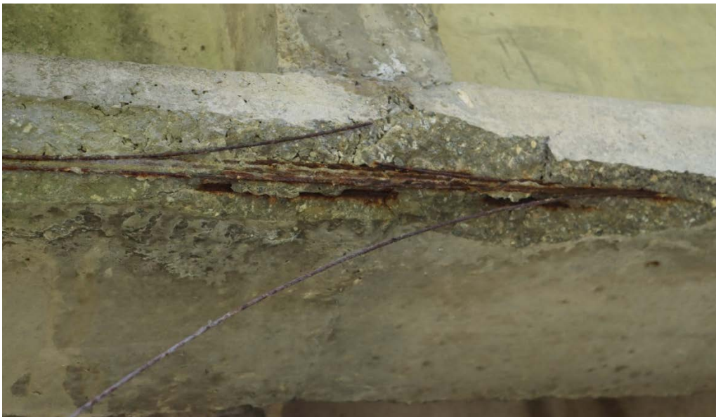
Рис. 2.7. Руйнування бетону з вивалами, оголенням, корозією, провисанням та розривом поздовжньої робочої попередньо напруженої арматури по низу ребра балки Б10 прогонової будови 0-1
