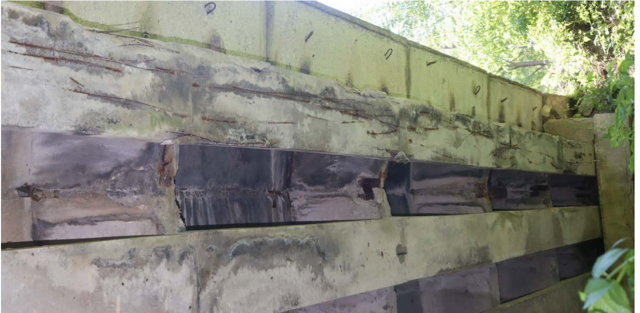
Рис. 2.8. Руйнування бетону з вивалами, оголенням, корозією, провисанням та розривом поздовжньої робочої попередньо напруженої арматури по низу ребра балки Б10 прогонової будови 2-3
