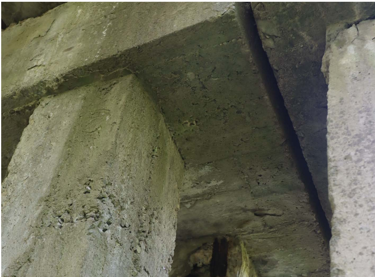
Рис. 2.12. Щербенистість бетону по нижній поверхні ригеля та локально у палі П1 на опорі №1
