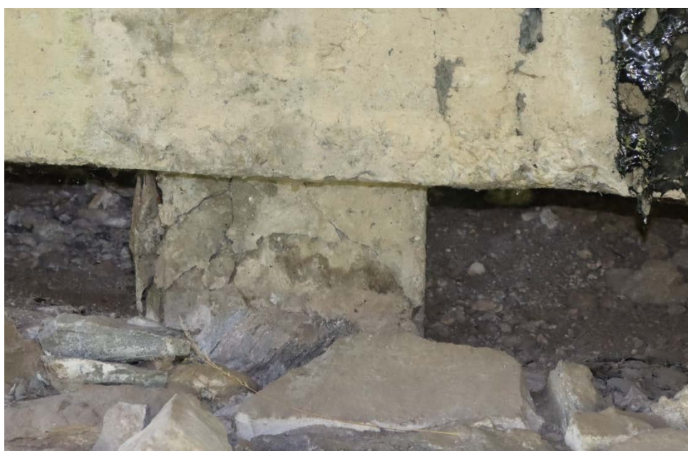
Рис. 2.26. Вертикальна тріщина, руйнування захисного шару бетону з оголенням та корозією арматури у палі П2 в місці її об'єднання із ригелем
