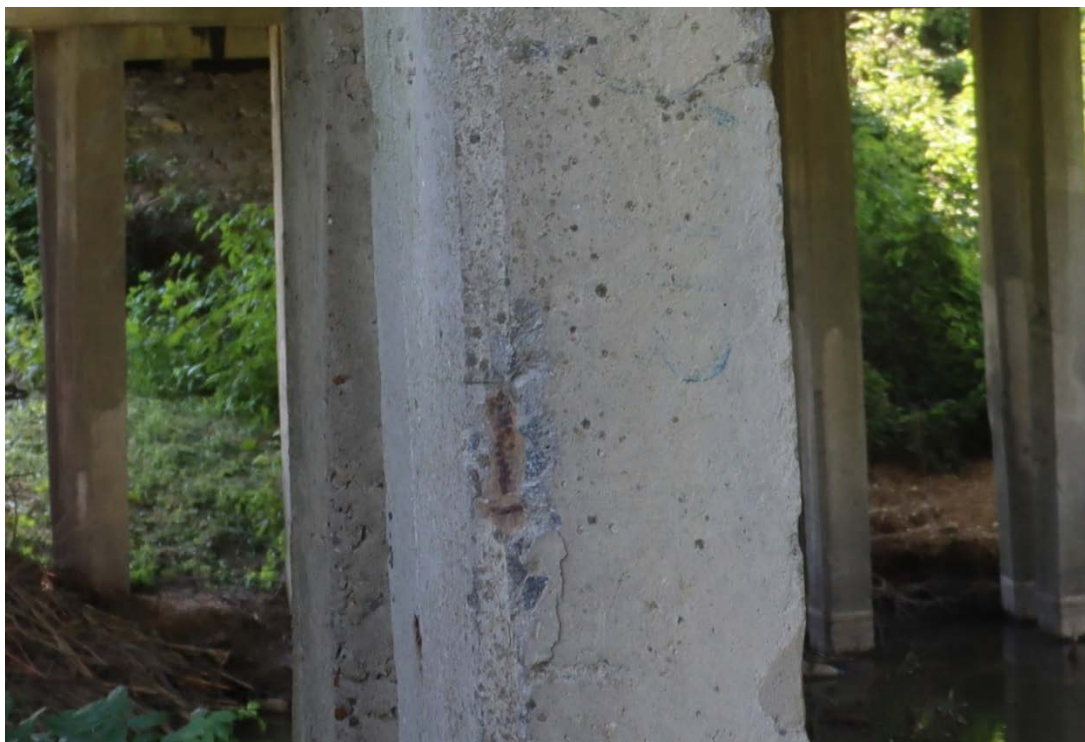
Рис. 2.20. Локальне руйнування захисного шару бетону з оголенням та корозією поздовжньої (вертикальної) арматури палі П1 у першому рядуі
