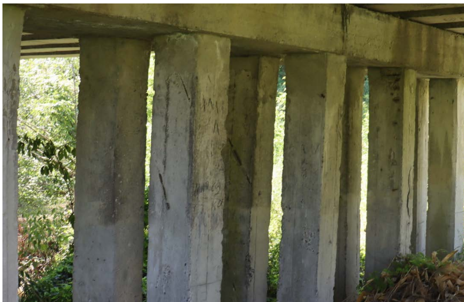
Рис. 2.19. Локальне відшарування захисного шару бетону з оголенням і корозією поперечної арматури по палям П3, П4 та П5 першого ряду та палі П4 другого ряду
