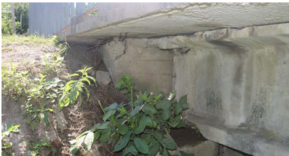
Рис. 2.30. Скол бетону на куті шафової стінки праворуч по ходу кілометражу
