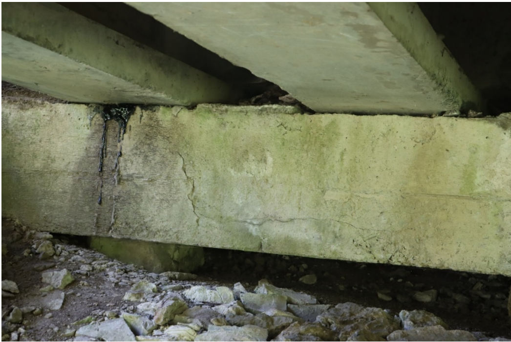
Рис. 2.27. Похила силова тріщина з переходом у горизонтальну вздовж робочої арматури ригеля під балками Б1-Б2 прогонової будови 2-3
