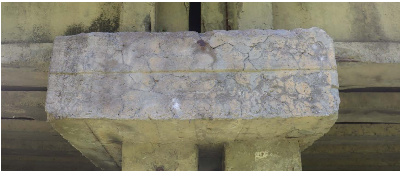
Рис. 2.15. Сітка усадочних тріщин з перевагою похилих по торцю ригеля опори №1 праворуч по ходу кілометрів
