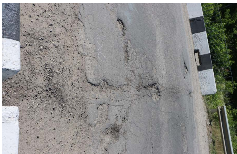
Рис. 2.33. Поперечні тріщини та руйнування асфальтобетонного покриття в місці влаштування деформаційного шва на опорі №0
