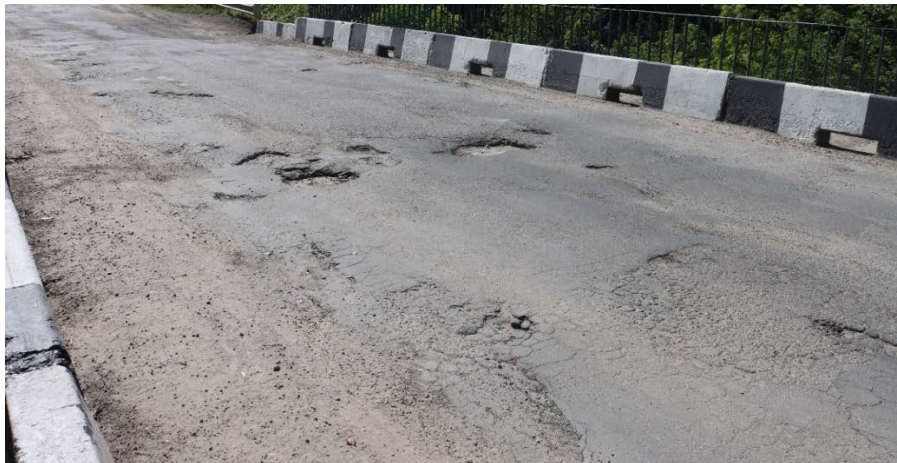
Рис. 2.32. Сітка тріщин в асфальтобетонному покритті проїзної частини мосту, вибоїни та ями в покритті глибиною до 5 см площею 20% від загальної площі проїзної частини
