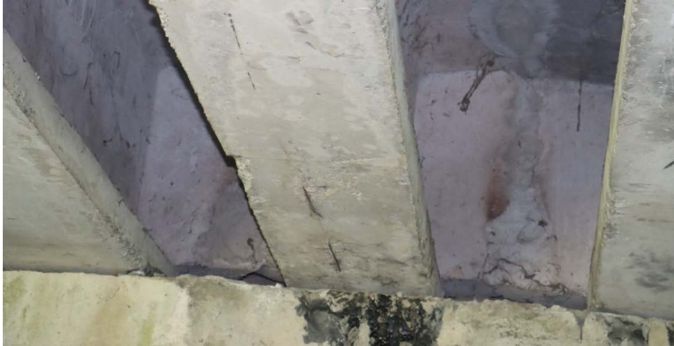
Рис. 2.6. Відшарування захисного шару бетону з оголенням і поздовжньої попередньо напруженої арматури понизу ребра балки Б3 прогонової будови 2-3
