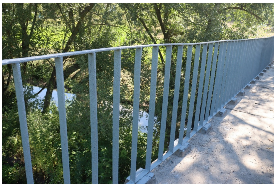
Рис. 2.31. Лущення фарби на металевій поручневій огорожі, висота огороження не відповідає чинним нормам, відсутнє покриття на пішохідних тротуарах
