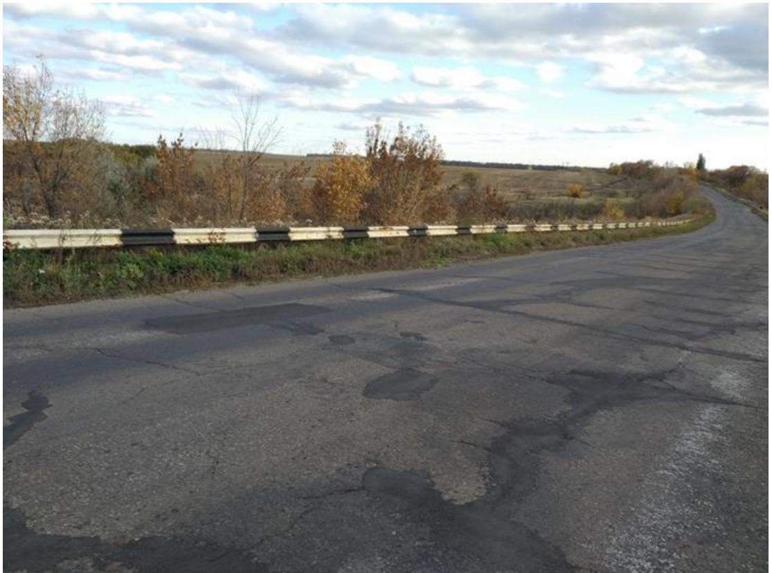
Рисунок 2.3 – Бічні тріщини спричинені старінням бітумного бетону або використанням занадто в'язкого бітуму.
