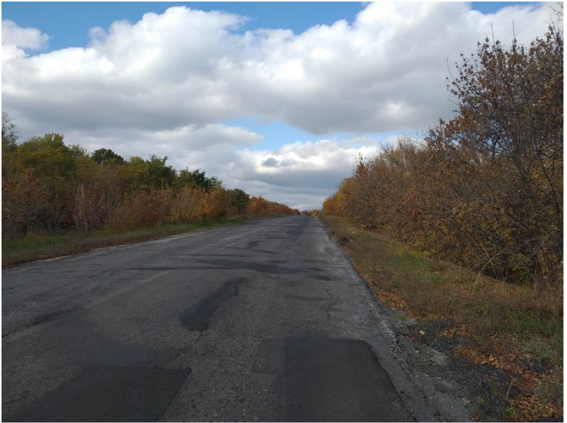
Рисунок 2.2 – Руйнування краю асфальтобетону через відсутність бічних обмежувачів.
