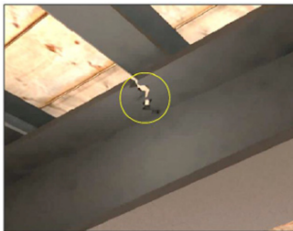
Рисунок 3.3 - Тріщини або розриви верхнього або вертикального листа поперечної балки рами
