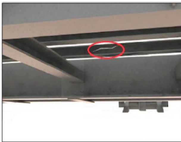
Рисунок 3.4 - Поздовжні тріщини в балках рами довжиною понад 300 мм
