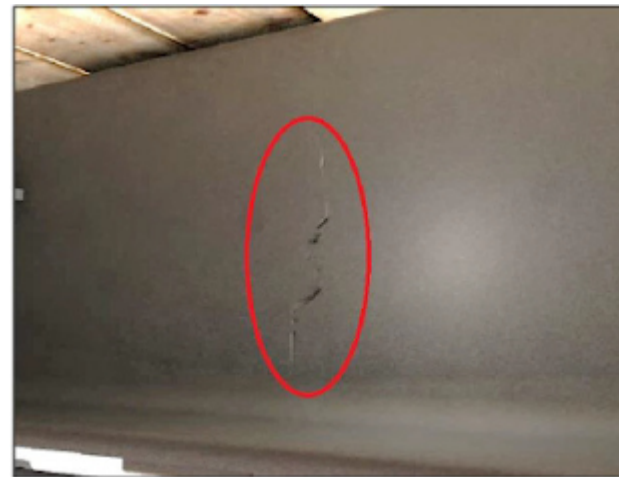
Рисунок 3.8 - Вертикальні або похилі тріщини розташовані на одній стінці балки
