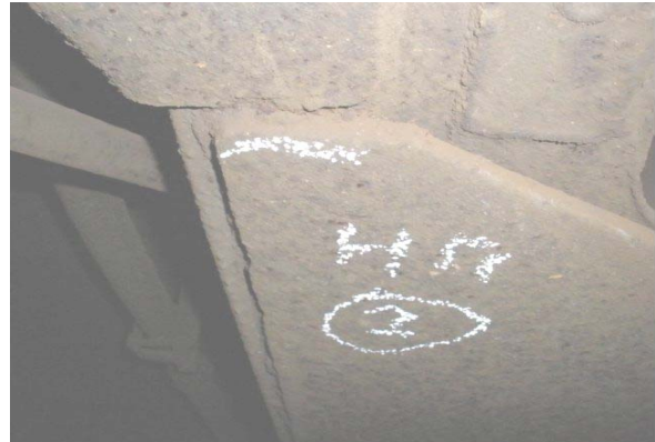
Рис. 6. Тріщини в місці з'єднання нижнього листа зі шворневою балкою
