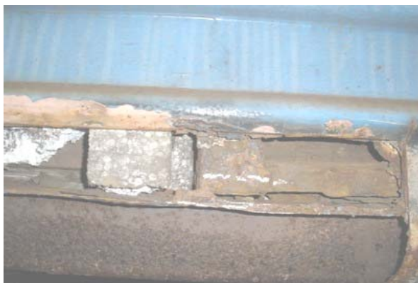
Рис. 5. Деформація нижньої об'язки, обрив стійки
