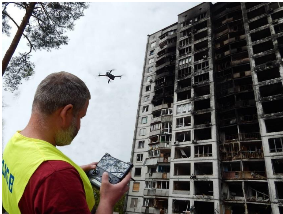
Рис. 1. Обстеження пошкоджених унаслідок воєнних дій будівель із використанням безпілотних літальних апаратів фахівцями ДП «Науково-дослідний інститут будівельного виробництва ім. В. С. Балицького» (м. Ірпінь, квітень 2022 р.)
