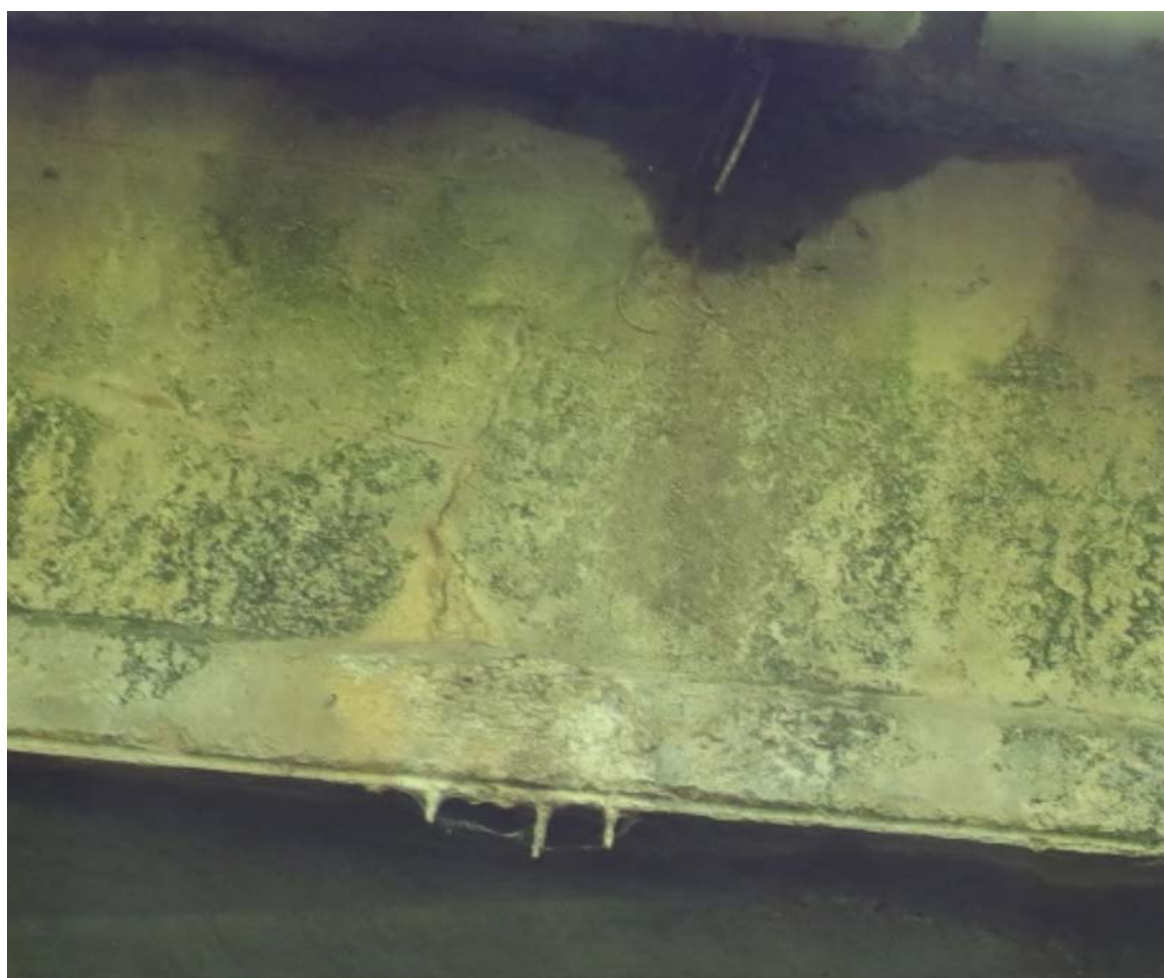
Рис.2.5 Поперечні тріщини в плиті П12 прогонової будови 0-1
