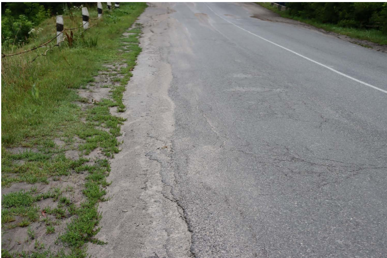
Рис. 2.19. Поперечні тріщини в асфальтобетонному покритті на всю ширину дороги зі сторони м. Житомир
