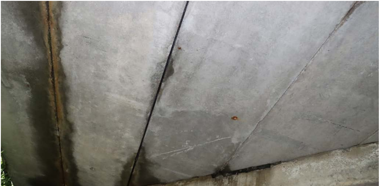
Рис. 2.2. Патьоки іржі та вилуговування бетону з утворенням сталактитів по поздовжньому шву між плитами П10-П12 прогонової будови 0-1.
