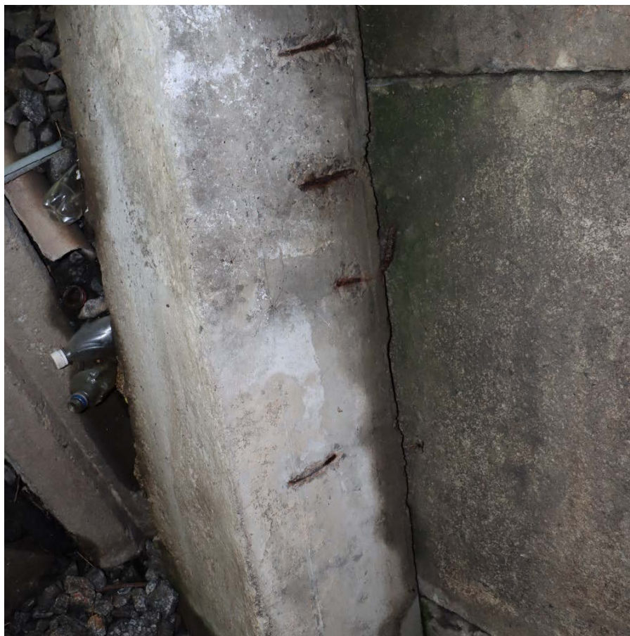
Рис. 2.11. Відшарування захисного шару бетону з оголенням і корозією поперечної арматури по палі П14 опори №0
