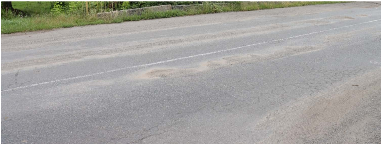
Рис. 2.17. Наноси ґрунту та порослі бур'яну біля парапетного огороження, колійність асфальтобетонного покриття та сітка тріщин на проїзній частині мосту
