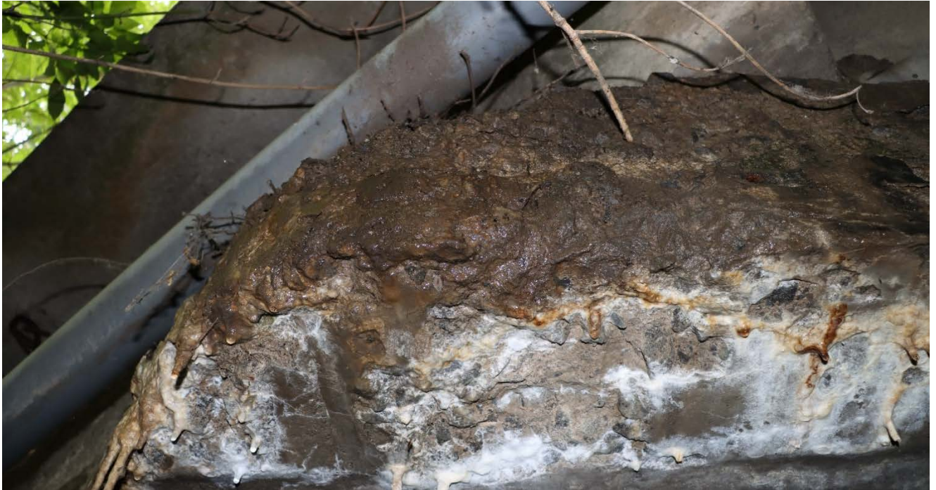
Рис. 2.8. Руйнування захисного шару бетону без оголенням арматури по торцю ригеля на опорі №0 біля плити П12. Вилуговування цементного каменю з утвореннями сталактитів по низу ригеля
