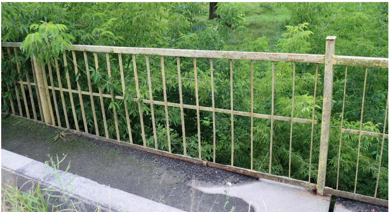
Рис. 2.16. Точкова корозія металевої поручневої огорожі ліворуч по ходу кілометрів. Частково зруйноване асфальтобетонне покриття
