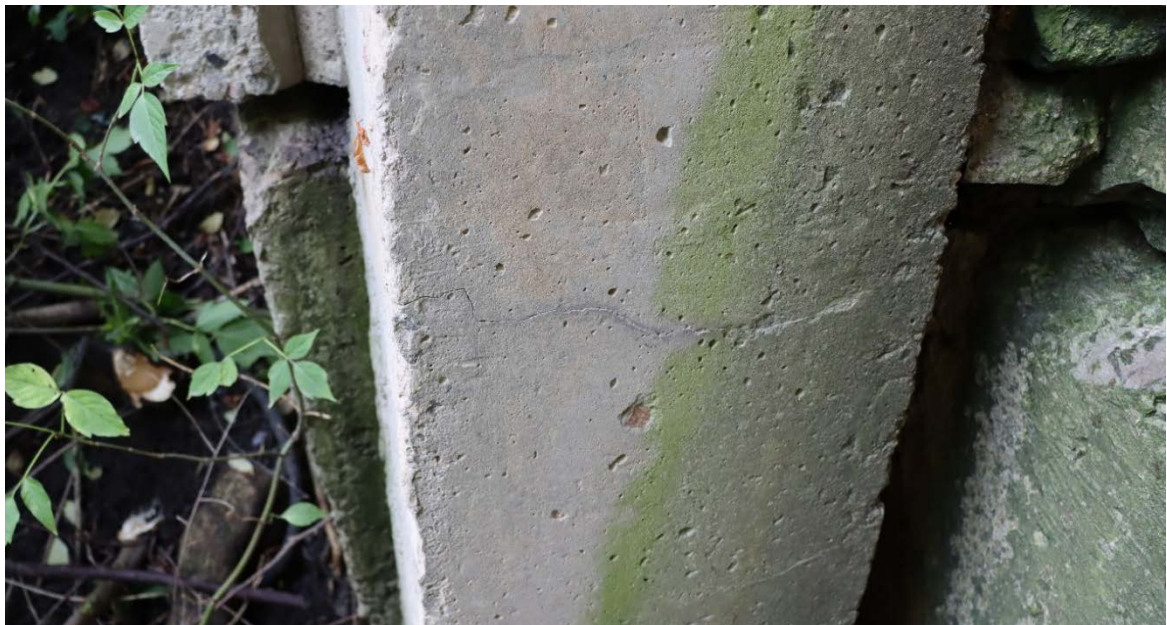
Рис. 2.14. Вертикальні та горизонтальні тріщини по бетонній поверхні палі П1 опори №1
