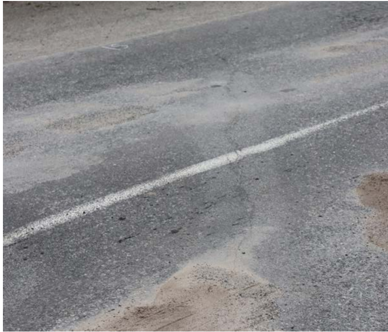
Рис. 2.18. Поперечна тріщина на проїзній частині мосту в місці влаштування деформаційного шва на опорі №1
