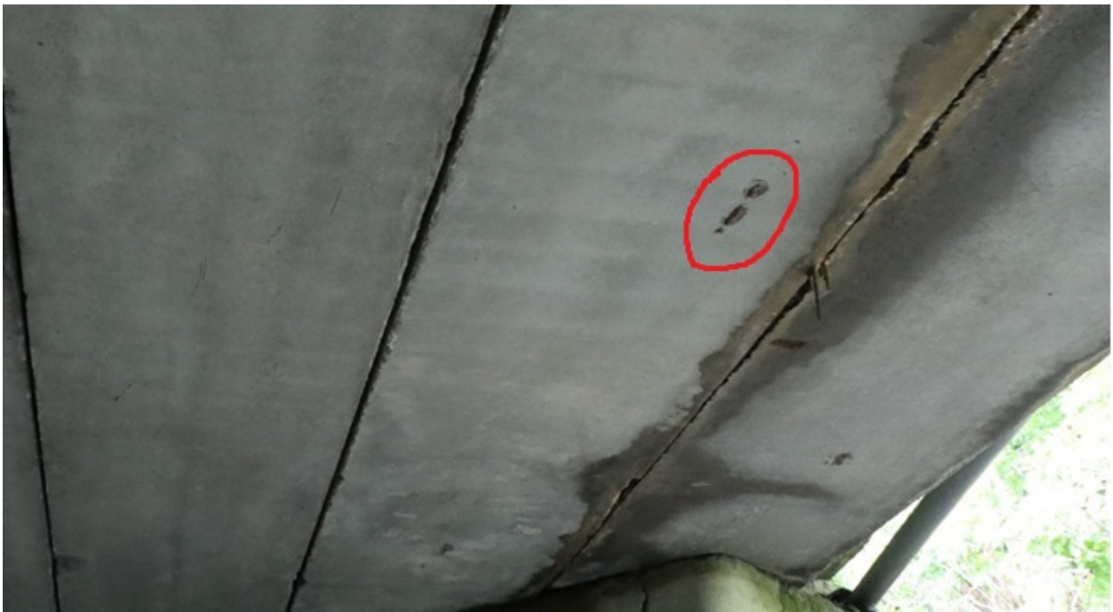
Рис. 2.3. Відшарування захисного шару бетону з оголенням і корозією поздовжньої арматури у плиті П11 прогонової будови 0-1
