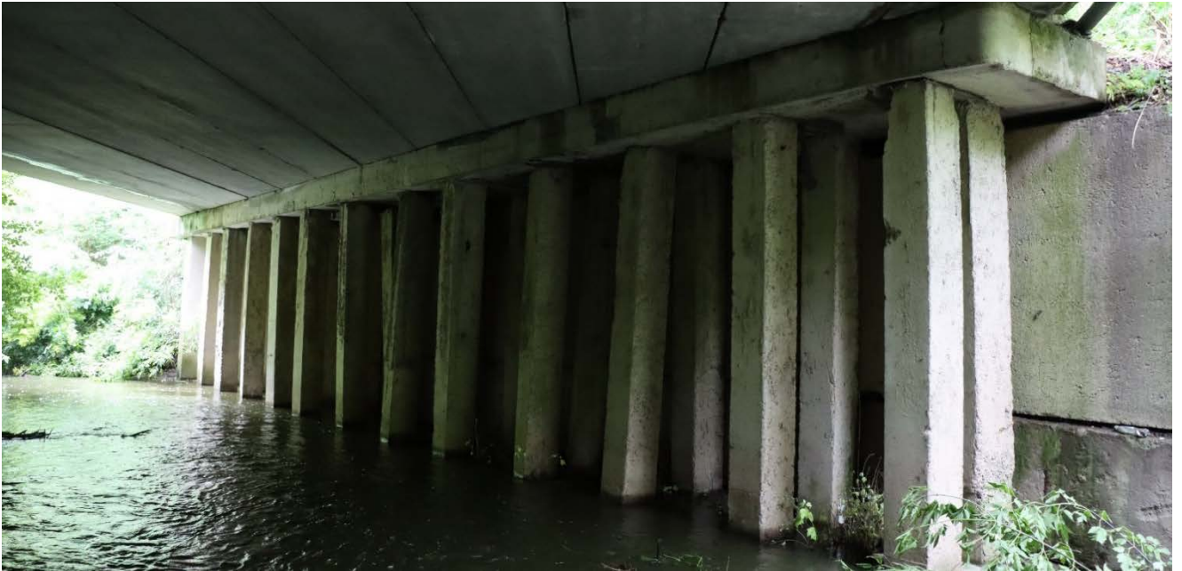
Рис. 2.21. Замокання з вилуговуванням цементного каменю та зелені патьки по забірній стінці із збірних залізобетонних плит за палями стояна №1
