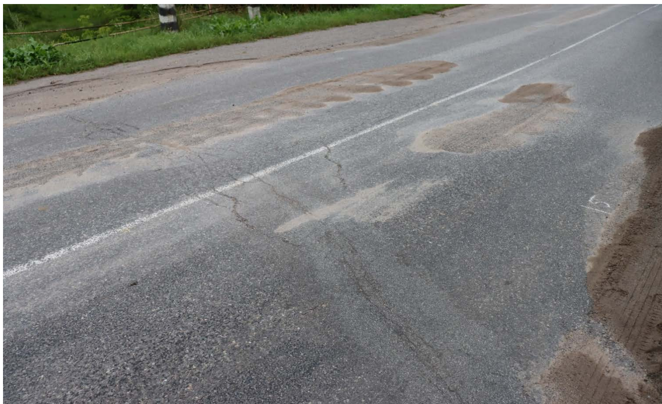
Рис 2.20. Сітка тріщин, колійність та руйнування кромки асфальтобетонного покриття на підходах до мосту зі сторони м. Житомир.
