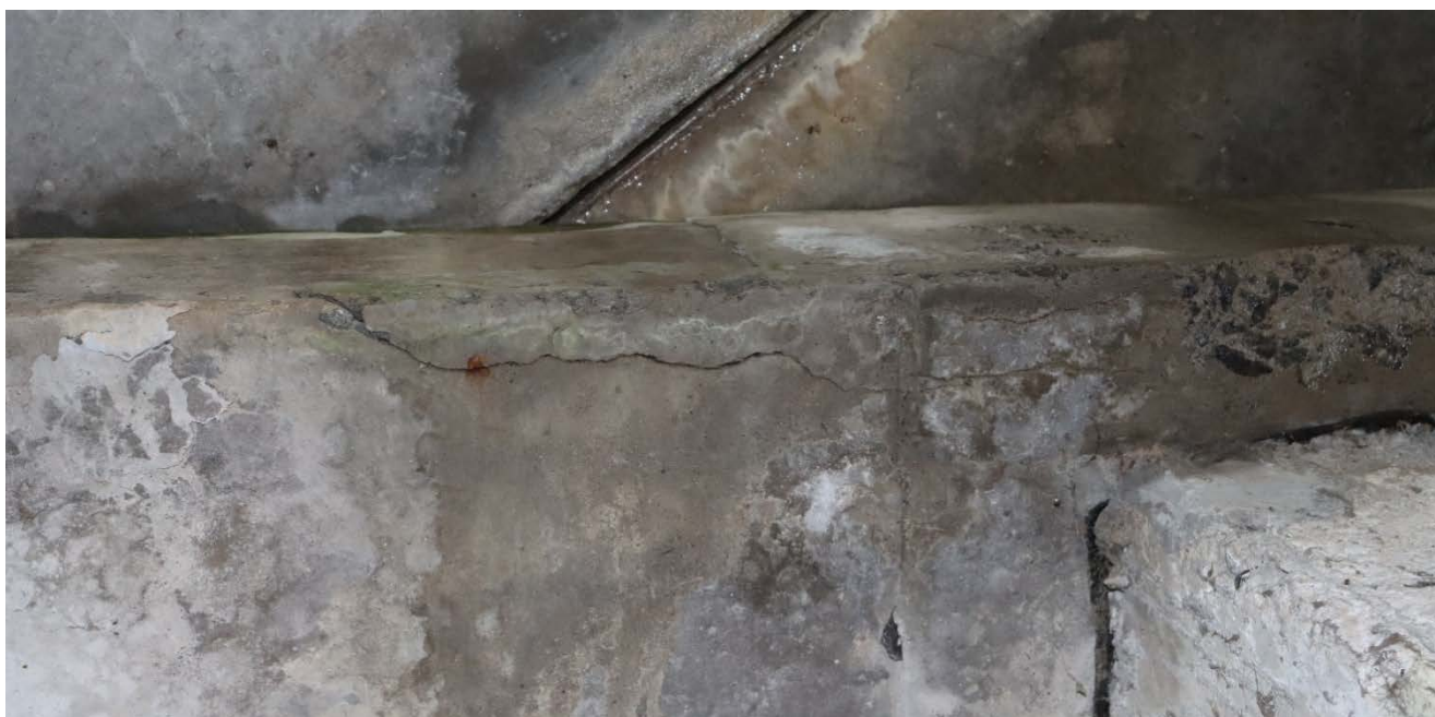
Рис. 2.10. Поздовжня тріщина по низу ригеля опори №1 біля палі П0
