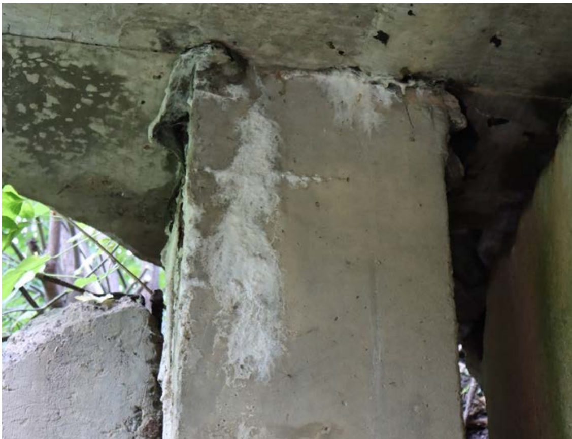
Рис. 2.9. Вилуговування цементного каменю на палі П1 опори №1
