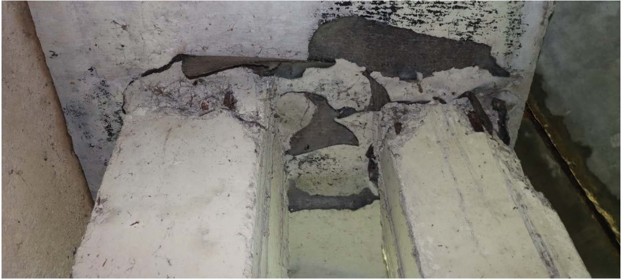
Рис. 2.13. Руйнування захисного шару бетону з оголенням та корозією арматури палі П13 в двох рядах опори №1 в місці їх об'єднання із ригелем
