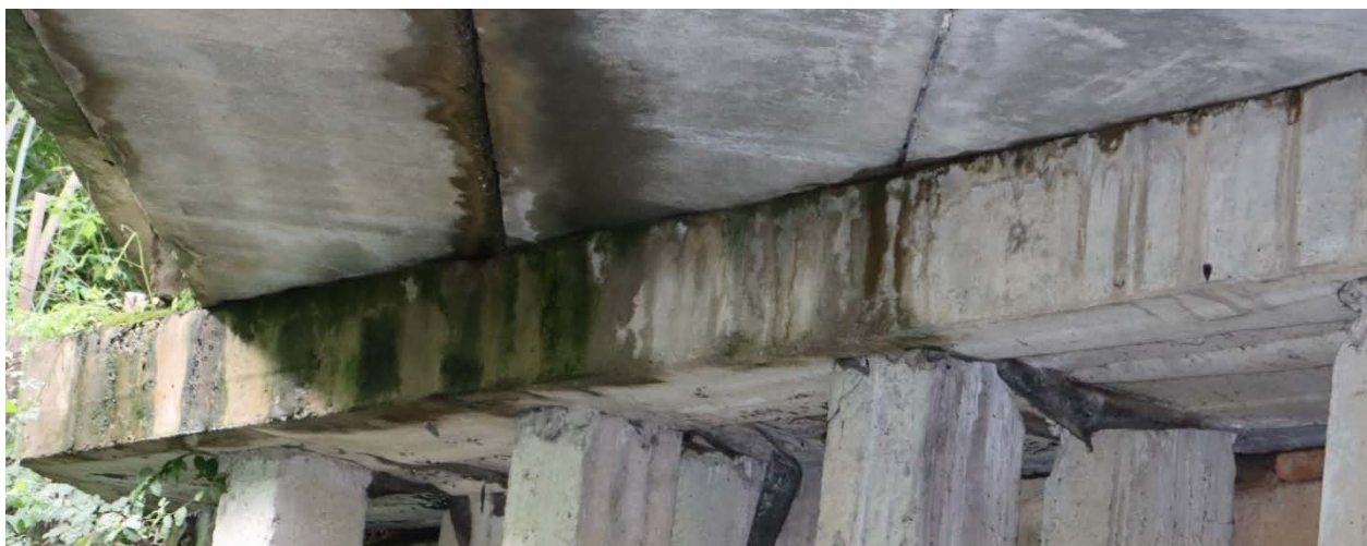
Рис. 2.6. Патьоки брудного, зеленого кольору та замокання по поверхні ригеля опори №1
