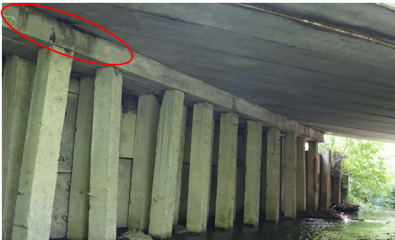
Рис. 2.7. Вилуговування цементного каменю по поверхні ригеля опори №0
