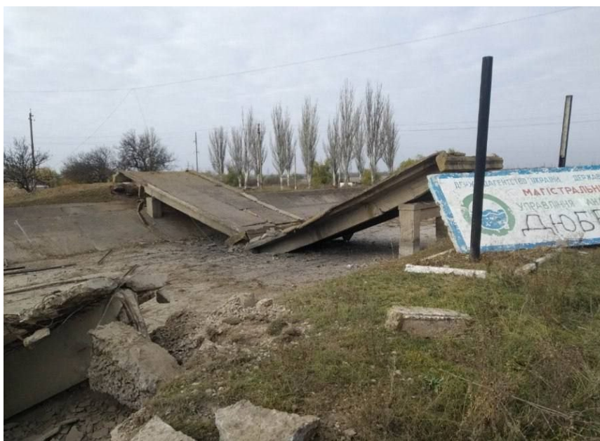
Рисунок 1.6 – Знищений міст через канал поблизу Снігурівки
