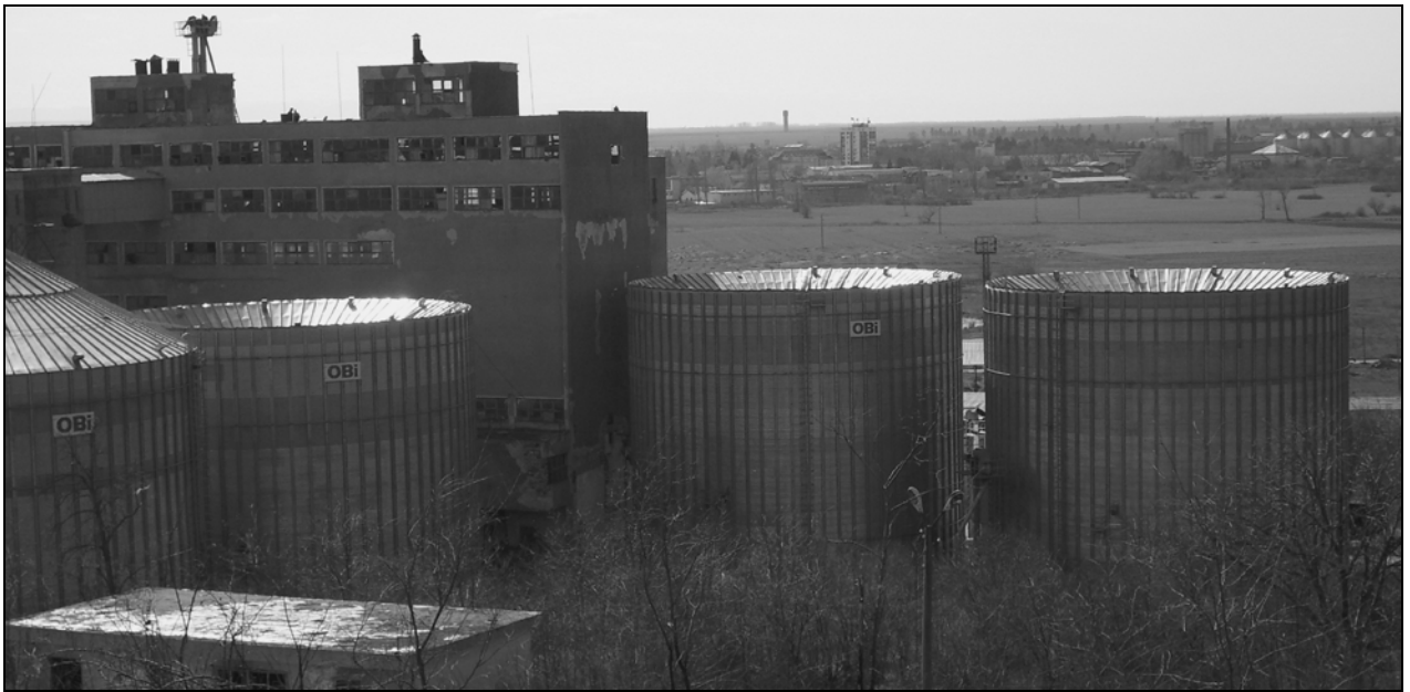
Рис. 1.27. Продавливание кровли силосных емкостей
