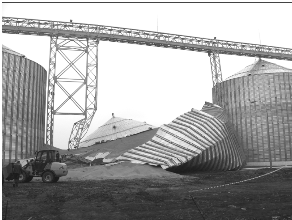
Рис. 1.23. Общий вид силоса и конструкций надсилосной галереи после аварии
