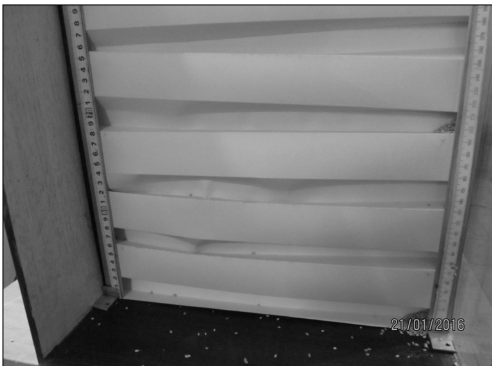
Рис. 5.14. Разрушение панели вследствие потери местной устойчивости нижних пластин второго и третьего гофров снизу
