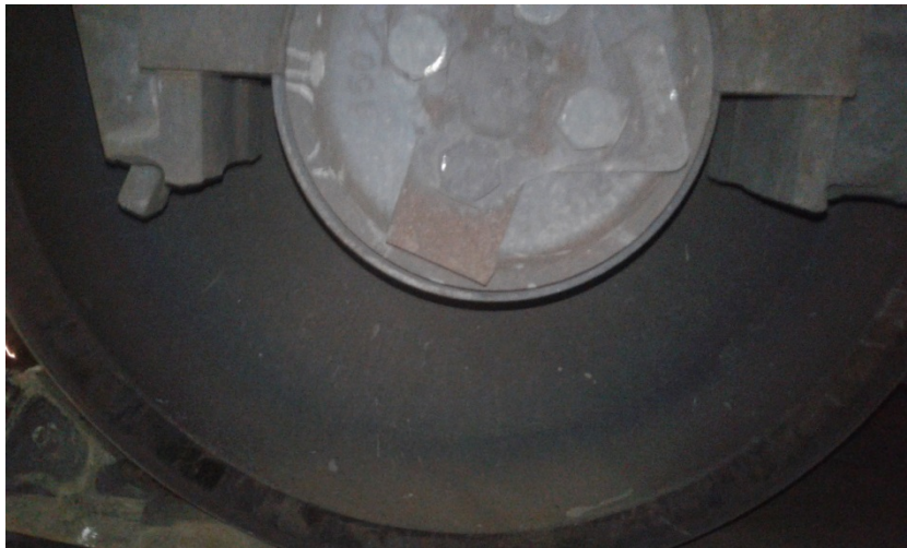
Рисунок Е.7 – Касетний підшипник (відсутній запобіжник від викочування колісної пари з-під візка, відсутня ув'язочна проволочка болтів торцевого кріплення касетного підшипника, відігнута запобіжна планка від самовільного повернення болтів торцевого кріплення)
