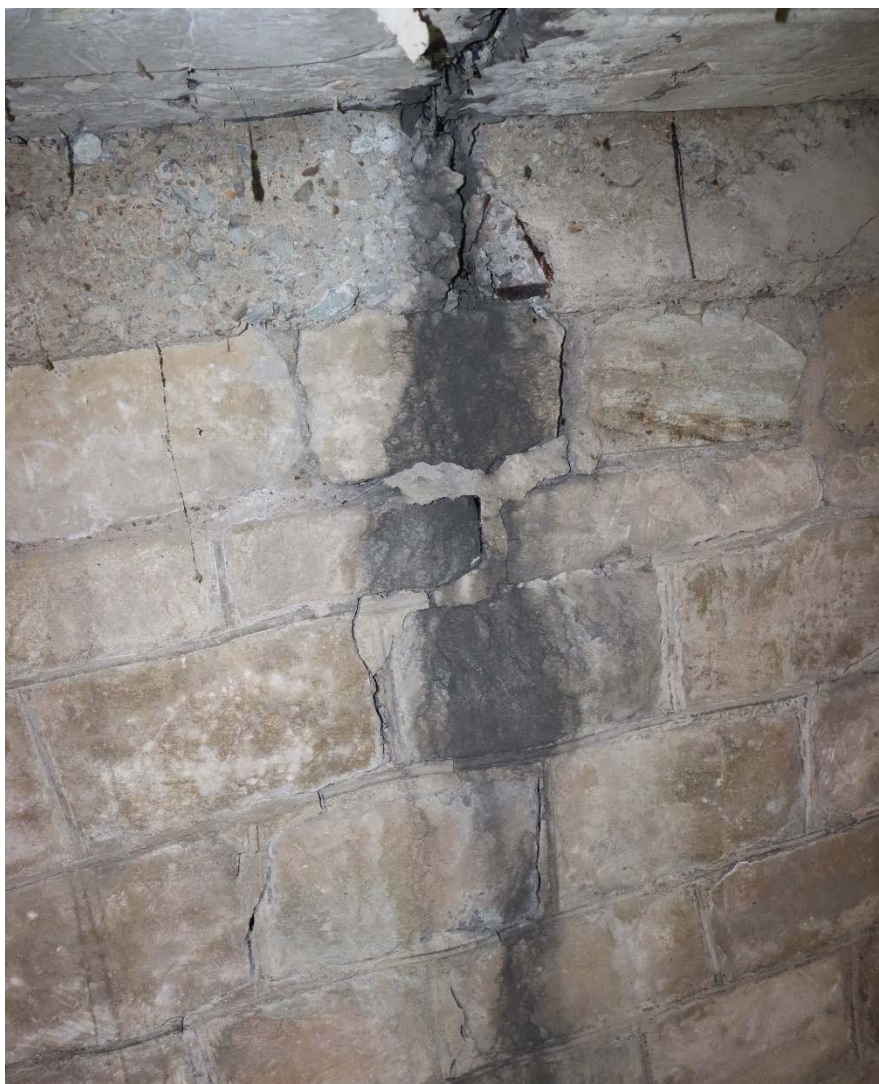
Рис. 2.8. Вертикальна тріщина в тілі кам'яної опори №1, що перетинає шви кладки
