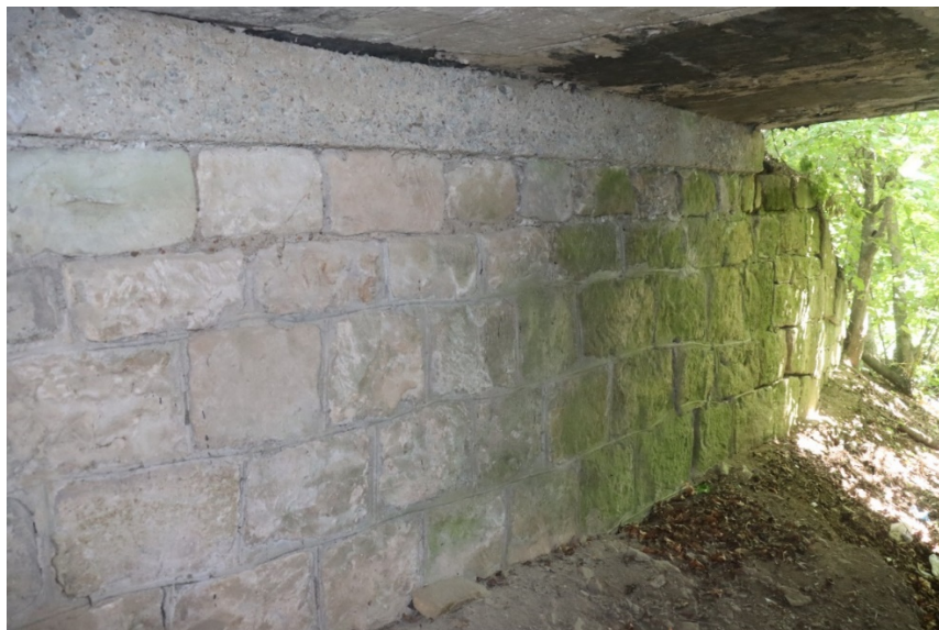
Рис. 2.6. Патьоки зеленого кольору по поверхні кам'яної кладки опори №0 2. Вертикальна тріщина по кам'яній кладці в зоні стикування опор №№0, 1 та відкрилків з низової сторони моста (рис. 2.7).
