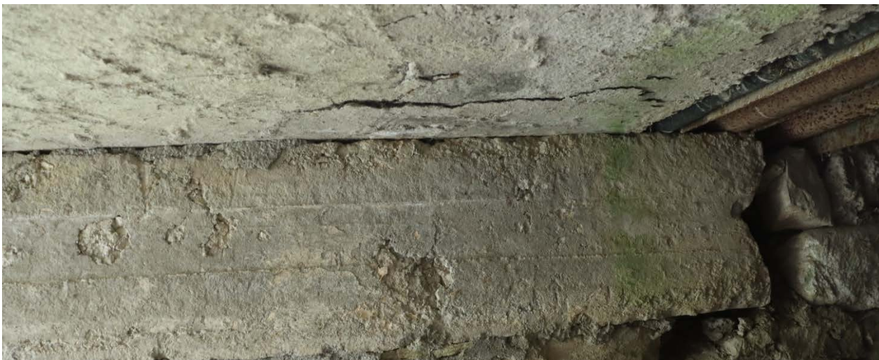
Рис. 2.1. Зелені плями, сліди замокання, вилугування бетону по монолітній прогоновій будові ПЗ
