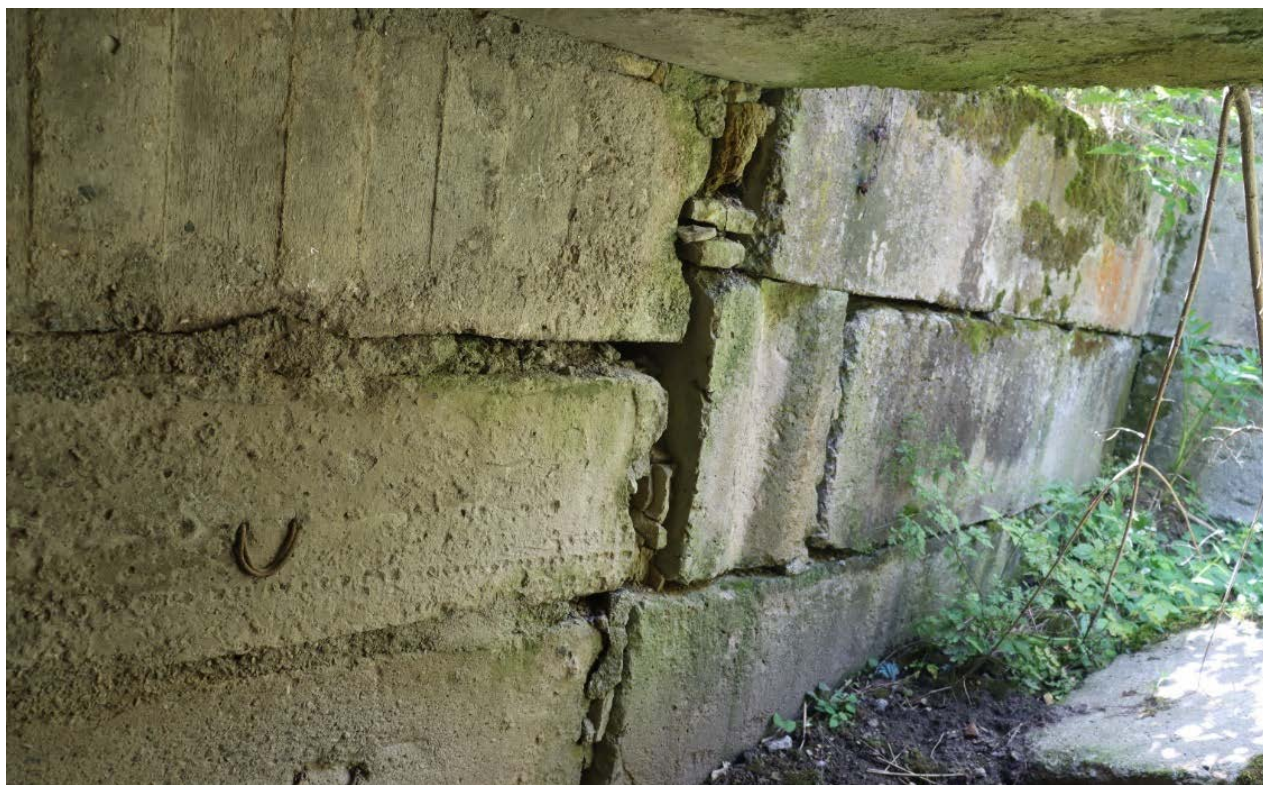
Рис. 2.10. Утворення грибка і моху на відкритках опори №1 з верхової сторони мосту
