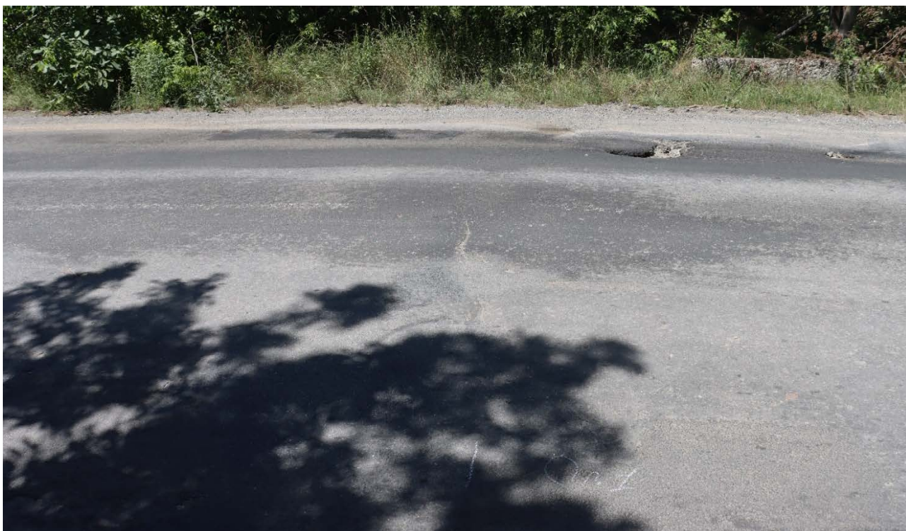
Рис. 2.12. Відстуній пішохідний тротуар праворуч за ходом кілометрів, невелика колійність, вибоїни, руйнування асфальтобетонного покриття на проїзній частині мосту, поперечна тріщина на проїзній частині мосту в місці влаштування деформаційного шва на опорі №1
