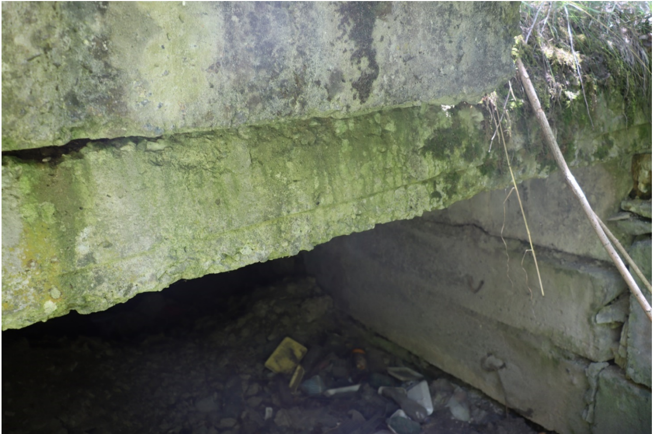
Рис. 2.5. Брудні, зелені патьоки по боковій поверхні плити П3 прогонової будови праворуч по ходу кілометрів
