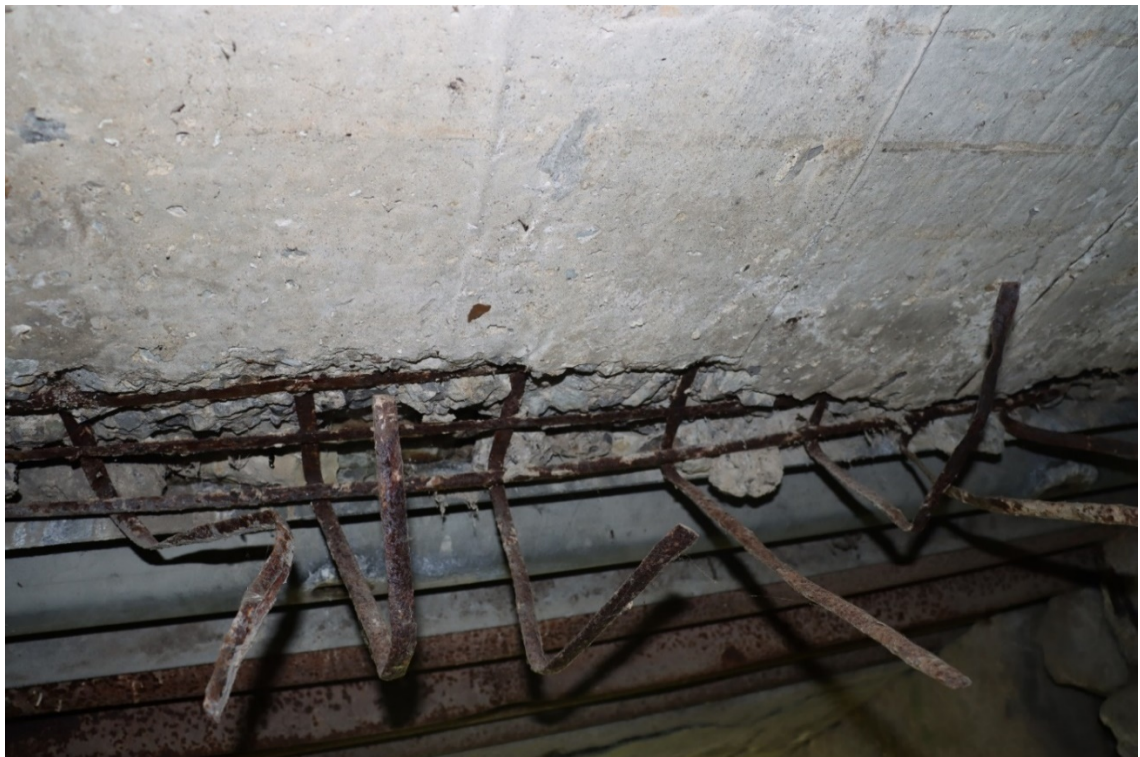
Рис. 2.4. Руйнування захисного шару бетону, оголення та корозія арматури по бічній поверхні монолітної прогонової будови П2 зі сторони плити П3
