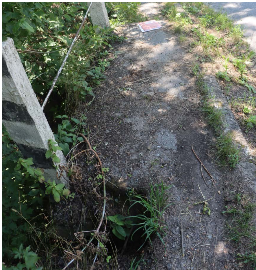
Рис 2.14. Провали ґрунту на опорі №0 біля тротуару ліворуч за ходом кілометрів
