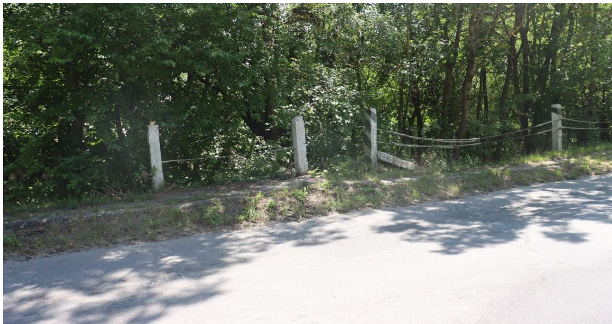
Рис. 2.11. Зруйнована поручнева огорожа ліворуч за ходом кілометрів, наноси ґрунту та порослі бур'яну ліворуч проїзної частини мосту
