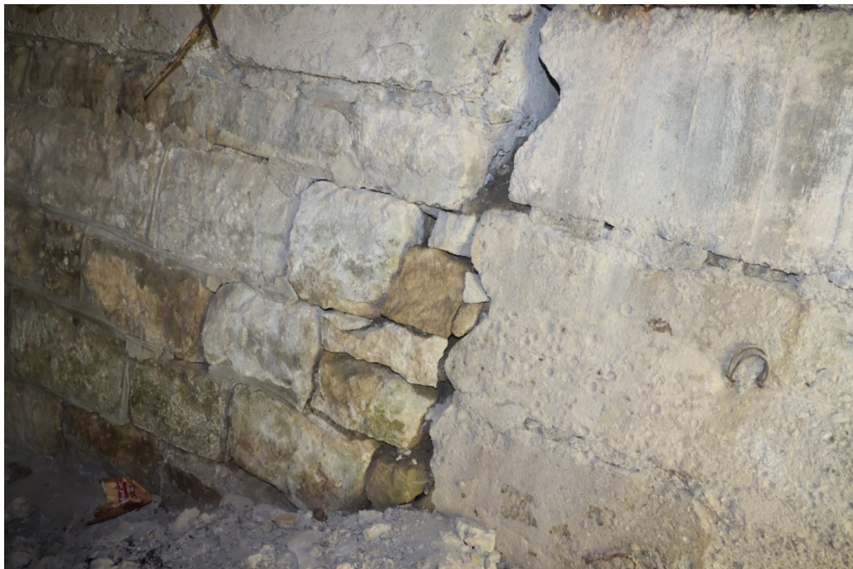
Рис. 2.9. Вивітрювання і вимивання цементного розчину з кам'яної кладки опори №1
