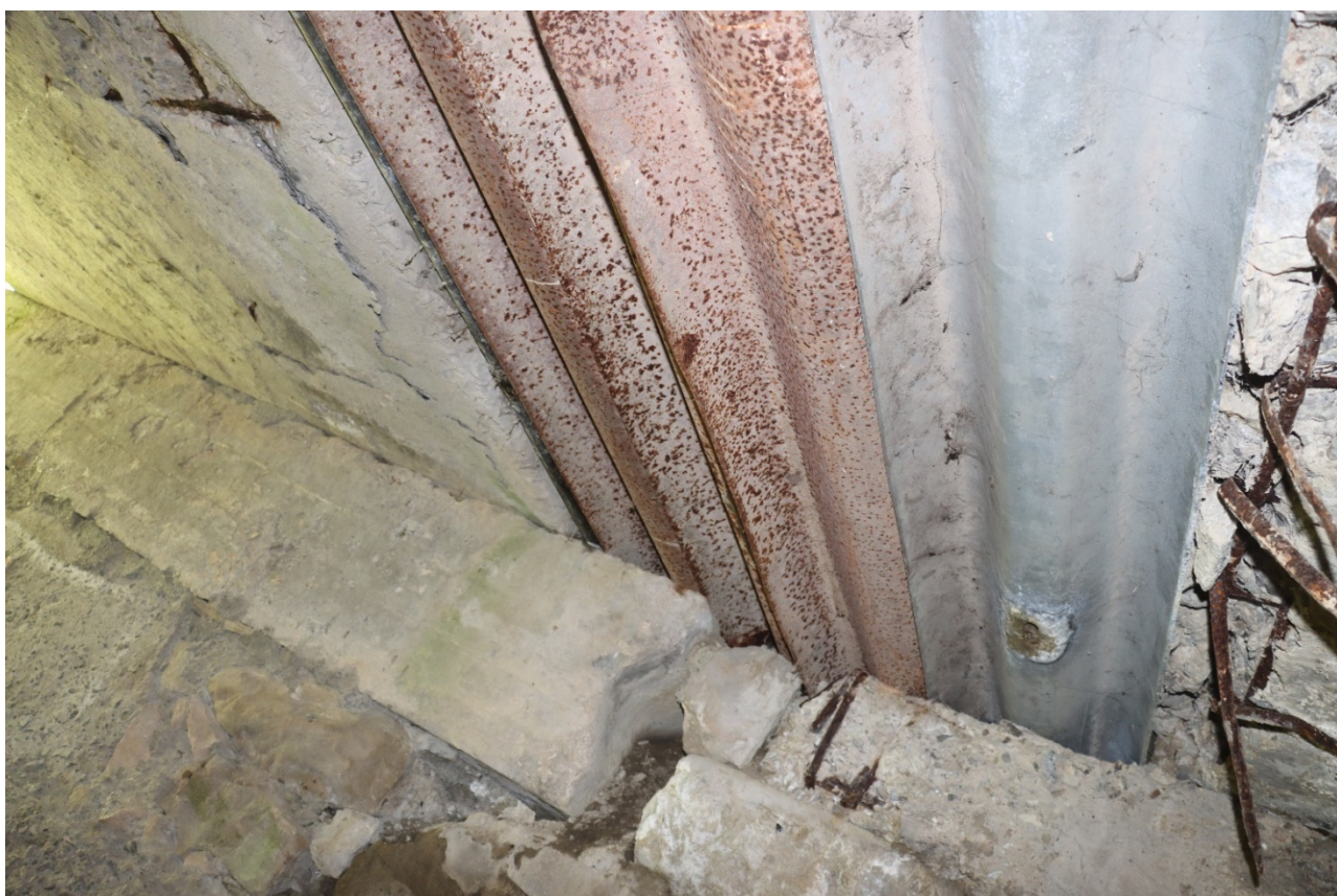
Рис. 2.2 Відсутня плита прогонової будови між плитами П2 та П3, відшарування захисного шару бетону із оголенням та корозією арматури по низу плити П3
