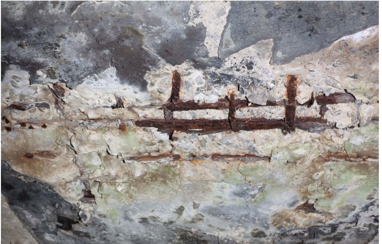
Рис. 2.3. Відшарування захисного шару бетону із оголенням та корозією арматури по низу плити П1
