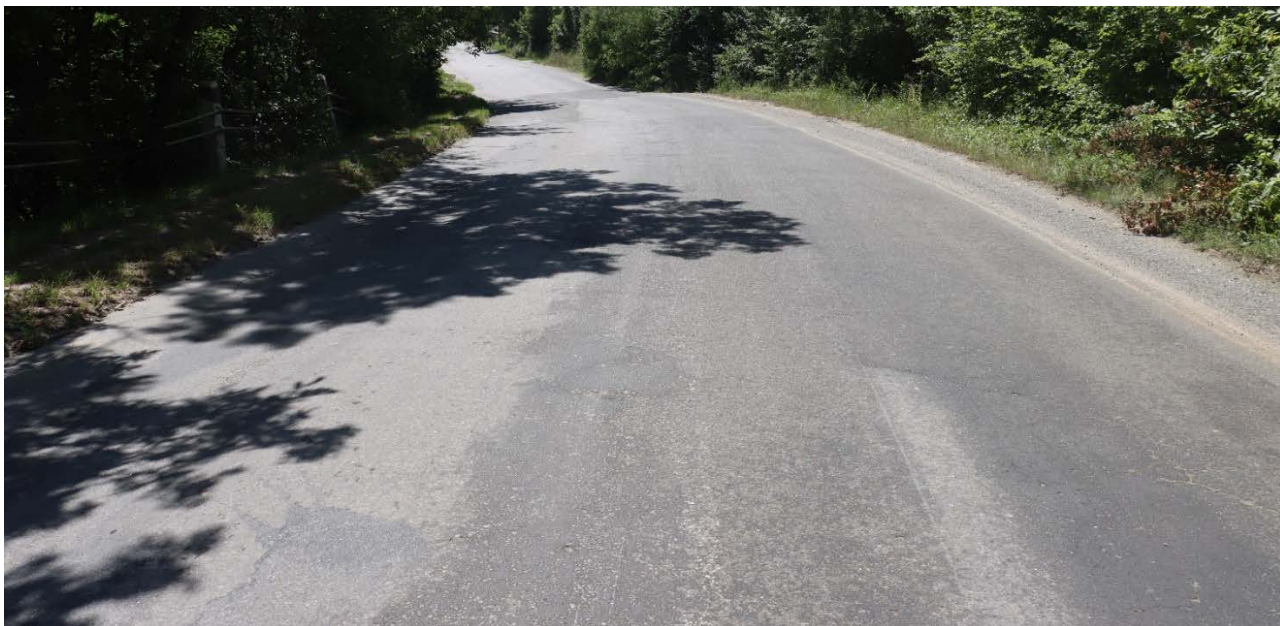
Рис. 2.13. Невелика колійність, поодинокі тріщини в асфальтобетонному покритті проїзної частині
