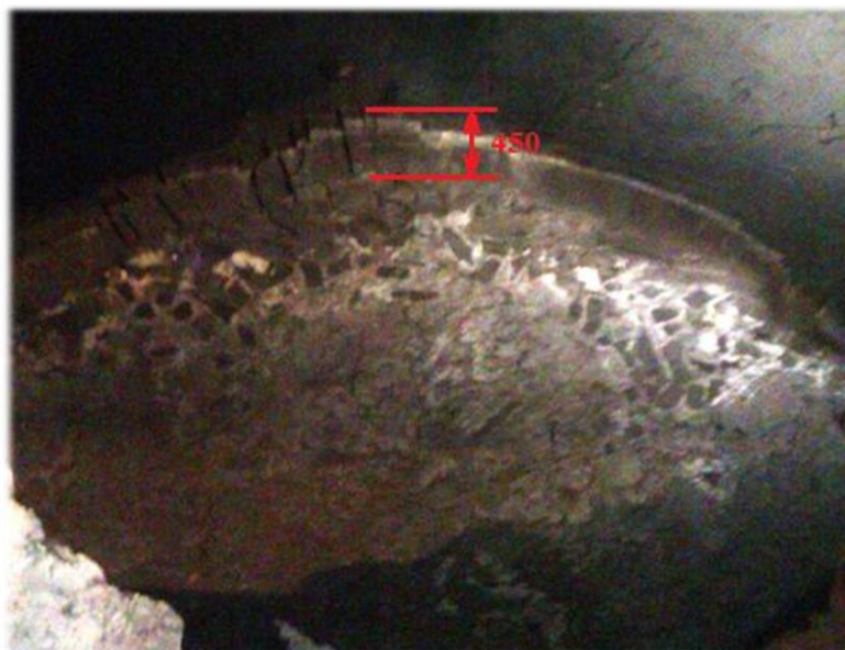
Рисунок 4.5. – Залишкові товщини футерівки конвертера №2 (при демонтажі) - стик «завалка» - нижній конус (350-450 мм).
