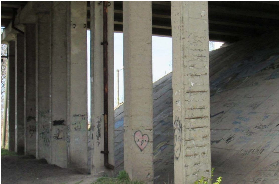
Рис. 2.5 Замалий захисний шар бетону стійки С1 проміжної опори №2
