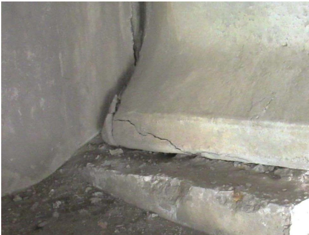
Рис. 2.2 Сколювання бетону опорного перерізу балки БЗ на стояні №1
