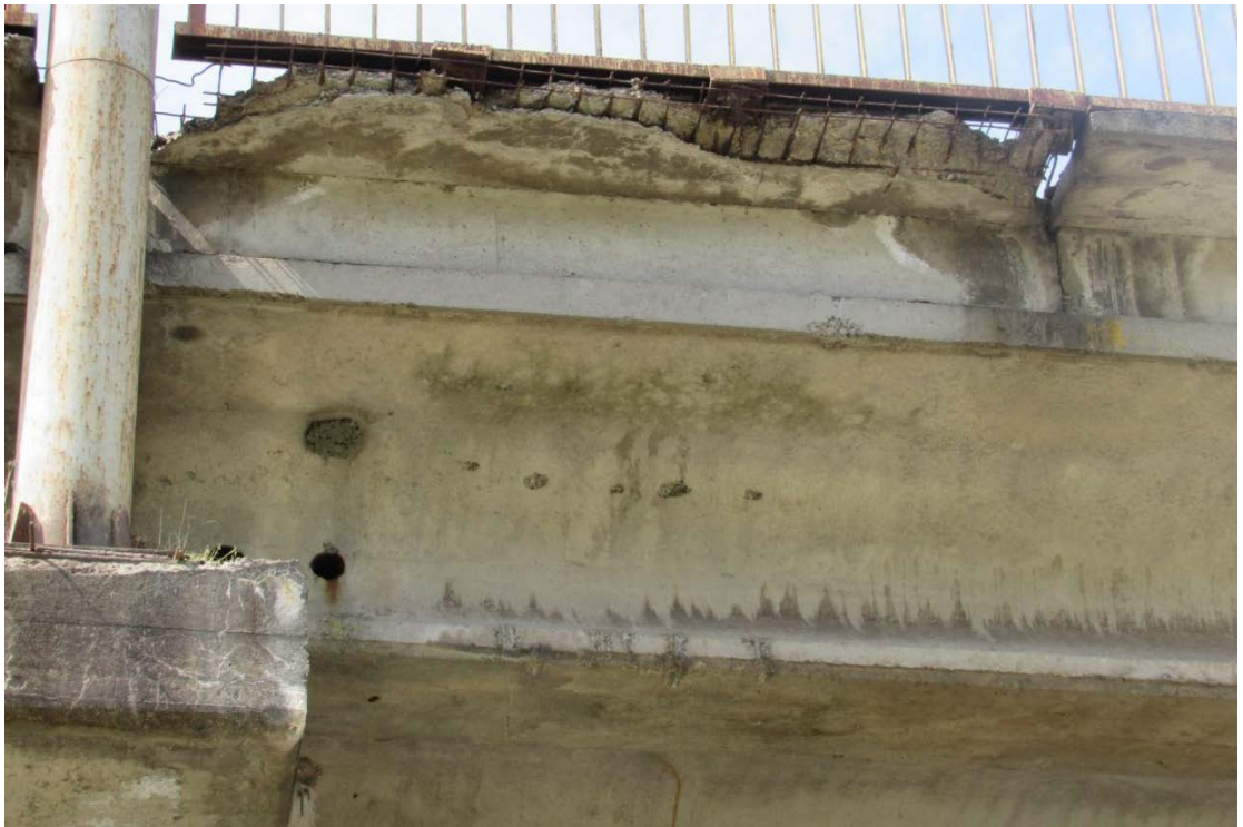
Рис. 2.3 Руйнування тротуарної плити прогонової будови ПБ 1-2 (вид знизу)
