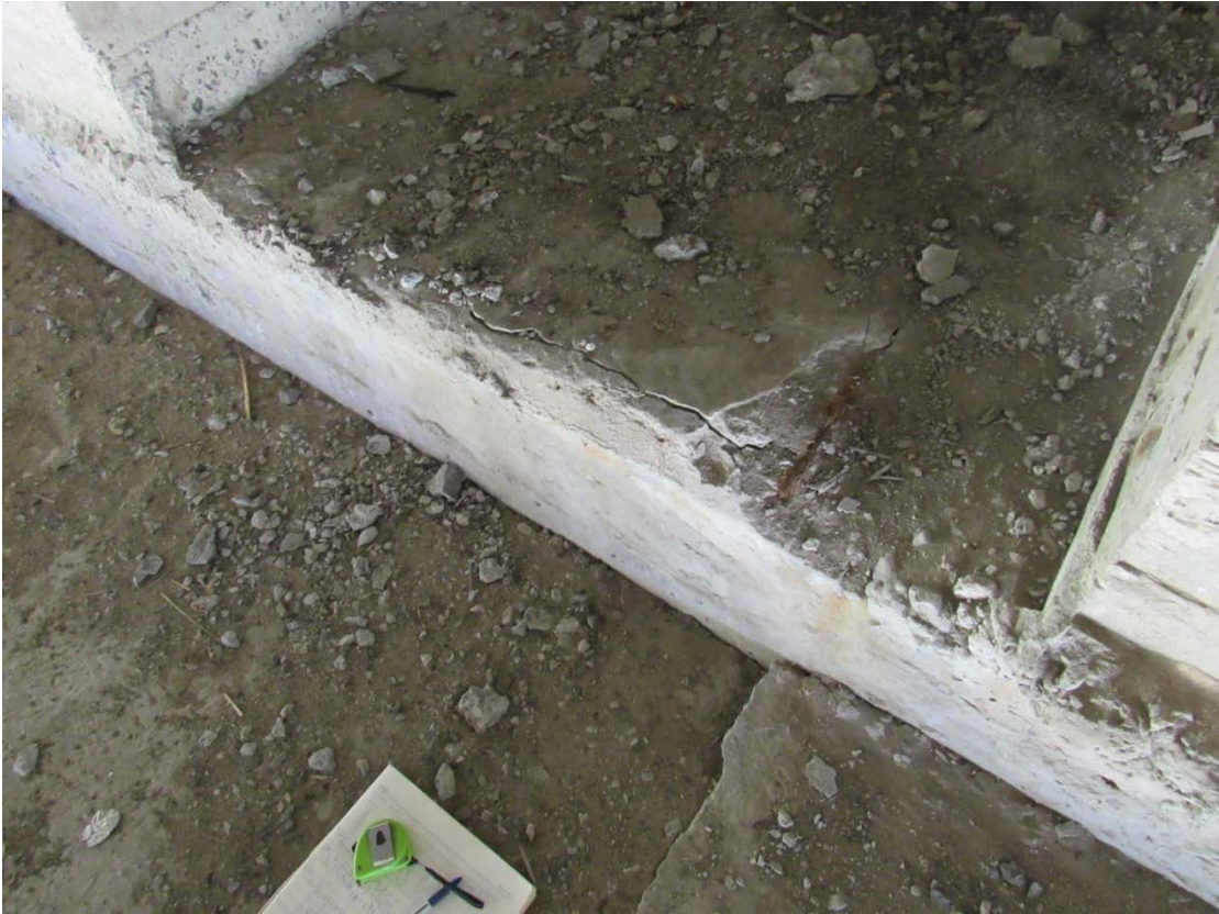
Рис. 2.8 Тріщина насадки стояна №4 розкриттям 5 мм довжиною 0,8 м між балками Б4-Б5, сколювання бетону площею 0,1 м 2
