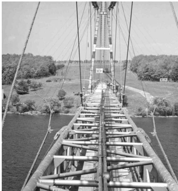
Рис. 4. Общий вид моста. Верхний пояс и наклонные подвески висячих ферм, балка жесткости, пилон, ветровая ферма
