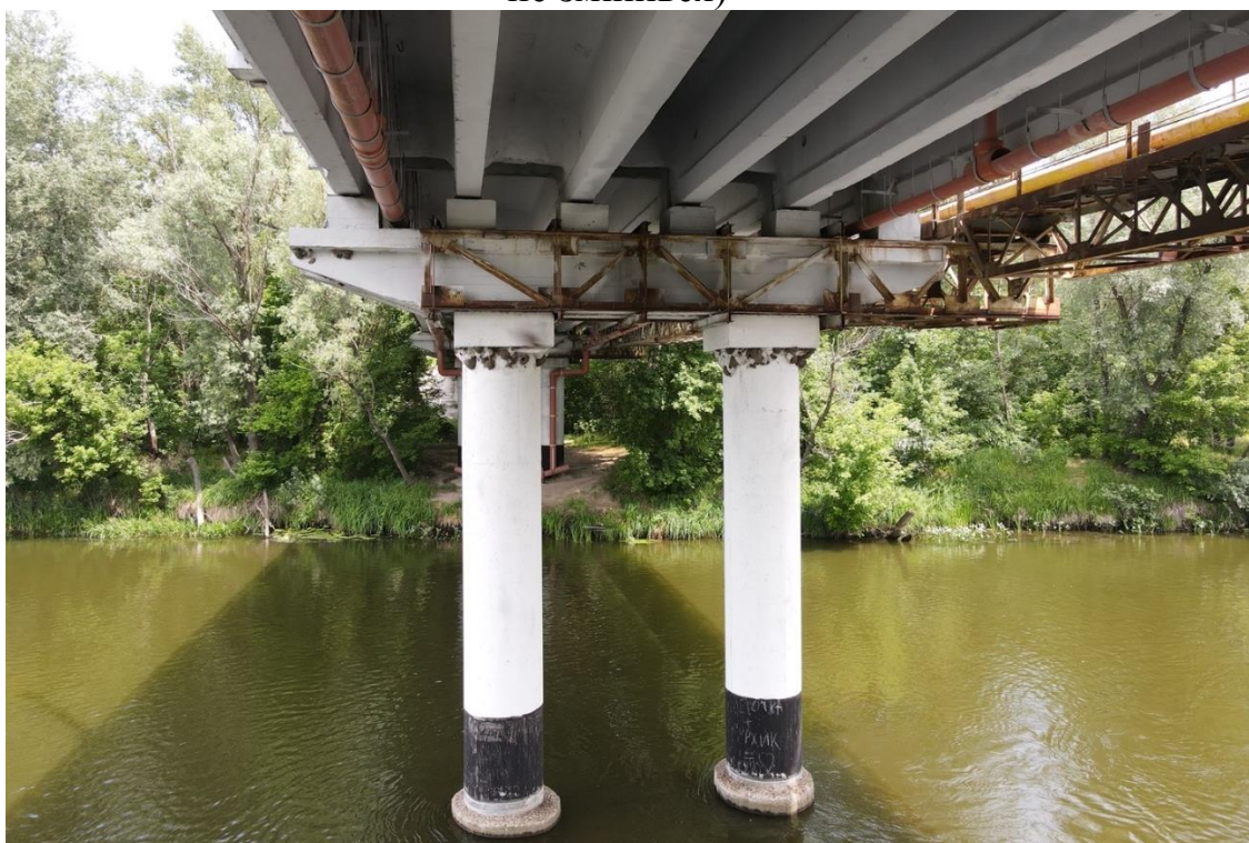
Рис. 1.5. Опора №7. Загальний вид до руйнування . Важливо звернути увагу на спирання колонн – фундамент ймовірно буронабивні стовпи діаметром 1,5м
