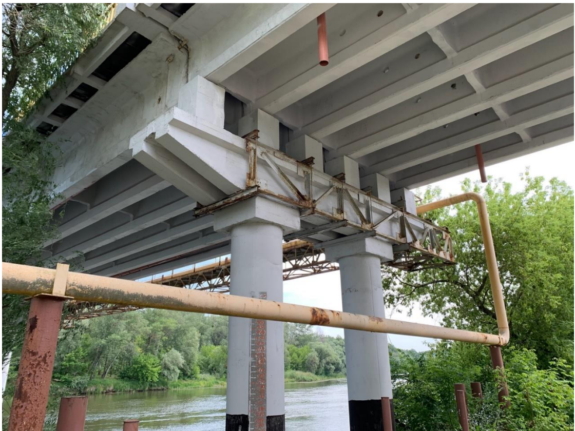
Рис. 1.7. Опора №9 до руйнування споруди
