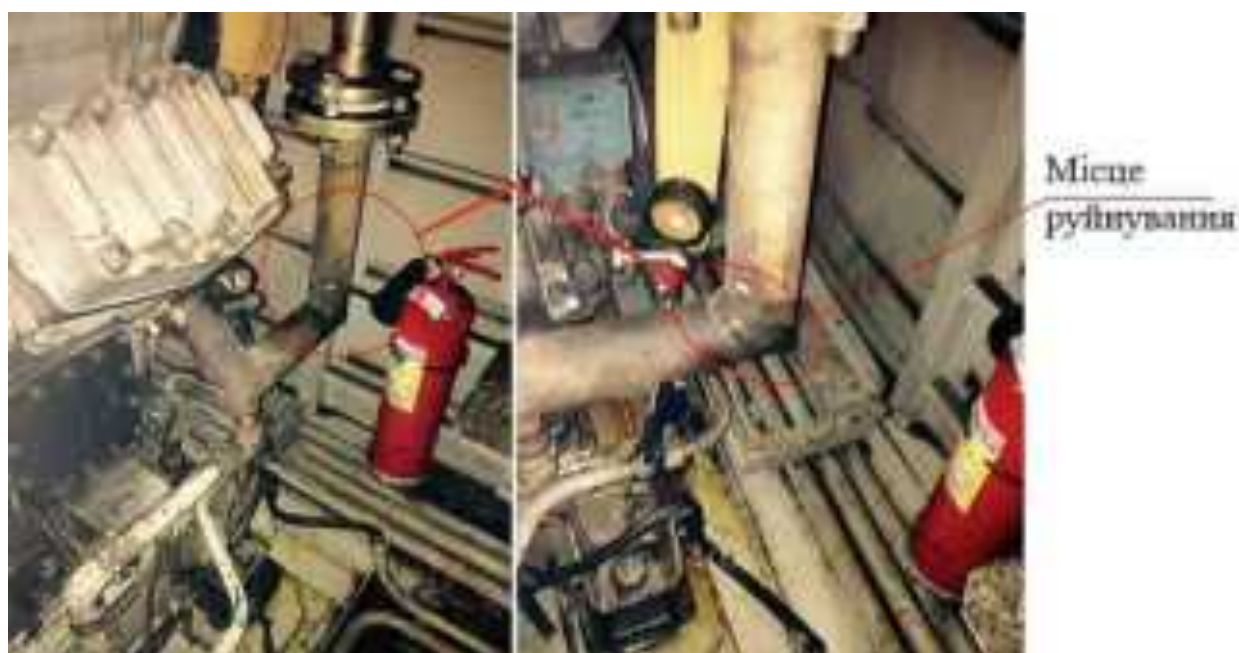
Рисунок 3.1 – Характерне місце відмови трубопроводу напірної частини повітряної магістралі компресора
