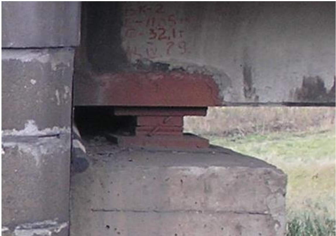
Рисунок – 2.7 Відсутність анкерних болтів кріплення нижніх опорних плит нерухомих опорних частин.
