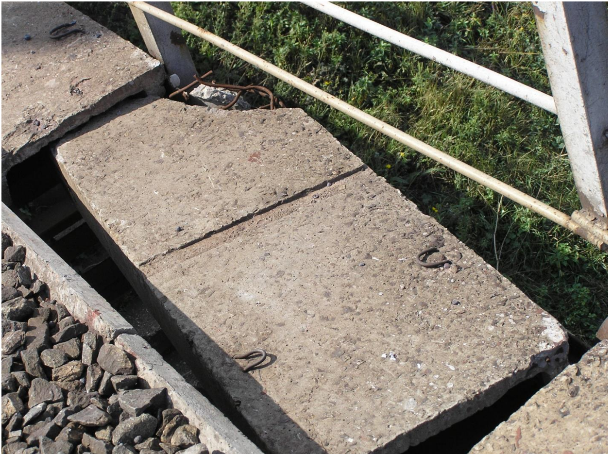
Рисунок – 2.8 Пошкодження залізобетонної плити на пішохідному тротуарі моста.
