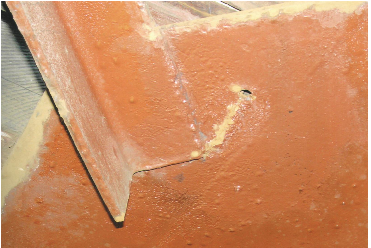
Рисунок 2.13 – Тріщина у верхній фасонці з початком розвитку від тріщини Т-5 (від флангового шва прикріплення діагоналі поздовжніх в'язів)
