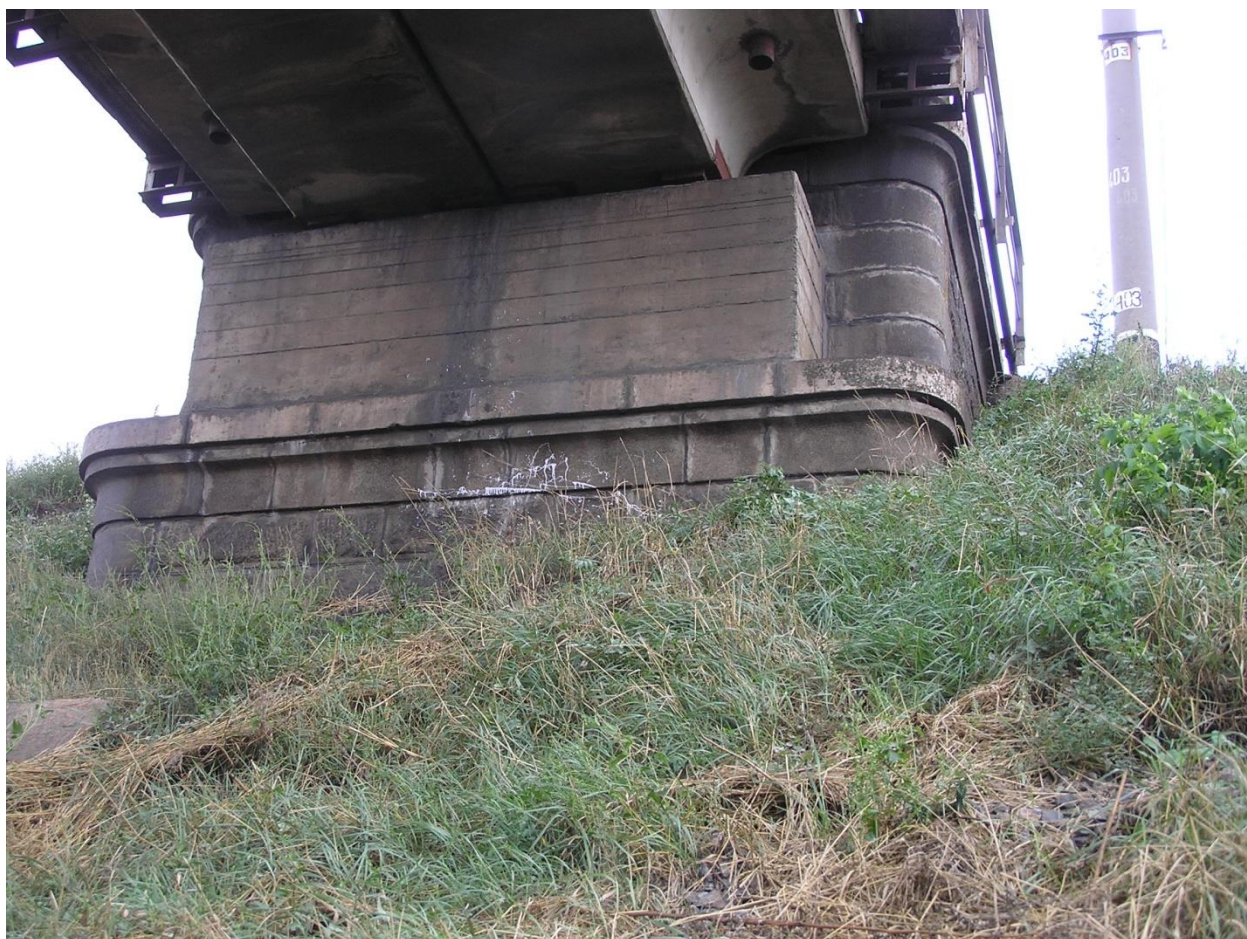
Рисунок – 2.10 Відсутність оглядових пристроїв на опорі моста.
