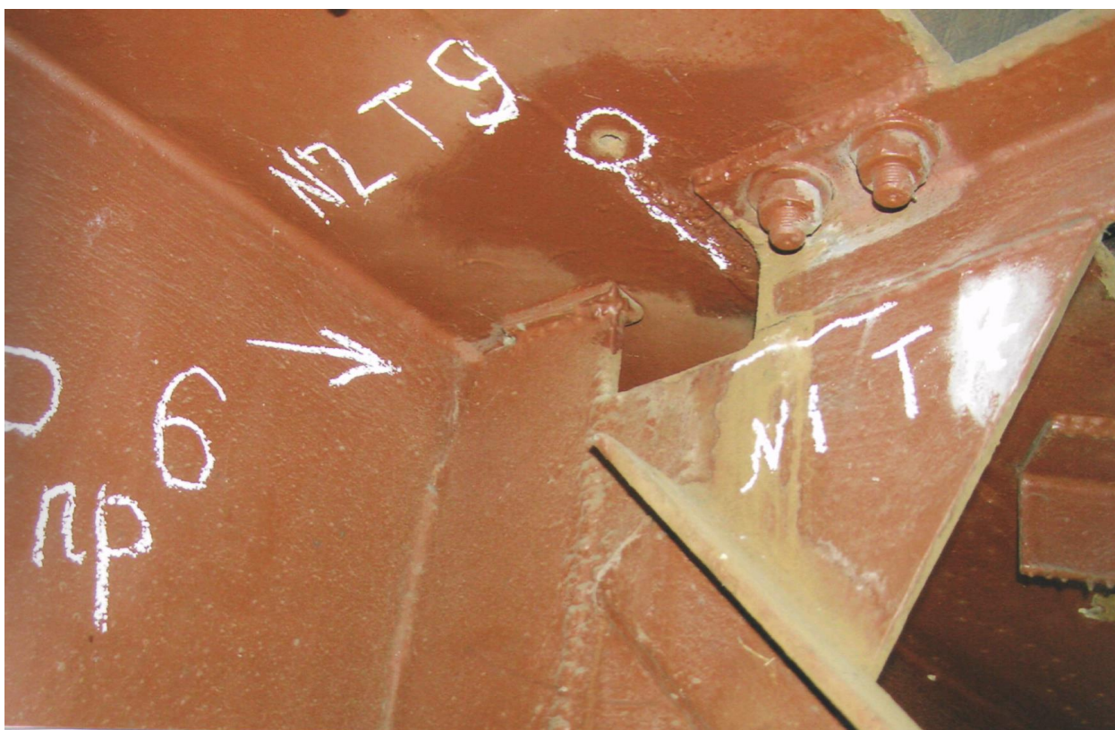
Рисунок 2.14 – Тріщина Т-3 у зварному шві прикріплення в'язів верхньої фасонки
