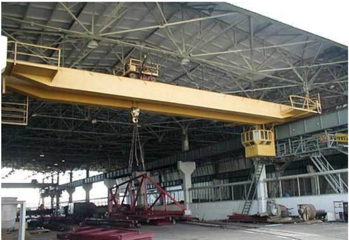
Рис. 1.1. Загальний вид мостового крана
