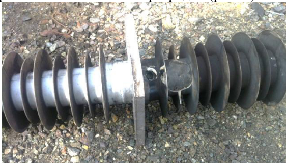
Рис. 2. Полимерный проходной изолятор, вышедший из строя по причине электрического старения изоляции
