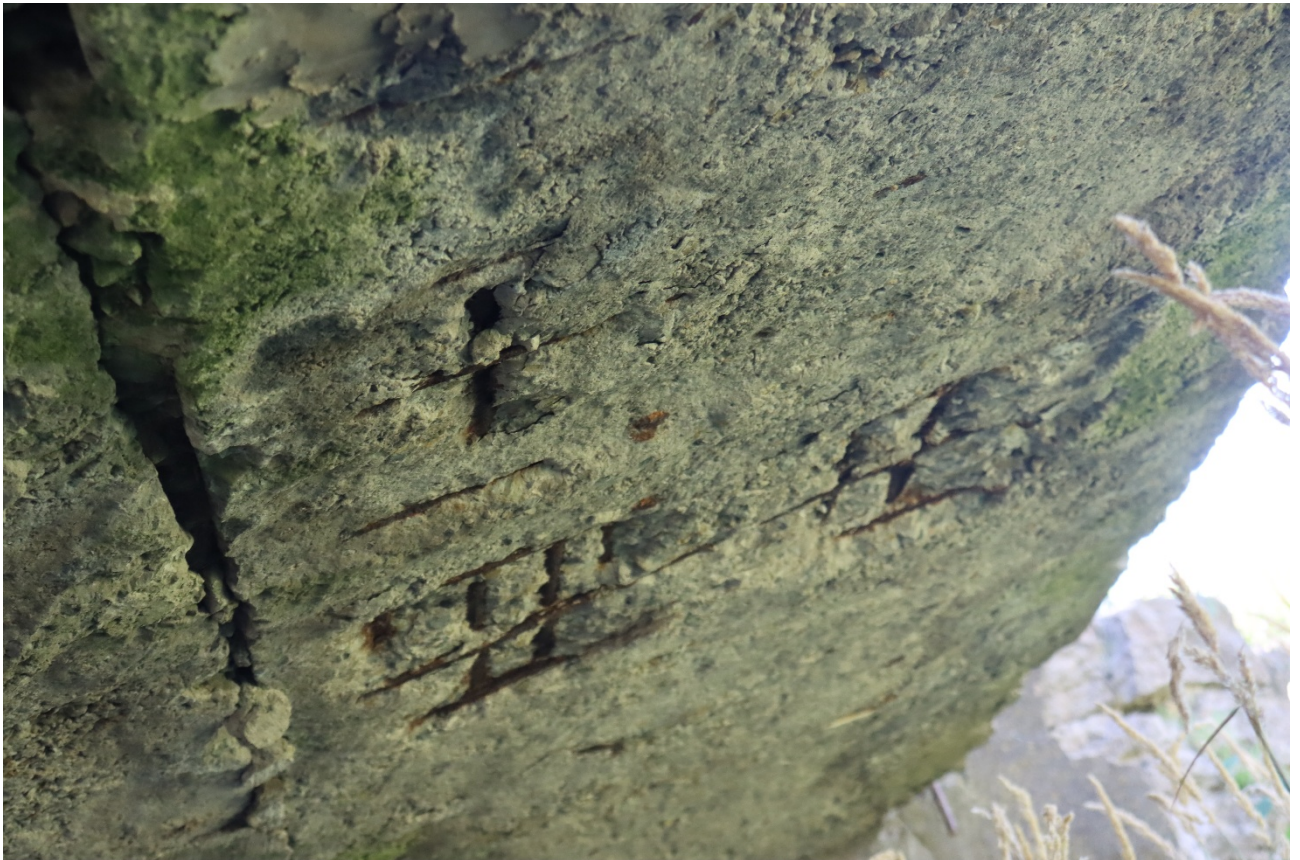
Рис. 2.5. Відшарування захисного шару бетону з оголенням і корозією поздовжньої та поперечної арматури в плиті П8
