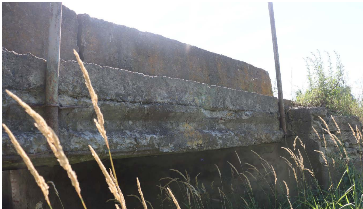
Рис. 2.2. Патьоки жовтого та зеленого кольору, щербеність, сколи, каверни та чарунки в бетоні, руйнування захисного шару бетону із оголенням та корозією робочої арматури на боковій поверхні плити П8
