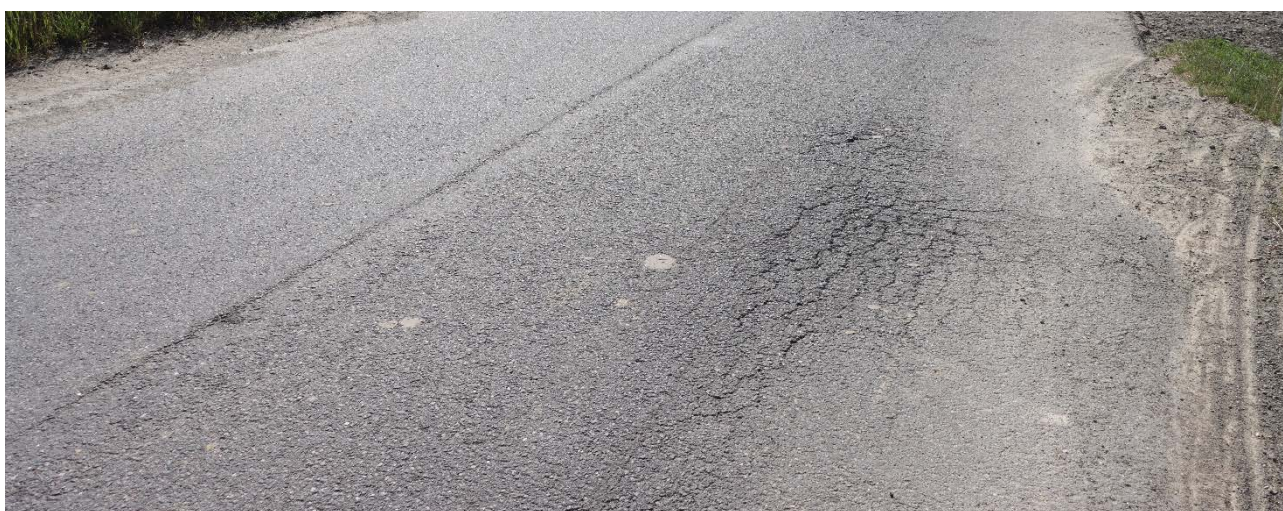
Рис. 2.12 Технологічні тріщини в асфальтобетонному покритті проїзної частини мосту
