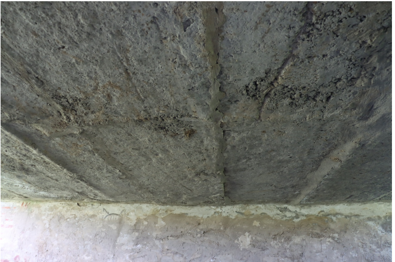
Рис. 2.3. Щербенистість, сколи, каверни та чарунки в бетоні плит П1-П8
