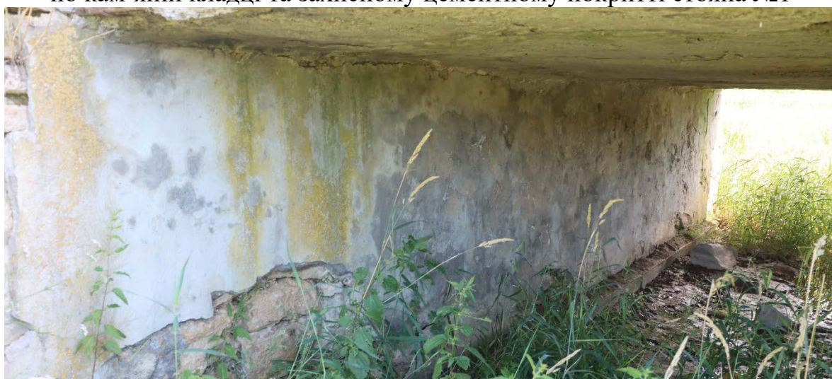
Рис. 2.10. Руйнування захисного цементного покриття у зоні змінного рівня води на стояні №0. Патьоки жовто-зеленого кольору та вилугування цементного каменю по кам'яній кладці та захисному цементному покритті.
