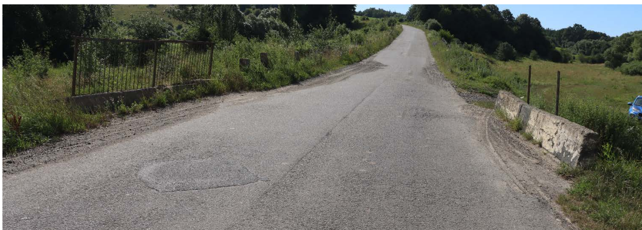
Рис. 2.11. Відсутня металева перильна огорожа праворуч по ходу кілометрів.
