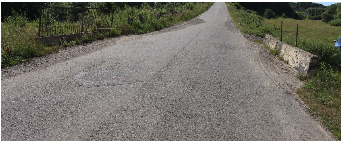
Рис. 2.13. Сітка тріщин в асфальтобетонному покритті на проїзній частині біля стояна №0.
