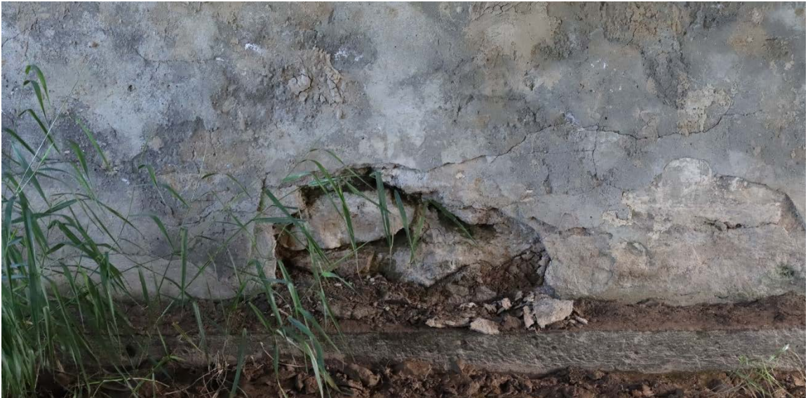
Рис. 2.7 Вивітрювання і вимивання цементного розчину з кам'яної кладки стояна №1
