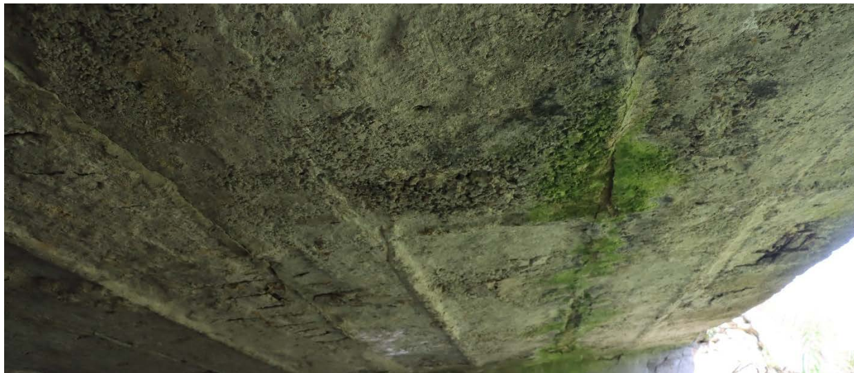
Рис. 2.1. Зелені патьоки та сліди вилуговування цементного каменю по поздовжньому шву між плитами П1-П3 та П7-П8, руйнування захисного шару бетону та корозія арматури
