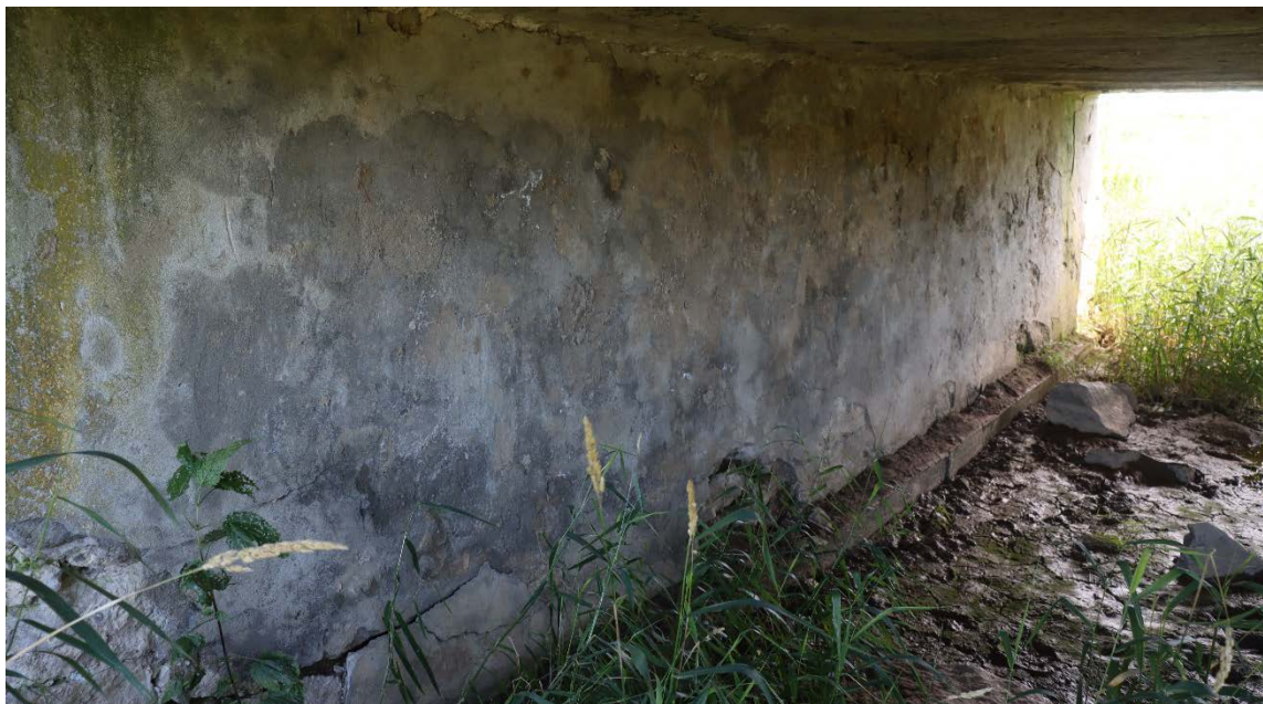
Рис. 2.8. Патьоки жовто-зеленого кольору та вилугування цементного каменю по кам'яній кладці та захисному цементному покритті стояна №0
