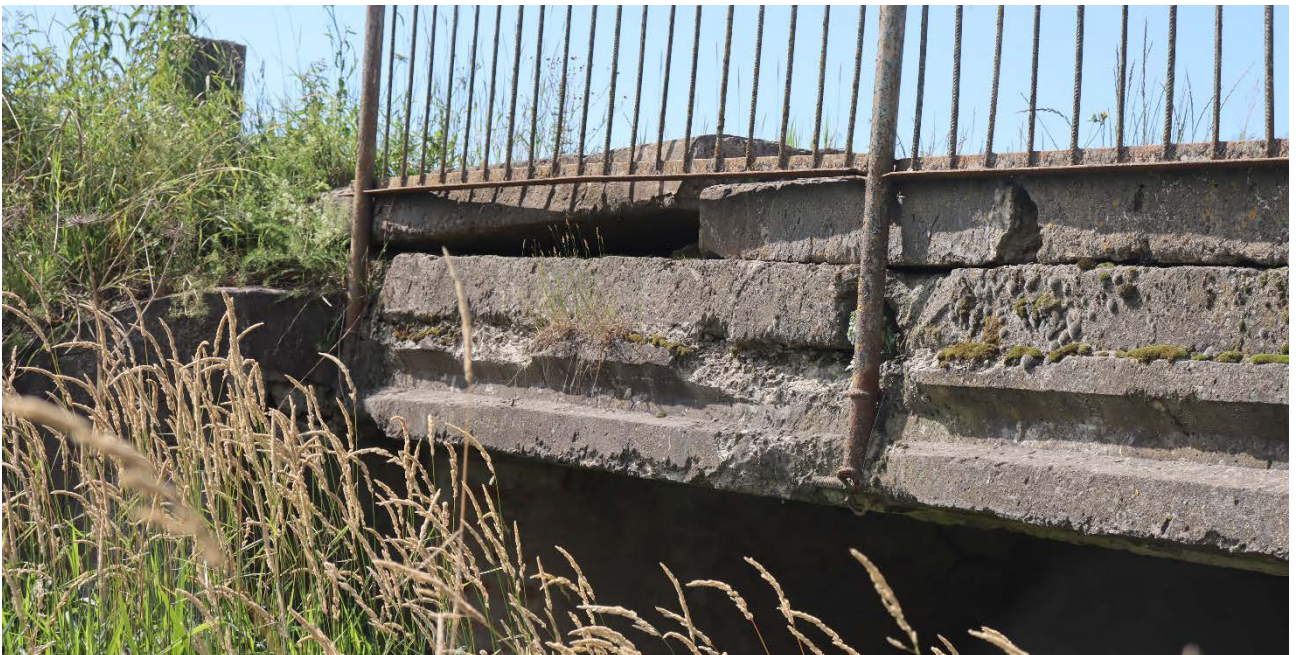
Рис. 2.4. Руйнування захисного шару бетону з оголенням і корозією робочої арматури на поверхні плити П1
