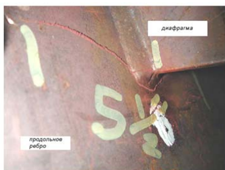
Рис. 14. Трещина усталости в узле пересечения ребер
