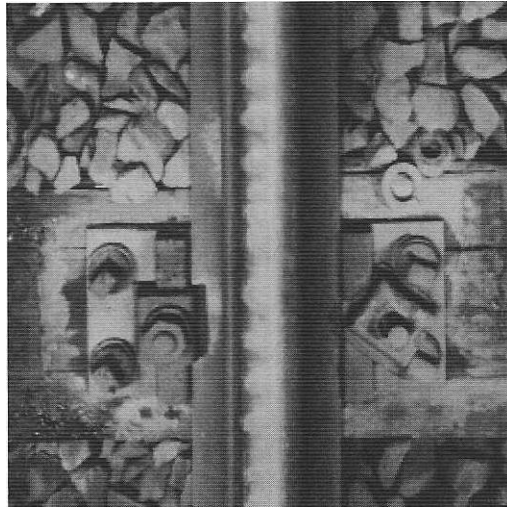
Рисунок 1.8 - Знімок пошкодженої поверхні рейки та скріплення
