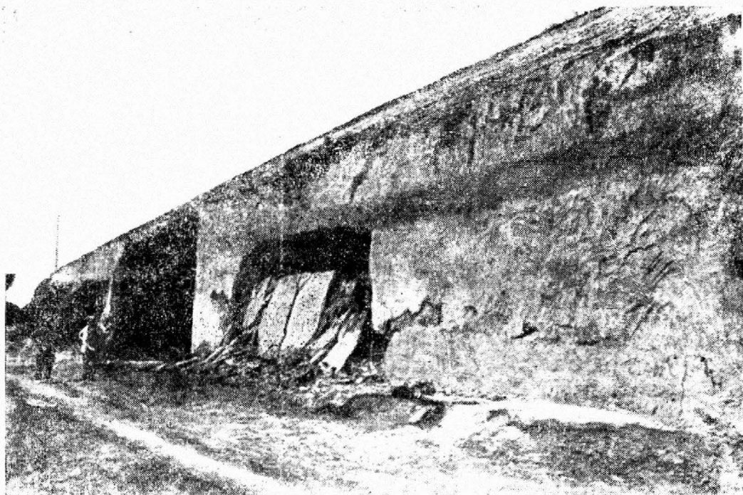
Фиг. 34. Общий вид обвала в откосах лёссовой выемки по линии Канцеровка — Шлюзовая.
