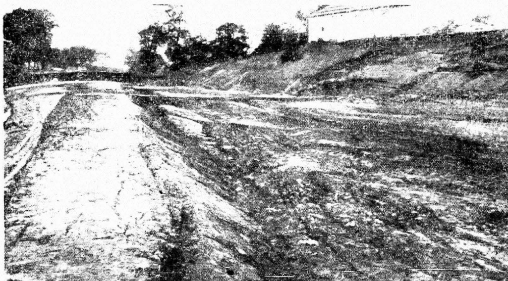
Фиг. 15. Трещина во вновь возведенной насыпи; ветка № 1—2 Витебского узла.
