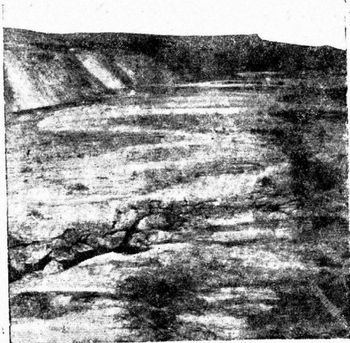
Фиг. 9. Оползневая трещина на станционной площадке.
