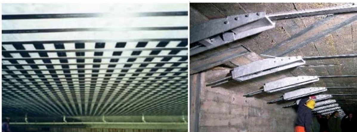
Рисунок 2.5 – Підсилення прогонової будови за допомогою смуг з вуглепластику Sika CarboDur та системи попереднього напружування Sika StressHead
