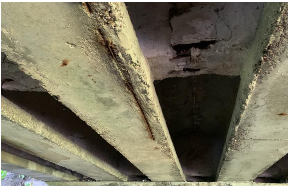
Рисунок 1.9 – Прогонова будова 1-2, балка Б9. Недостатній захисний шар бетону по низу балок, корозія арматури. Корозія закладних виробів до 20% площі перерізу
