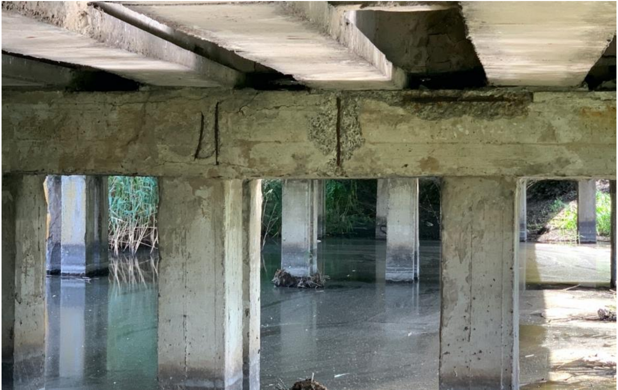
Рисунок 1.11 – Опора 4. Руйнування захисного шару бетону ригеля з оголенням та корозією арматури до 20% площі ригеля, корозія арматури до 15% перерізу
