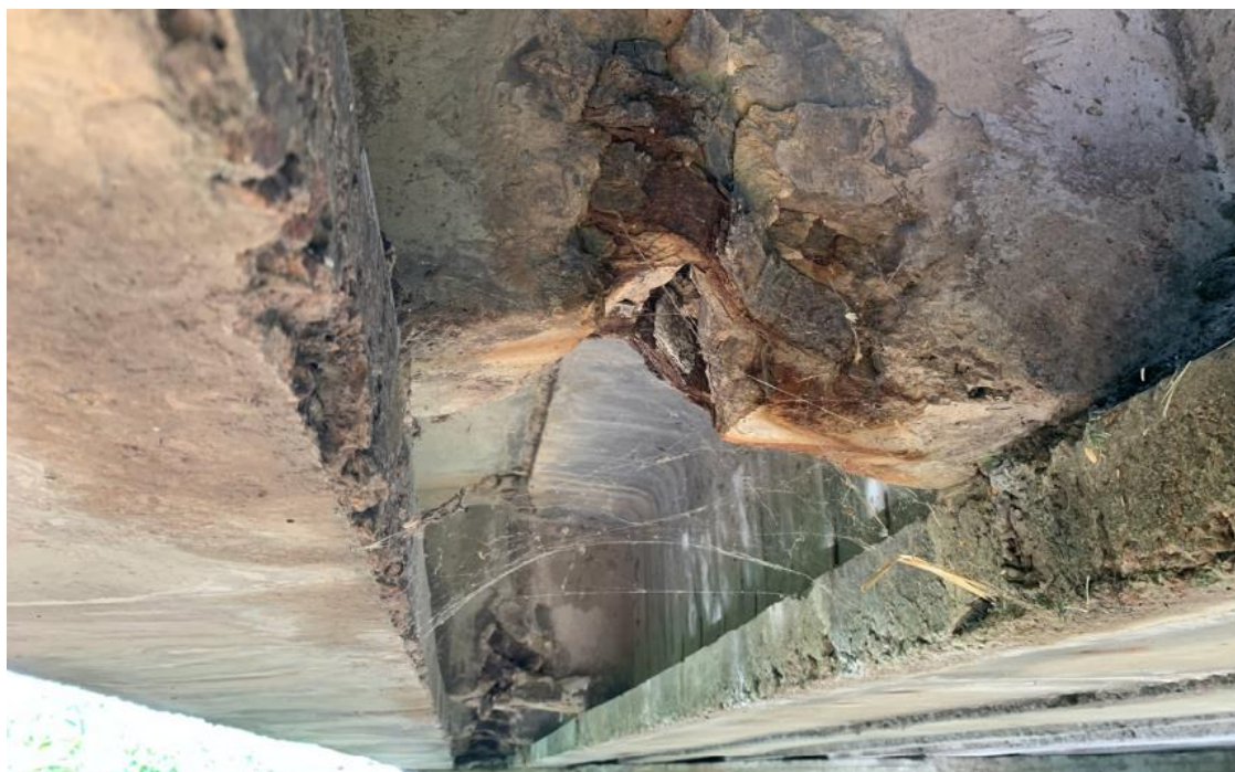
Рисунок 1.10 – Прогонова будова 2-3. Руйнування захисного шару діафрагм з оголенням та корозією закладних виробів до 20% площі перерізу. Раковини в бетоні глибиною до 1см на 15% поверхні балок
