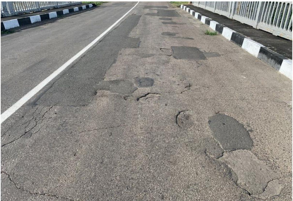
Рисунок 1.12 – Руйнування верхнього шару асфальтобетонного покриття
