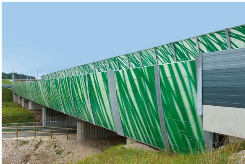
Рисунок 4.5 – Система шумозахисту FONOCON Rail встановлена на залізничному мості [55]
