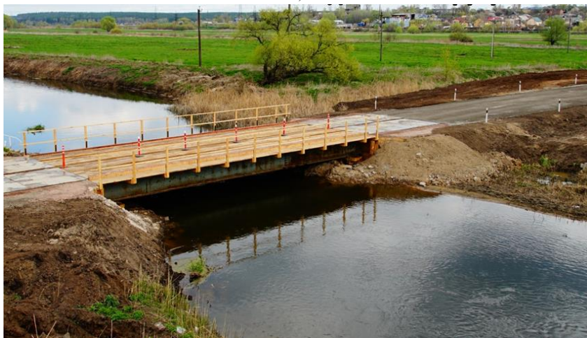
Рисунок 2 – Відновлення автомобільного мостового переходу через р. Ірпінь у смт. Гостомель автомобільної дороги державного значення М-07 Київ-Ковель-Ягодин: а) зруйнований міст; б) відновлений міст
