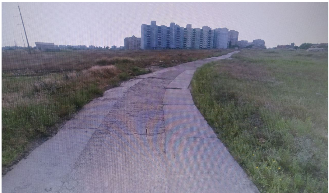
Рисунок 2.2 – Присутні укладені залізобетонні плити вздовж дороги, яка має поперечні тріщини
