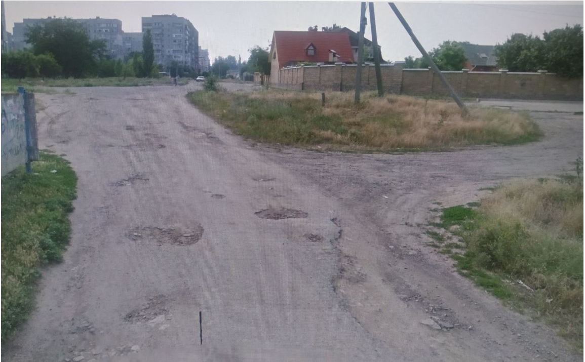
Рисунок 2.5 – Присутня велика кількість вибоїн та зруйнована кромка дорожнього покриття
