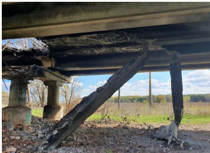
Рисунок 2.4 – Руйнування опори Оп-1 та балок прогонової будови 1-2 в наслідок вибуху
