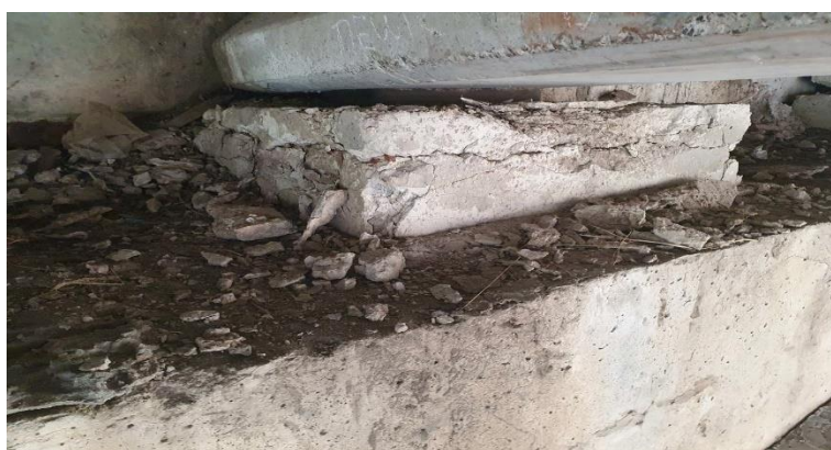
Рисунок 2.9 – Руйнування тіла підферменника на опорі Оп-7 підферменник під балкою Б-4
