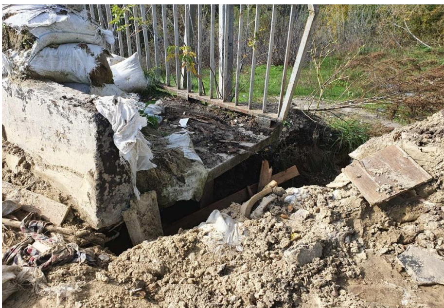
Рисунок 2.10 – Відсутнє сполучення тротуару з підходом з верхового боку мосту на опорі Оп-0
