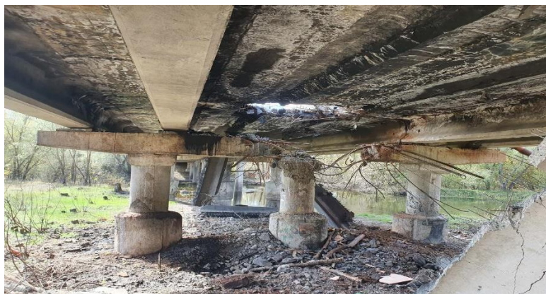
Рисунок 2.3 – Руйнування опори Оп-1 та балок прогонової будови 0-1 в наслідок вибуху.
