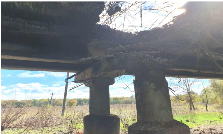
Рисунок 2.6 – Руйнування опори Оп-1 в наслідок вибуху.
