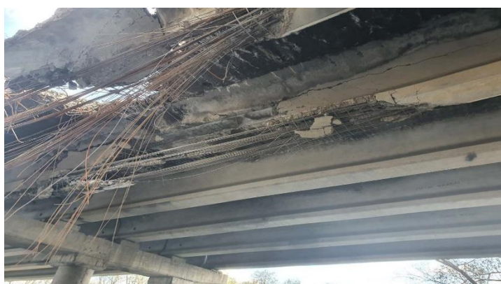
Рисунок 2.5 – Руйнування опори Оп-1 та балок прогонової будови 1-2 в наслідок вибуху
