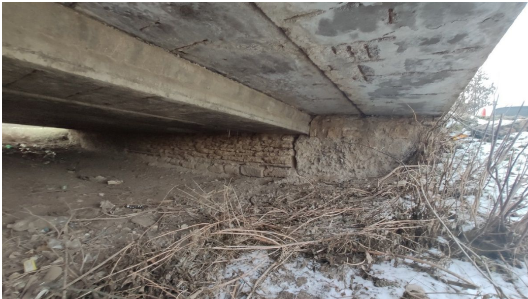
Рисунок 2.4 – Вивітрювання швів кладки кам'яних опор
