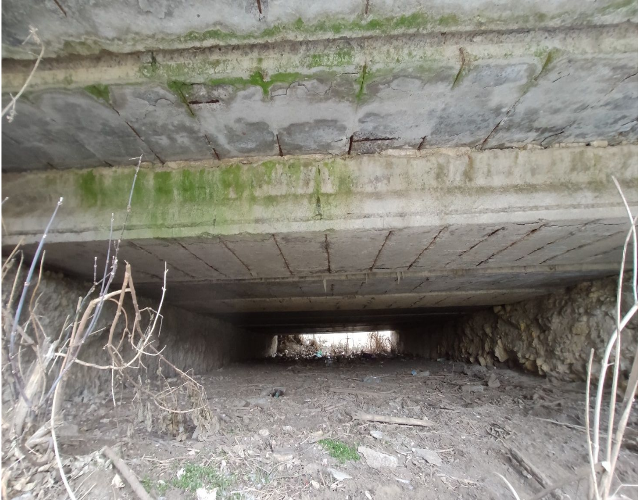
Рисунок 2.1 – Замокання та пліснява на зовнішній поверхні прогоновій будові. Прогонова будова 0-1.
