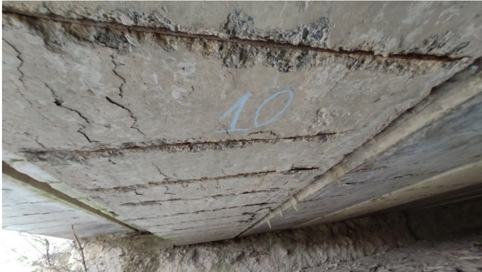
Рисунок 2.2 – Руйнування захисного шару бетону з оголенням поперечної арматури.
