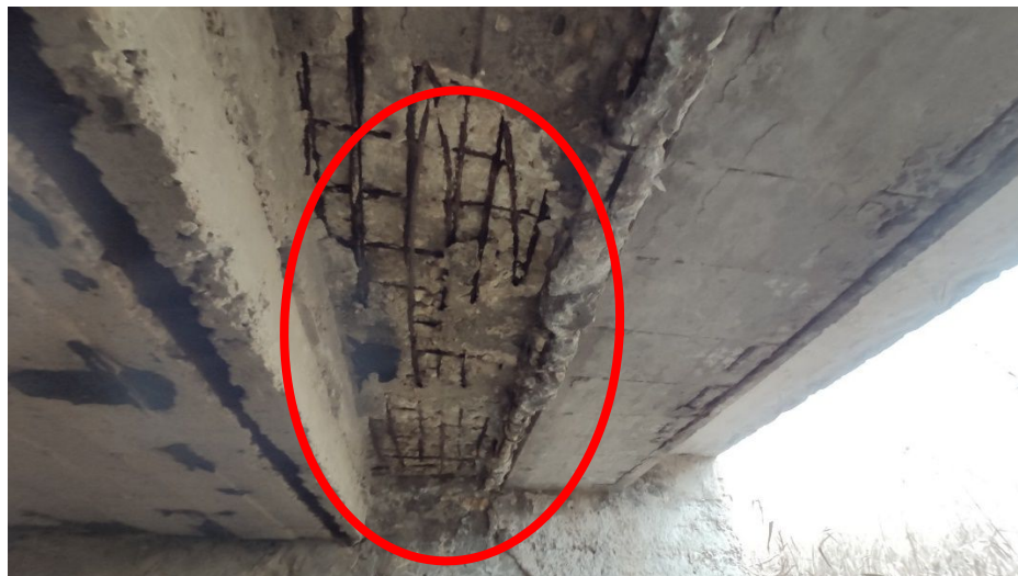
Рисунок 2.3 – Сколювання бетону внаслідок корозії робочої та конструктивної арматури, корозія до 15% перерізу.
