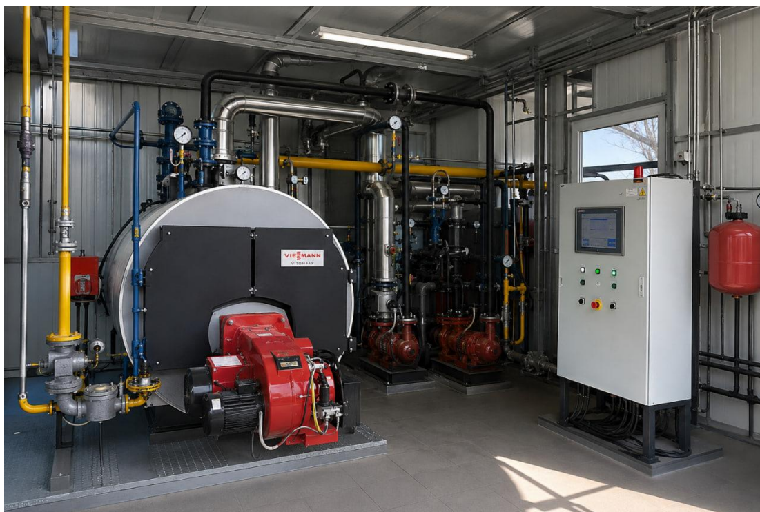
Рисунок 3.5 - Установка є газовою котельнею, призначеною для виробництва теплової енергії та подачі теплоносія до системи опалення або гарячого водопостачання.
