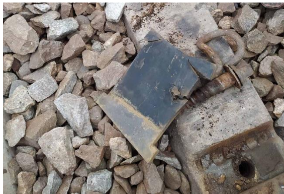
Фото 3.1. Надрив підрейкових прокладок типу Zw SL-900-2 з жорсткістю 60 кН/мм.
