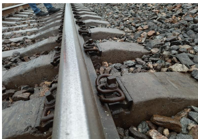
Фото 3.3 - Клеми типу Sk1 SL-1 не притиснуті до кутової направляючої плити, відстань між прутком клеми та кутовою направляючою досягає 3мм (при перевірці зусилля затяжки динамометричним ключем крутний момент відповідає нормі та складає не менше ніж 300 Н·м.).
