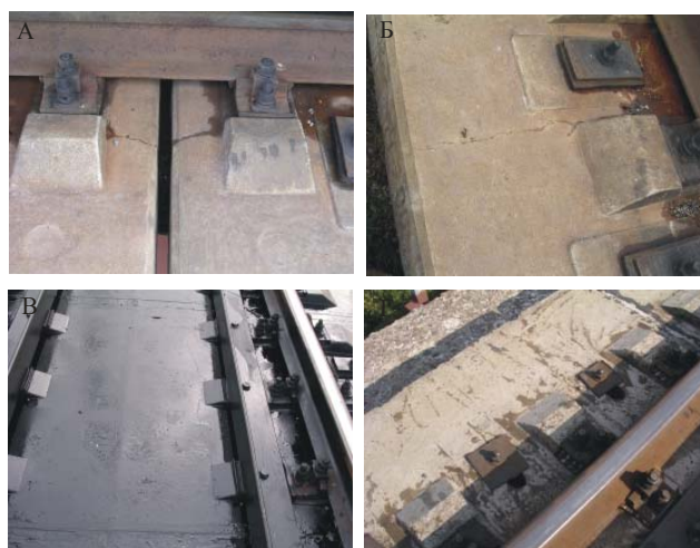
Рис. 4. Характерные нарушения эксплуатации плит безбалластного мостового полотна: а) продольные трещины по подрельсовой площадке; б) поперечные трещины около подрельсовых площадок; в) продольные трещины в зоне крепления контруголков; г) открытые шпилечные отверстия
