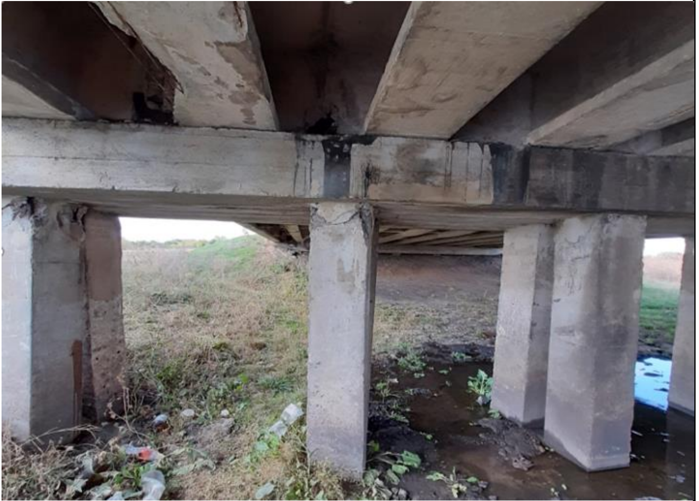
Рисунок 2.10 – Руйнування бетону палів П6 і П7 другого ряду з боку опори Оп. 2 в місці їх об'єднання із ригелем
