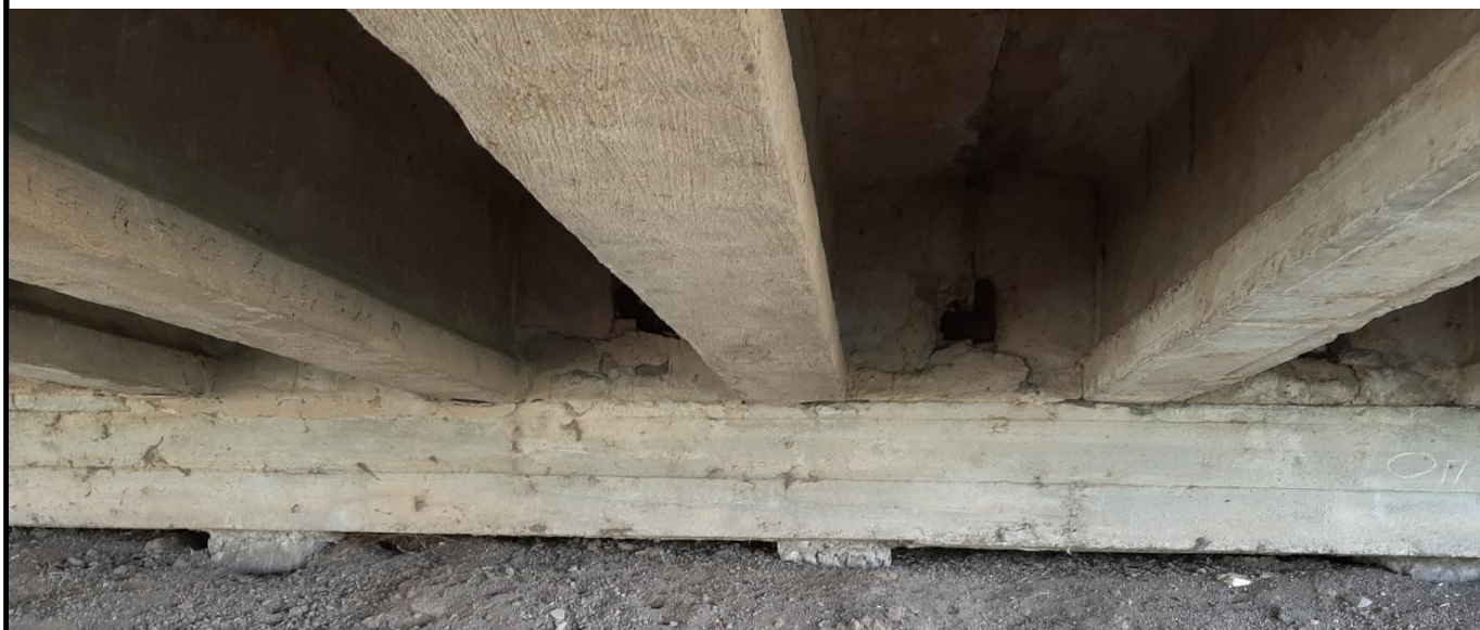
Рисунок 2.8 – Залишки бетонного розчину висотою до 50 см на поверхні ригеля між балками прогонової будови 0-1
