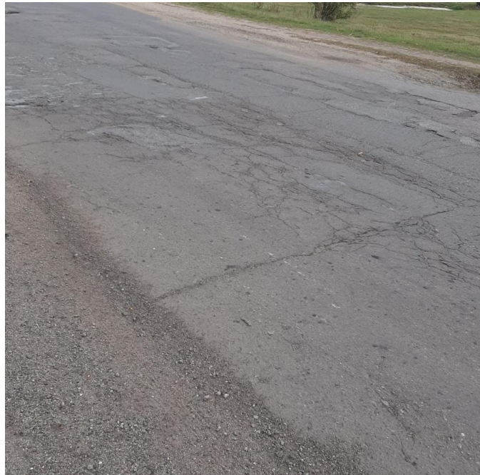
Рисунок 2.16 – Сітка хаотичних тріщин у асфальтобетонному покритті на підходах до мосту з боку с. Аджамка.
