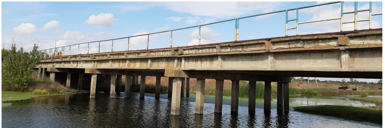
Рисунок 2.15 – Відсутнє заповнення поручневої огорожі лівого і правого тротуарів прогонових будов 1-2, 2-3 і 3-4.
