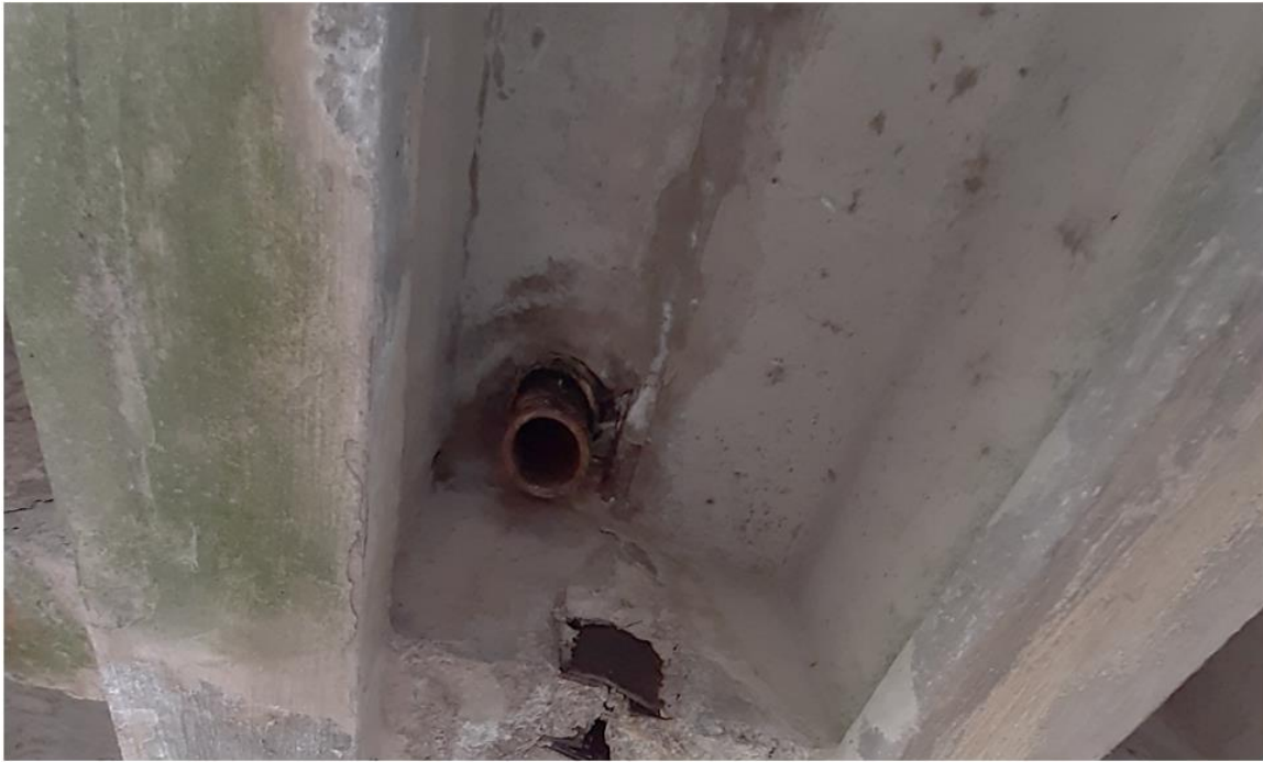
Рисунок 2.6 – Іржава водовідна трубка, замокання бетону навколо трубки і руйнування захисного шару бетону навколо трубки між балками Б9 і Б10 ближче до діафрагми Д4 прогонової будови 0-1.
