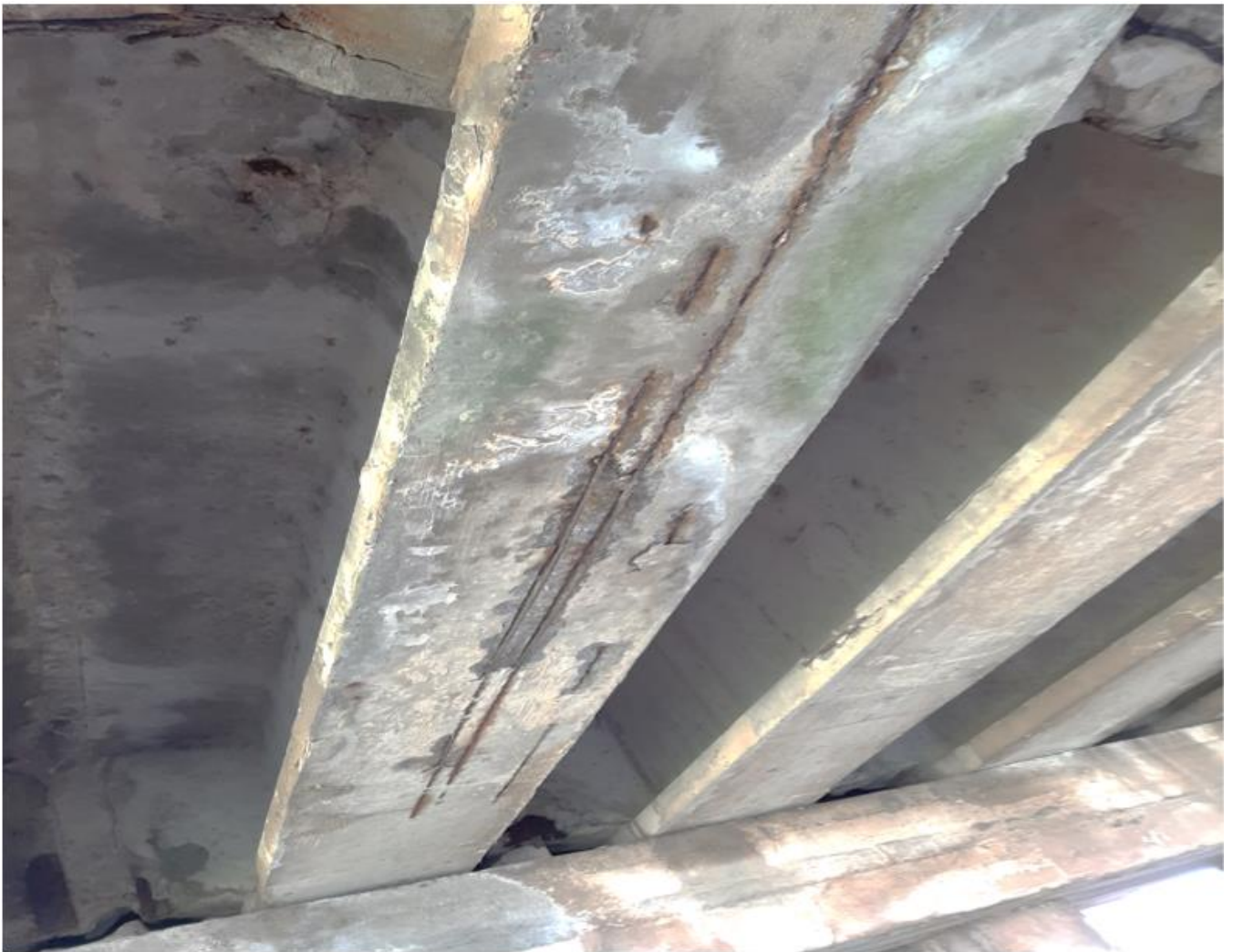
Рисунок 2.5 – Руйнування захисного шару бетону, оголення, корозія і провисання поздовжньої попередньо напруженої арматури понизу ребра балки Б2 прогонової будови 3-4.
