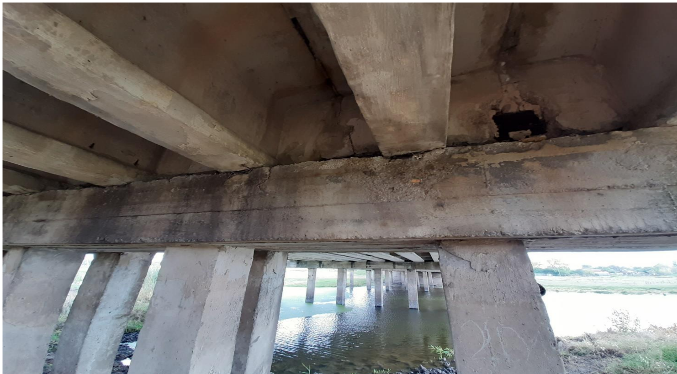
Рисунок 2.9 – Руйнування бетону ригеля опори № 1 в місці обпирання усіх балок прогонової будови 0-1.
