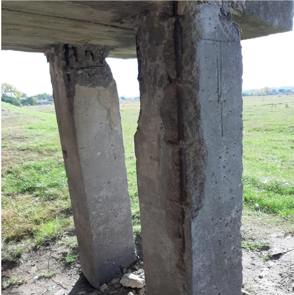
Рисунок 2.12 – Зруйнований бетон з оголенням і корозією арматури паль в сьомому ряду на опорі № 4
