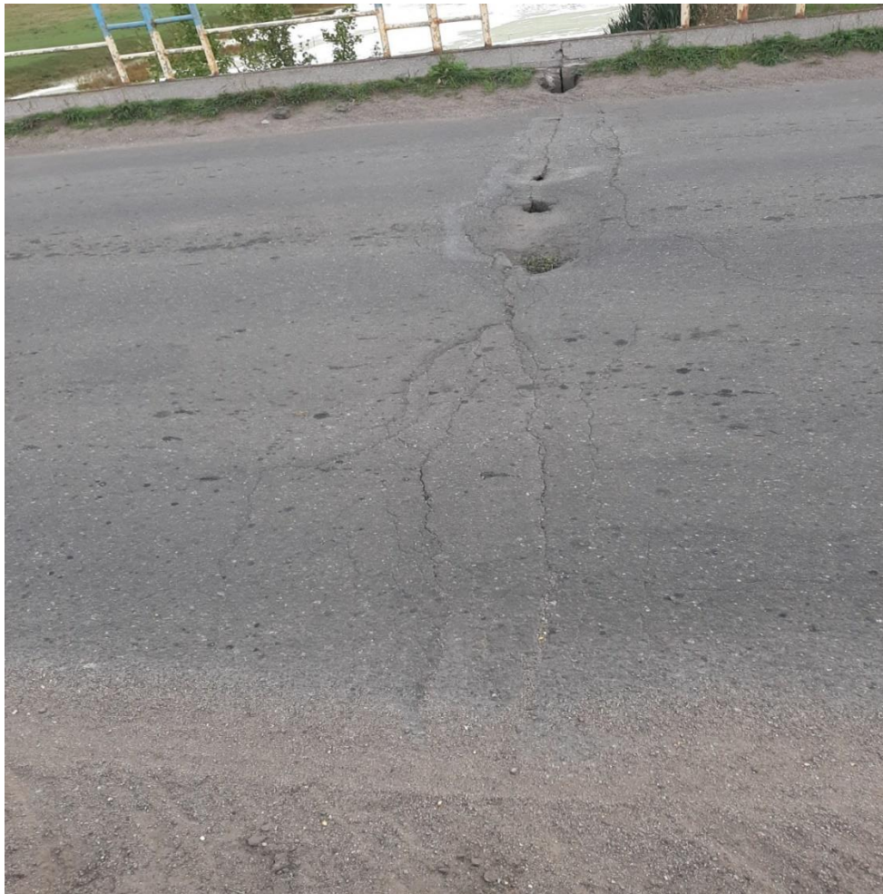
Рисунок 2.13 – Поперечні тріщини, вибоїни і ями у асфальтобетонному покритті проїзної частини у місці встановлення деформаційного шва між прогоновими будовами 0-1 і 1-2.
