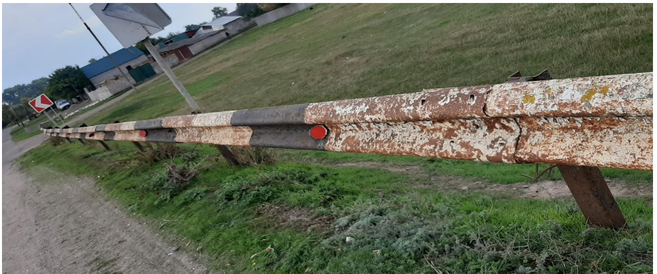
2.17 Лущення фарби, відсутні болти в з'єднаннях секцій, корозія усіх елементів бар'єрної огорожі праворуч проїзної частини на підході з боку с. Аджамка
