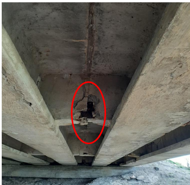
Рисунок 2.1 – Корозія закладних деталей в об'єднаннях діафрагм між балками прогонової будови 4-5.
