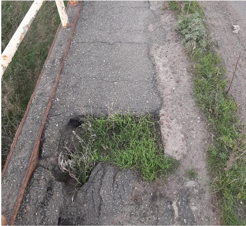
Рисунок 2.14 – Пролом в тротуарній плиті прогонової будови 0-1 праворуч проїзної частини.
