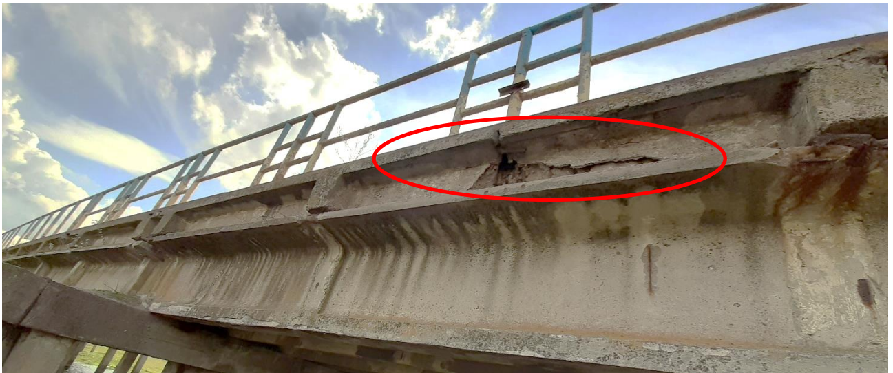
Рисунок 2.2 – Руйнування секції поздовжньої балки тротуарної консолі з верхової сторони мосту. Прогонова будова 0-1
