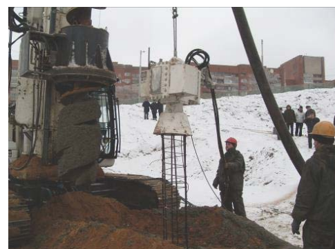
Рис. 24. Оборудование для устройства свай SFA: а) – буровой станок со сплошным полым шнеком; б) – комплект оборудования при устройстве свай; в) – подъем шнека с бетоном на лопастях и погружение каркаса в скважину вибратором
