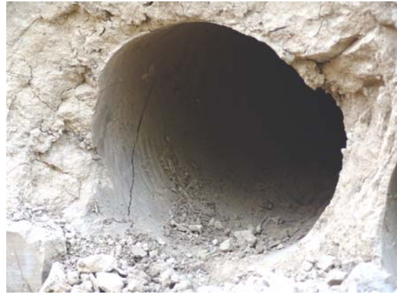
Рис. 6. Характер деформирования контура скважины после ее бурения
