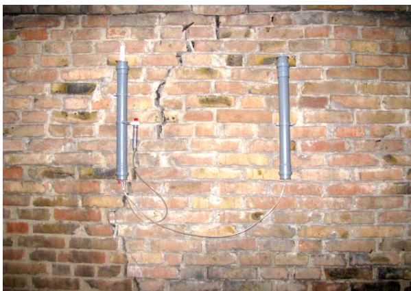
Рис. 10, б. Контроль осадок устройством, состоящим из двух индуктивных датчиков с магнитопроводом, закрепленным на поплавке
