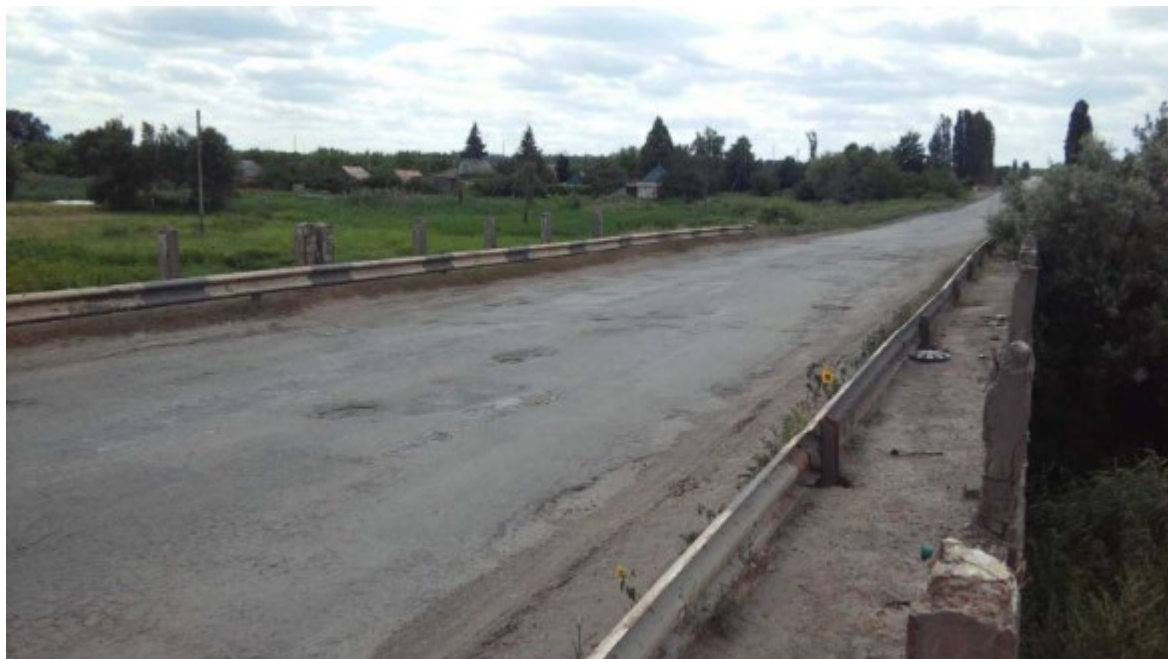
Фото 2.9. Вид на мостове полотно. Перильна огорожа зруйнована.
